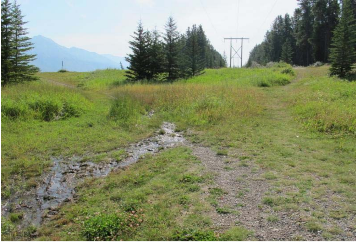
Photo 9 : Barrage ouest – Suintement
