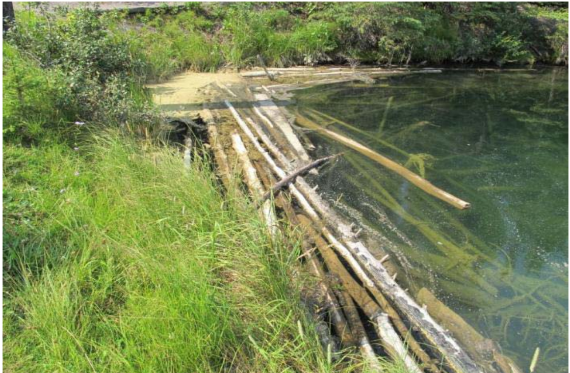
Photo 16 : Barrage est – Débris accumulés à l'extrémité ouest du barrage
