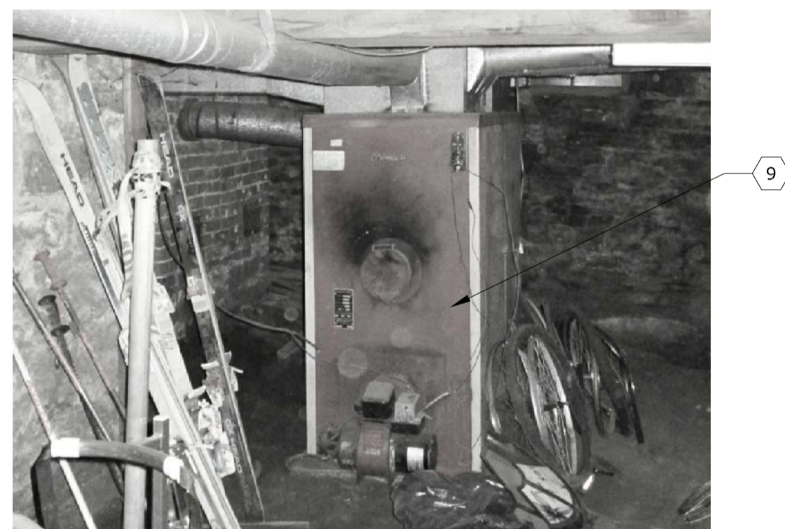
⑥ Fournaise existante / Existing furnace A-07 N.A.
