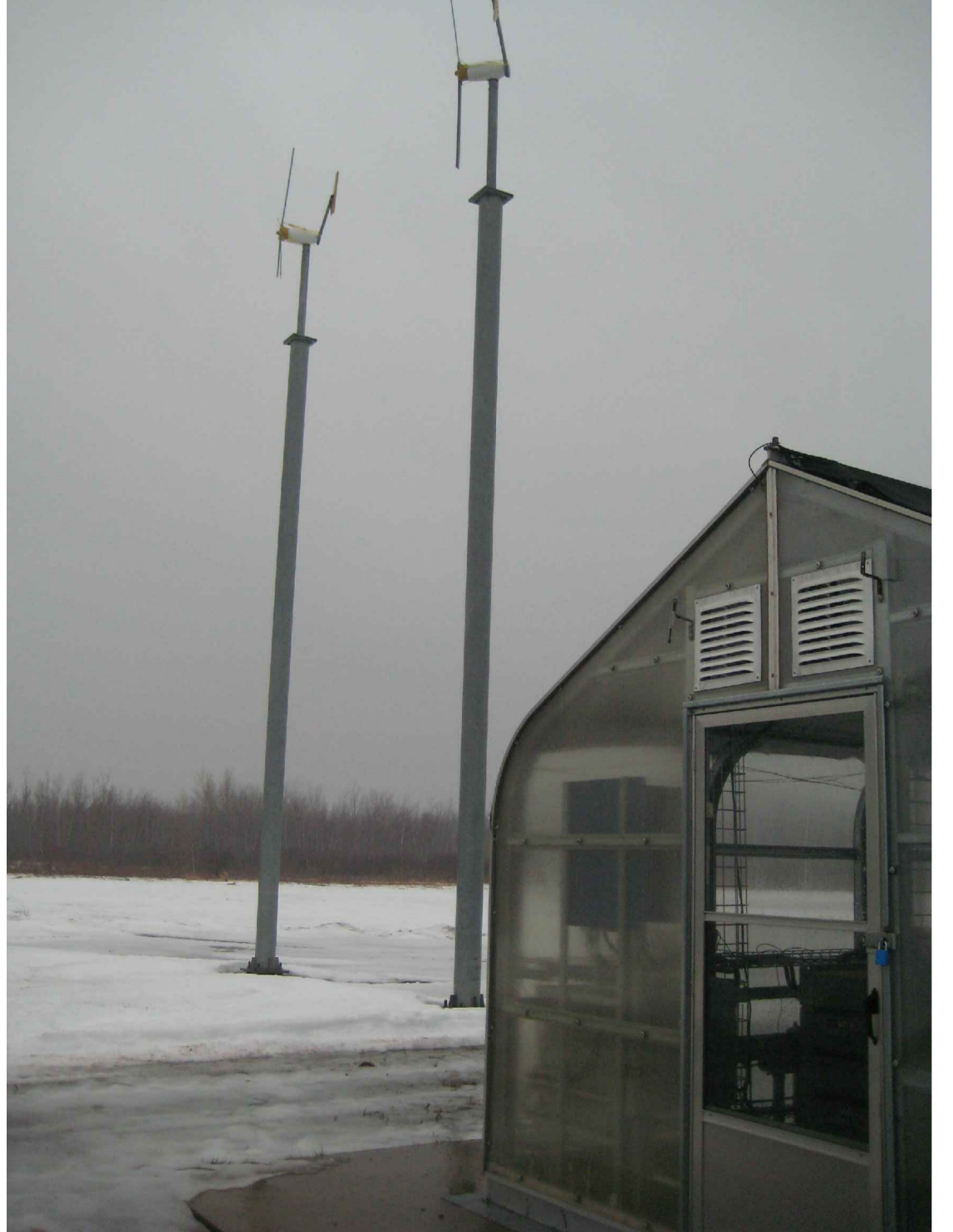
A ÉOLIENNES WIND TURBINE
