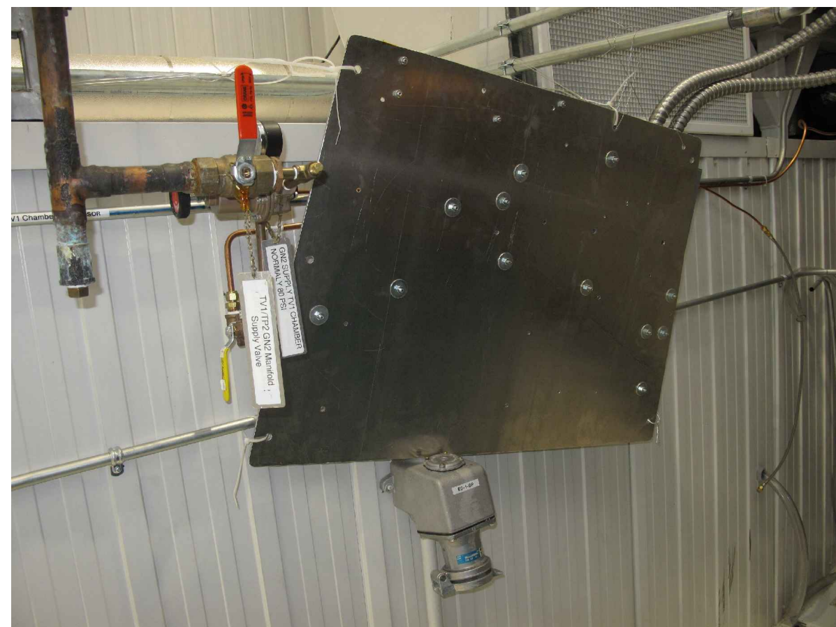
VIEUX TABLEAU ÉLECTRIQUE DE TV1 VUE 6 E1
