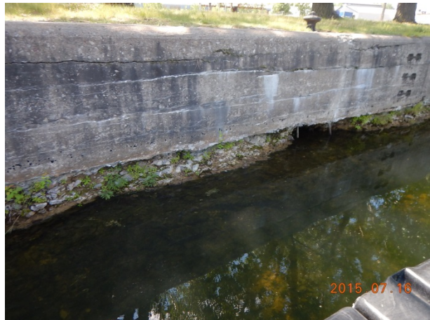
Photo 16 - Vue typique des dommages à réparer
