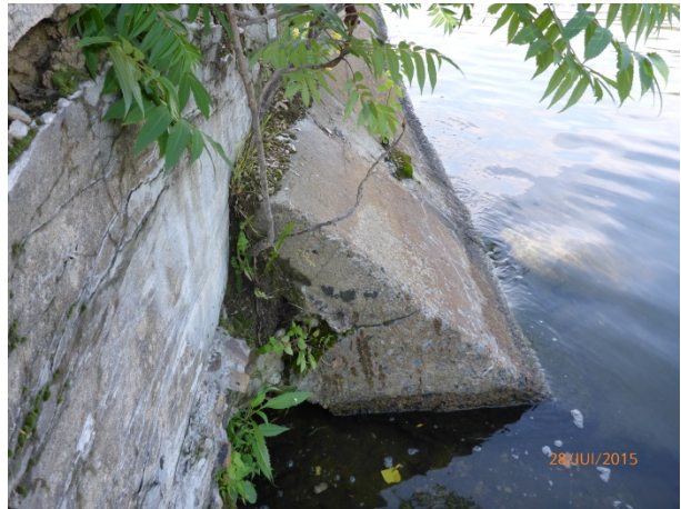
Photo 02- Réparations existantes typiques
