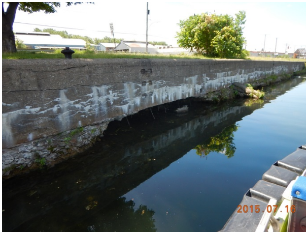
PHOTO 15 - Vue typique des dommages à réparer
