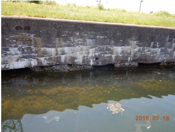
PHOTO 13 - Vue typique des dommages à réparer
