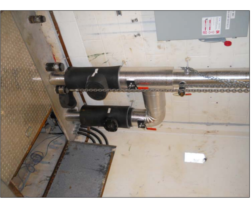
2 PUISARD E4 PHOTO M101 SCALE / ÉCHELLE: AUCUNE
