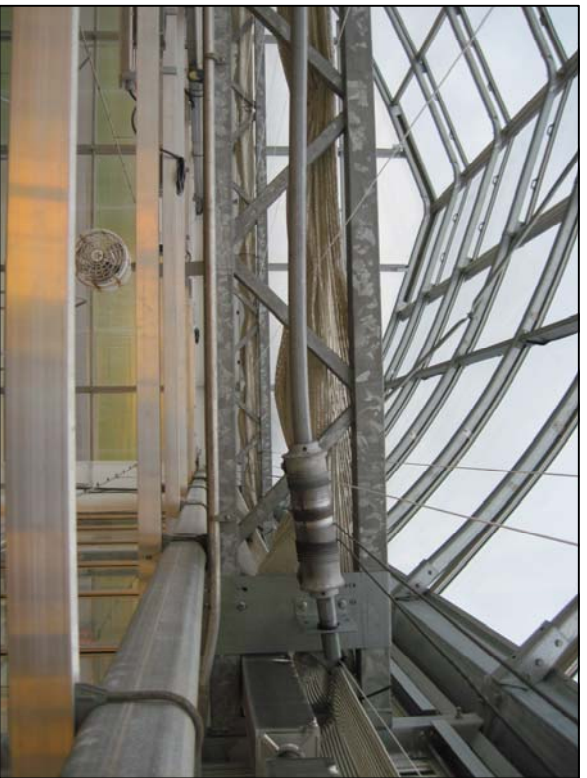
VUE DE L'ARBRE D'ENTRAÎNEMENT ENDOMMAGÉ DANS LA SERRE A-2
