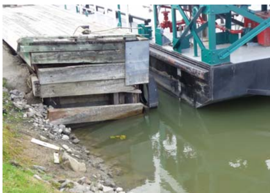
Figure 1 Détérioration observée au Quai A
