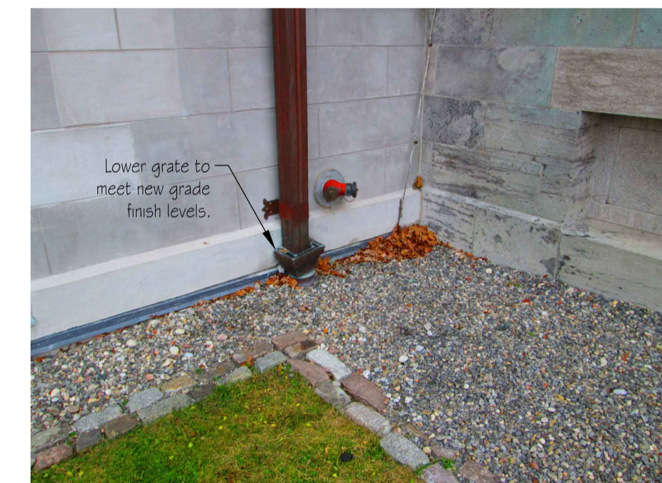
DS03 Photo of Existing Downspout Grate Photo de la grille de la descente pluviale existante Scale / échelle : NTS
