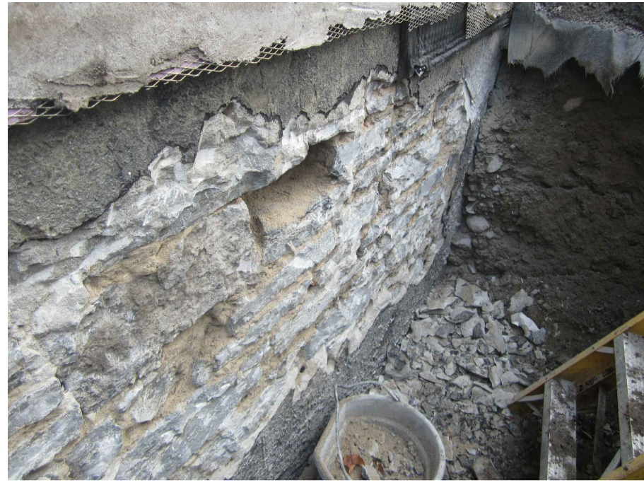
04 Photo of Foundation Wall After Parging Removal Photo du mur de fondation après l'enlèvement du crépi Scale / échelle : NTS
