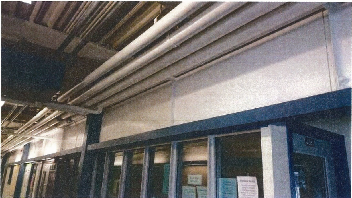
No drywall in Hallway 216.
