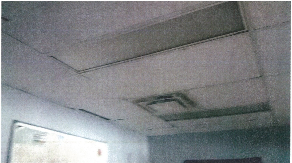
Ceiling tiles (Room 238).
