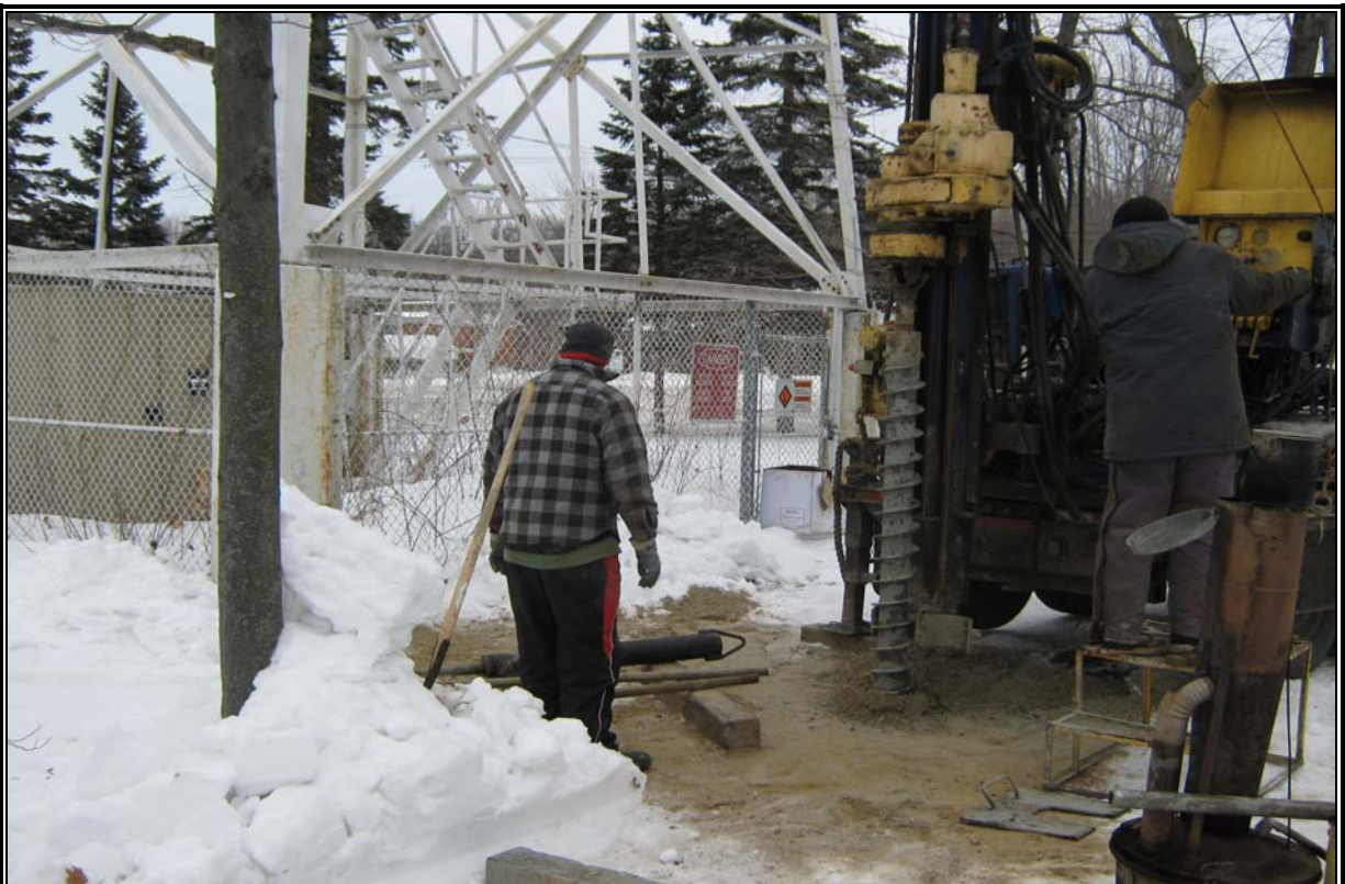
Photographie no 4 : Foreuse en opération au forage F-01. Vue vers le nord.
