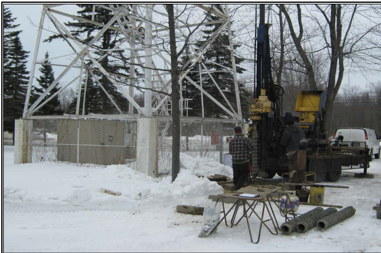
Photographie no 5 : Foreuse en opération au forage F-01. Vue vers le nord.
