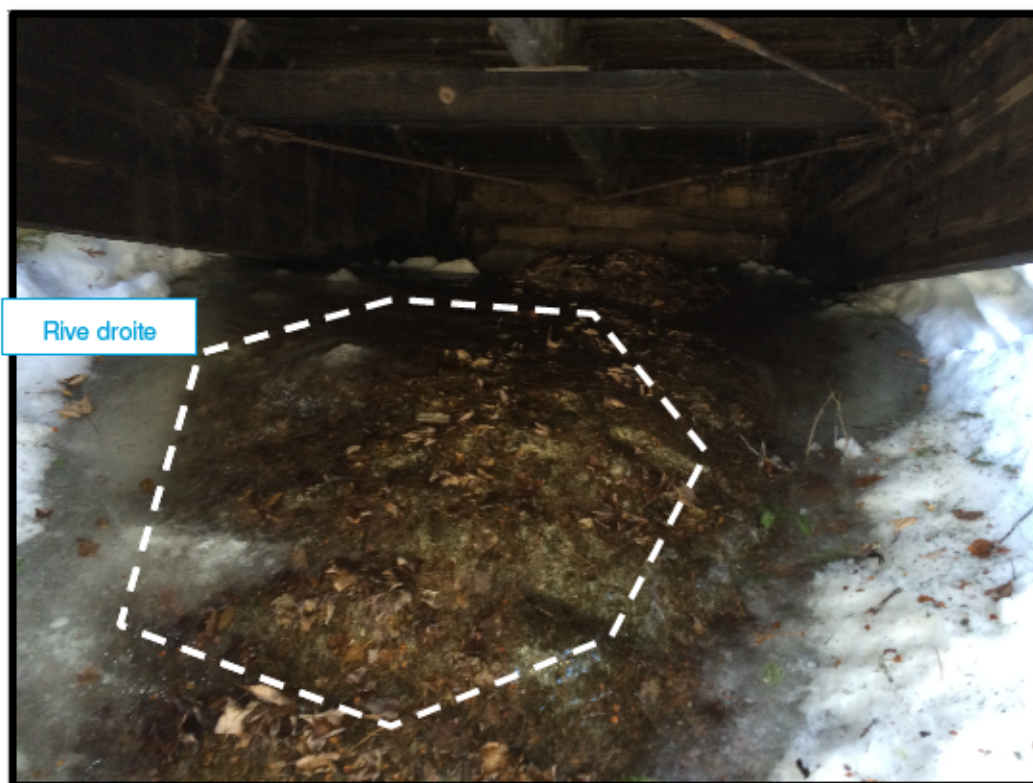
Figure 4 : Surface dure observée, sous la passerelle, en rive droite.
