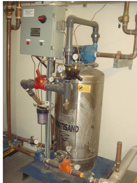
Figure 14 : Système de filtration Vortisand (N° de série MR431, de secours) dans la chambre mécanique M1
