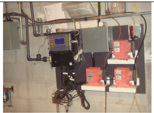
Figure 12 : Station de traitement chimique dans la salle mécanique M-4
