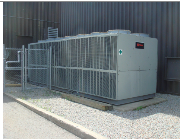
Figure 10 : Installation de refroidissement, refroidisseur à air RTAA de 200 tonnes
