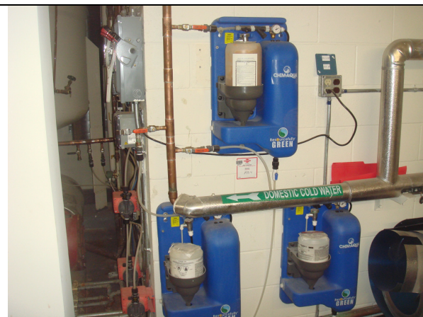
Figure 11 : Station de traitement chimique dans la salle mécanique M-1
