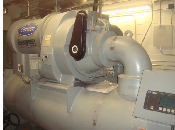
Figure 8 : Installation de refroidissement, refroidisseur Carrier de 300 tonnes dans la salle mécanique M-1
