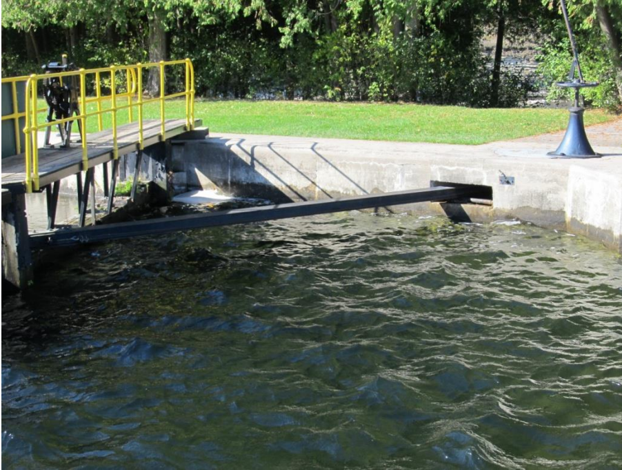
Écluse 23 (P1) (Mécanisme de Poste de contrôle SO)
