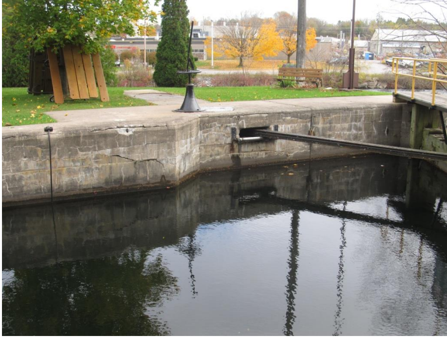
(P7) Écluse 26- Mécanisme de Poste de contrôle et Bar de Rouleau pour écluse de SE
