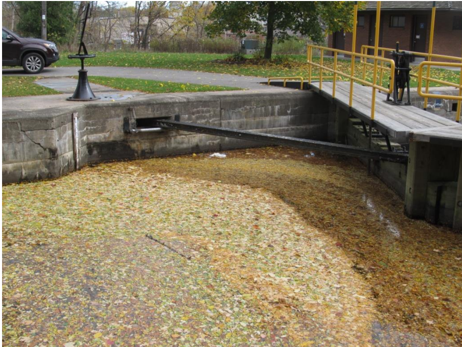
(P8) Écluse 26- Mécanisme de Poste de contrôle et Bar de Rouleau pour écluse de NE
