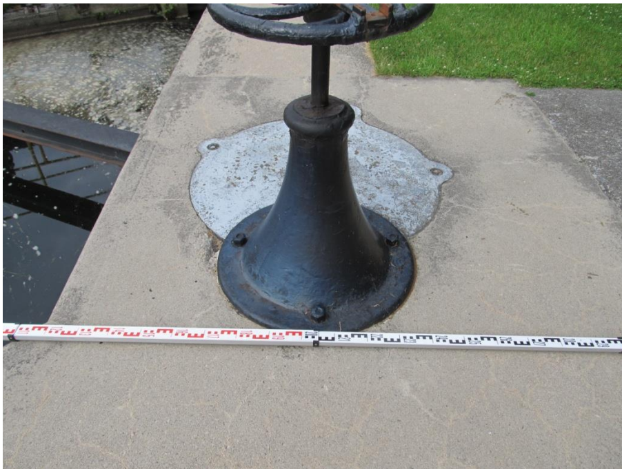
Écluse 23 (P2) (Mécanisme de Poste de contrôle SO)
