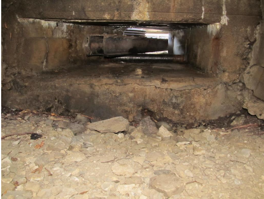
Écluse 23 (P5) (Mécanisme de Poste de contrôle SO) La photo de l'intérieur du bras de porte poursuit la Photo prise du côté ouest de mécanisme de contrôle regardant vers l'écluse (à l'est).
