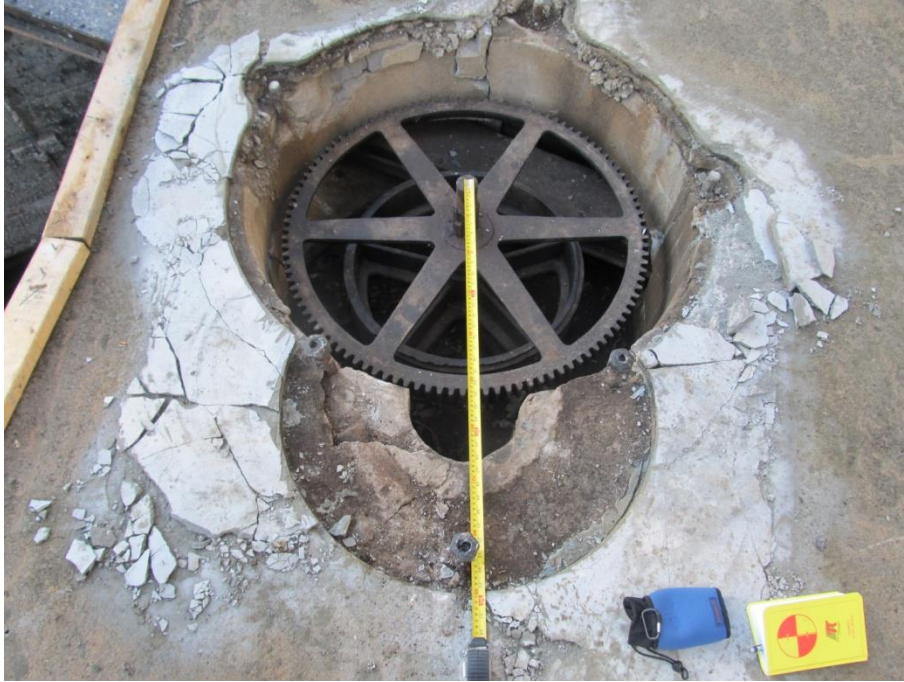
Écluse 23 (P3) (Mécanisme de Poste de contrôle SW) Couverture enlevée de manivelle
