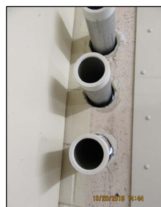
(PHOTO 2) CONDUITS (CER ROOM) SCALE NTS
