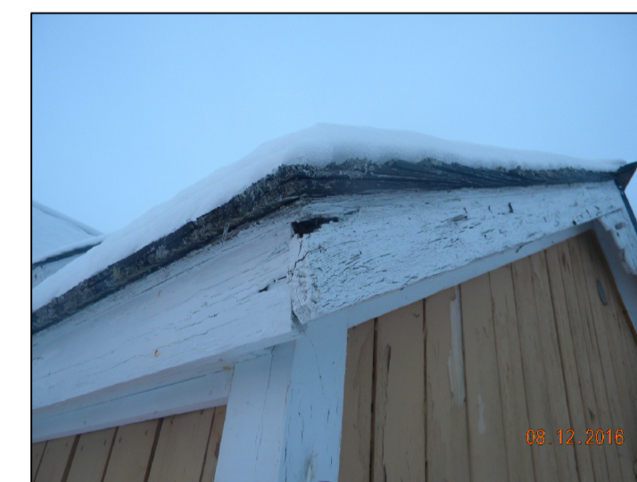
PHOTO 5 - PIANCHE DE FASCIA À REMPLACER.
