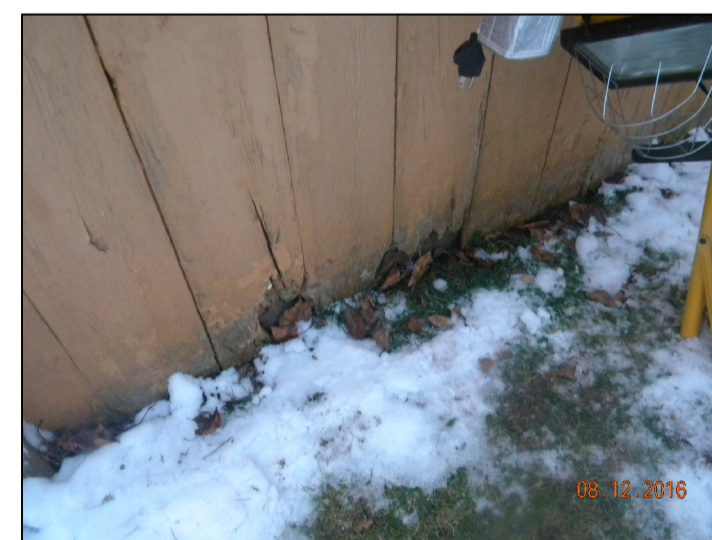
PHOTO 3 - BOIS EN CONTACT AVEC LE SOL
