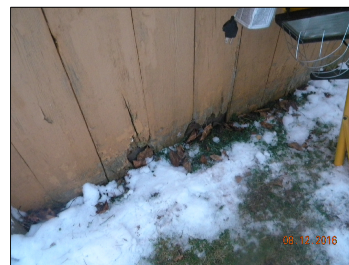
PHOTO 3 - PLANCHES VERTICALES DE PAREMENT ENDOMMAGÉES LÀ OÙ EN CONTACT AVEC LE SOL.
