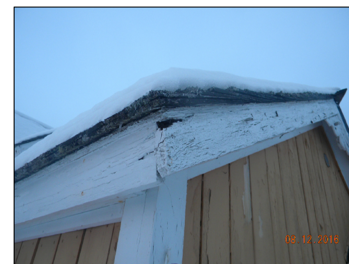
PHOTO 5 - BOIS EN CONTACT AVEC LE SOL
