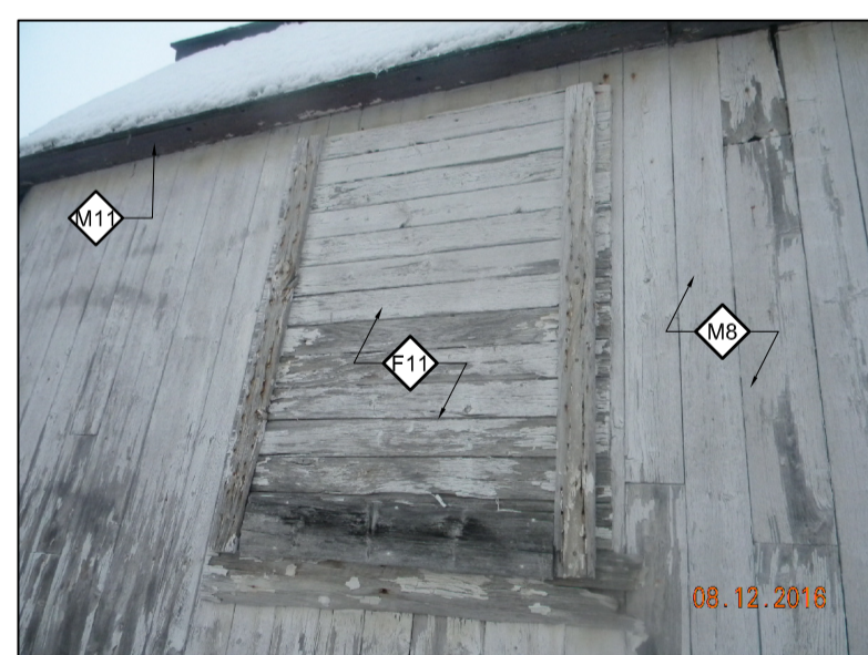
PHOTO 5 - REVÊTEMENT EN PLANCHES HORIZONTALES À RÉINSTALLER APRÈS LES TRAVAUX.
