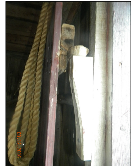
PHOTO NO.2: CHARNIÈRE PORTE HANGAR À POISSON
