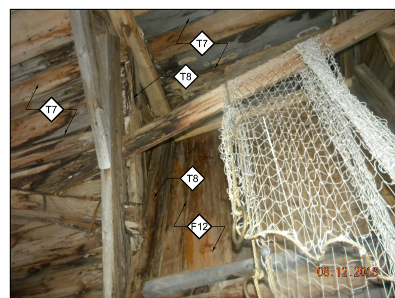
PHOTO 4 - PLANCHE DE SUPPORT DE TOITURE À REMPLACER AU POURTOUR DE LA LUCARNE
