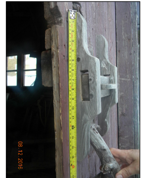
PHOTO NO.1: POIGNÉE ET SYSTÈME DE BARRURE À COULISSE PORTE HANGAR À POISSON
