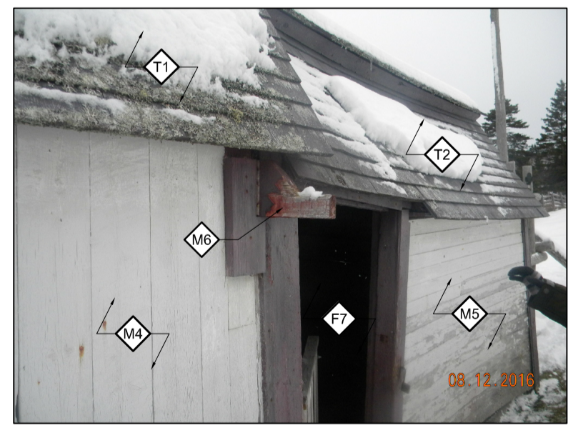
PHOTO 3 - SUPPORT DE GOUTIÈRE À REMPLACER
