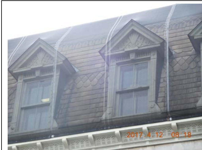
Photo 5 : Vue générale mansarde Travaux de solinage en cuivre, remplacement de l'ardoise et peinture.
