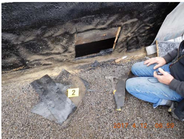
Photo 19 : Parapet- mansarde du bassin 01, coupe exploratoire
