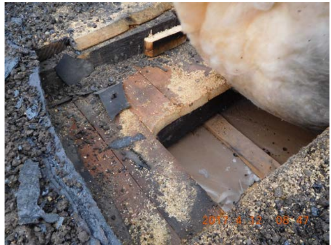
Photo 18 : Bassin 01, coupe exploratoire Composition du toit
