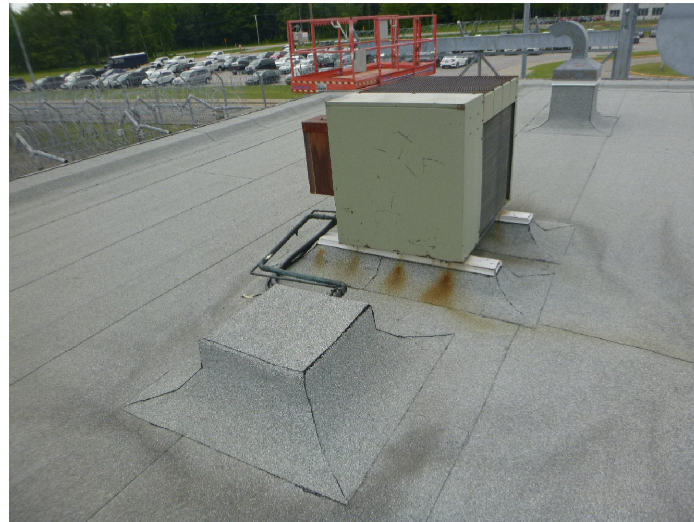
03 PHOTO - MÉCANIQUE AU TOIT ECHELLE: AUCUNE
