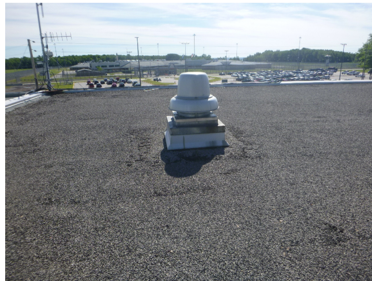
06 PHOTO - BASE MÉCANIQUE EXISTANTE ÉCHELLE: AUCUNE
