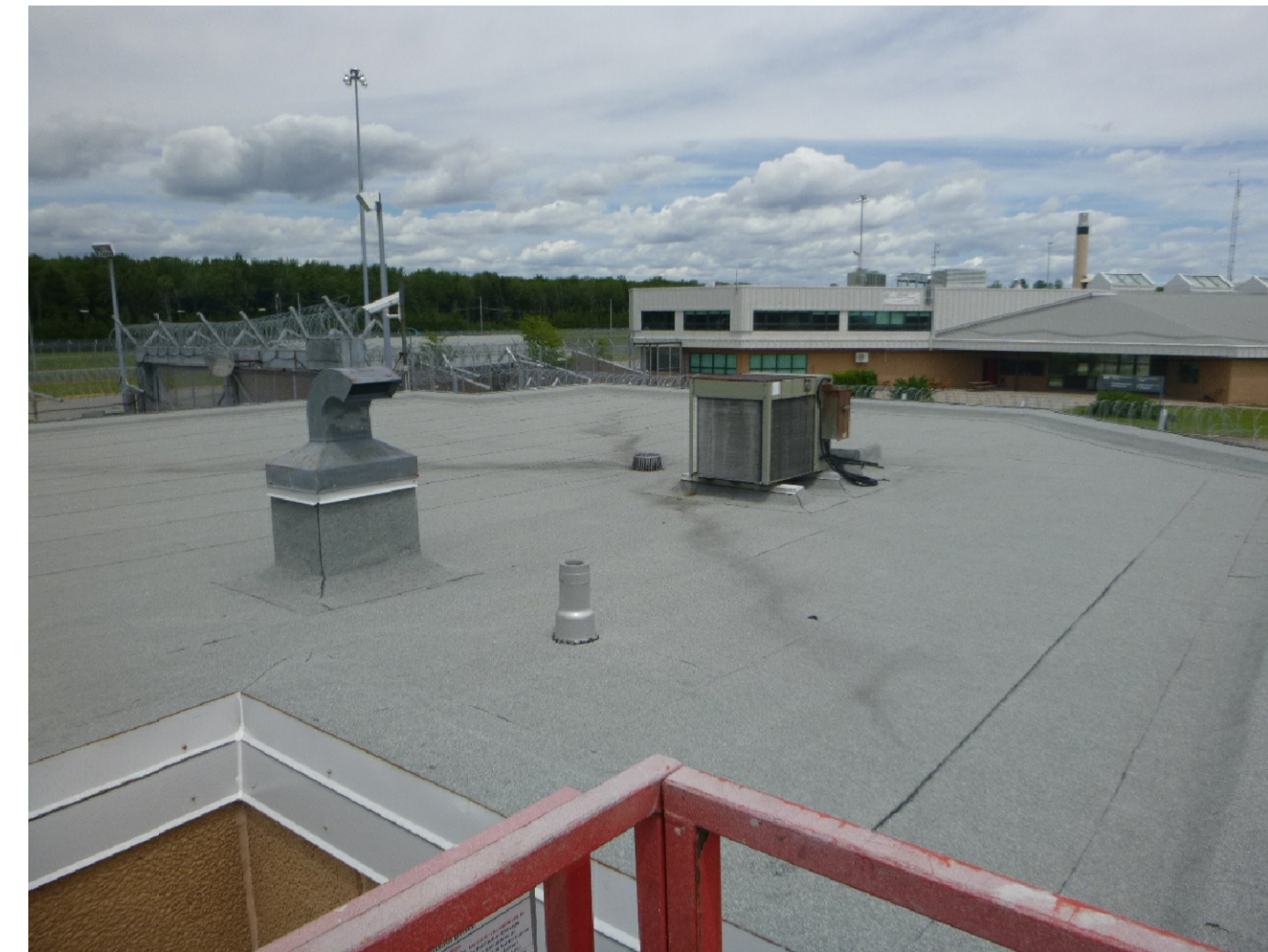
04 PHOTO - MÉCANIQUE AU TOIT ECHELLE: AUCUNE
