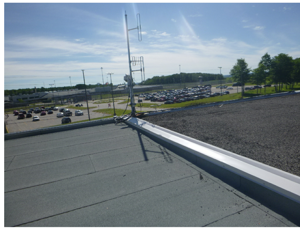
03 PHOTO - MÂT ÉLECTRIQUE EXISTANT ÉCHELLE: AUCUNE
