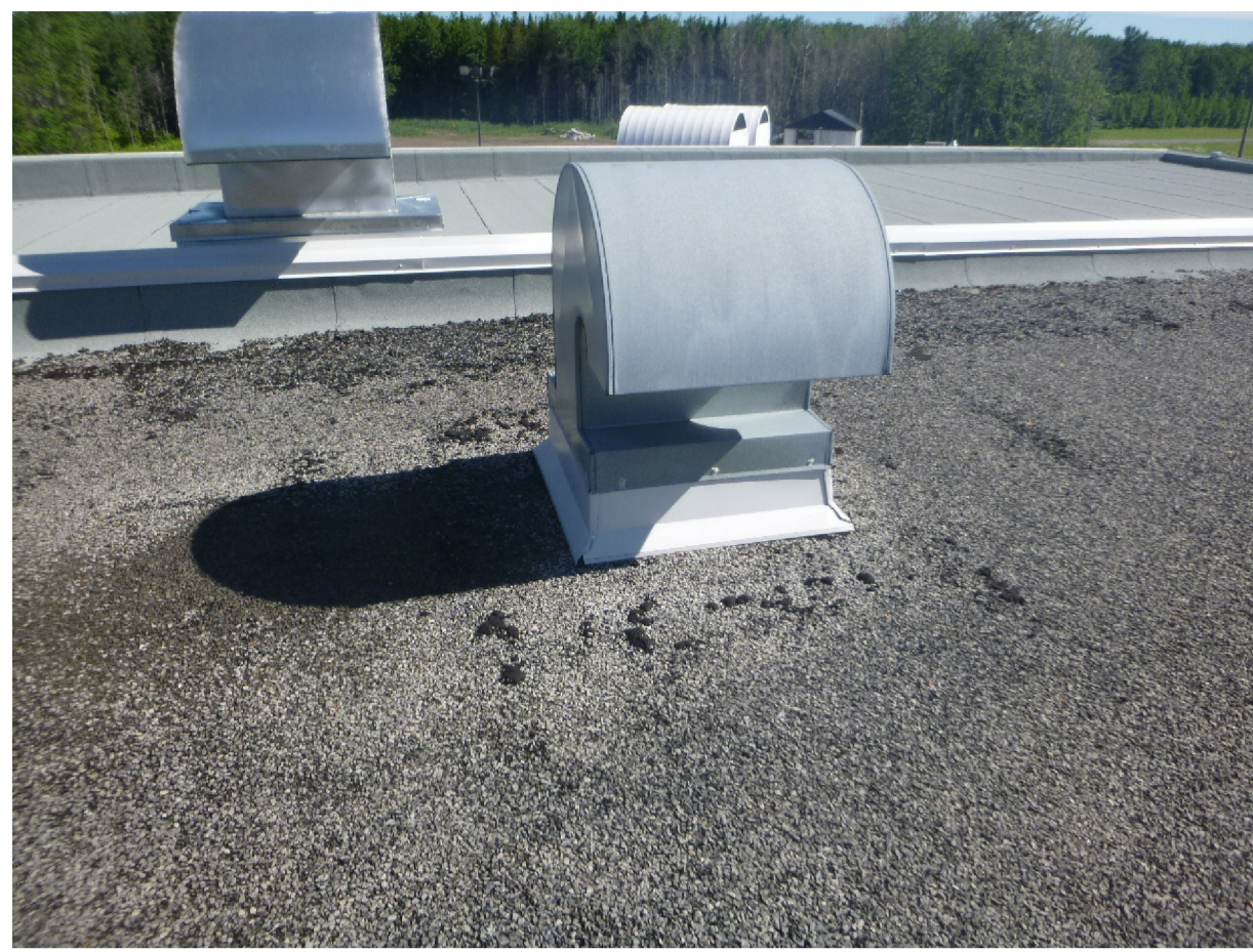
02 PHOTO - COL DE CYGNE EXISTANT ÉCHELLE: AUCUNE
