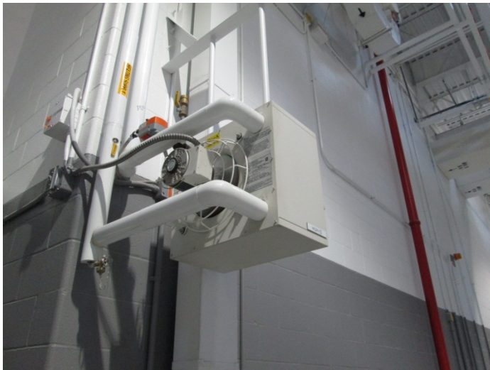
Fig. 31: Horizontal Unit Heater
