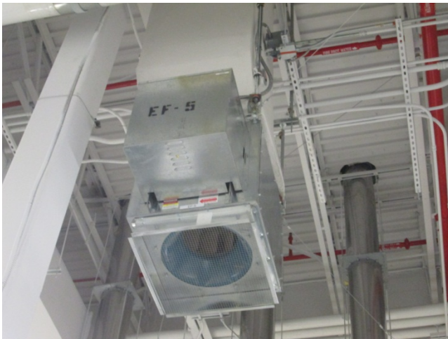
Fig. 18: EF-5 Mechanical Room Ventilation Fan
