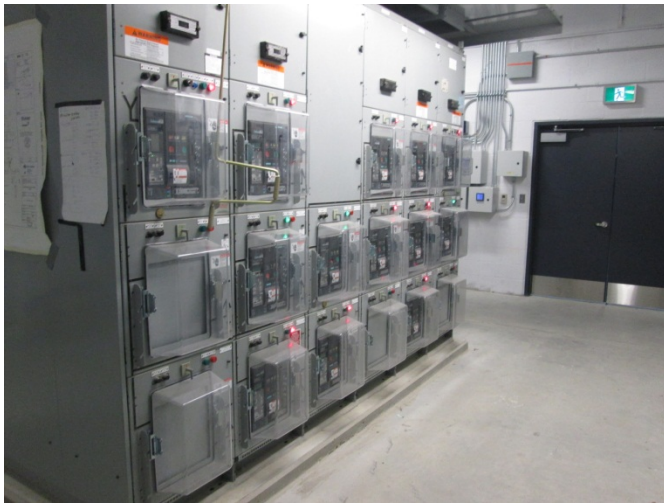
Fig. 40: Low Voltage Switchgear
