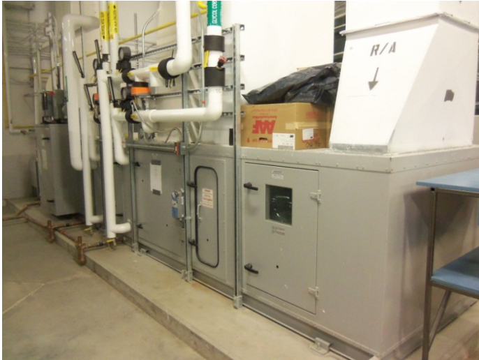
Fig. 26: Air Handling Unit 1
