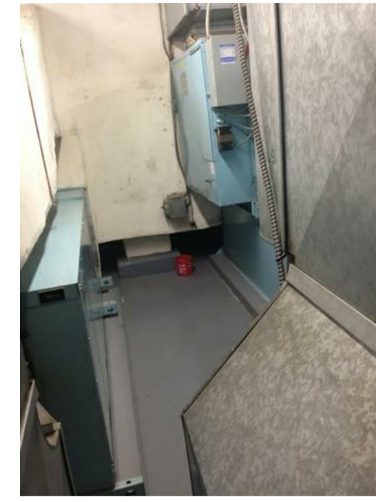
ROOM 102 - FAN ROOM PHOTO 221
