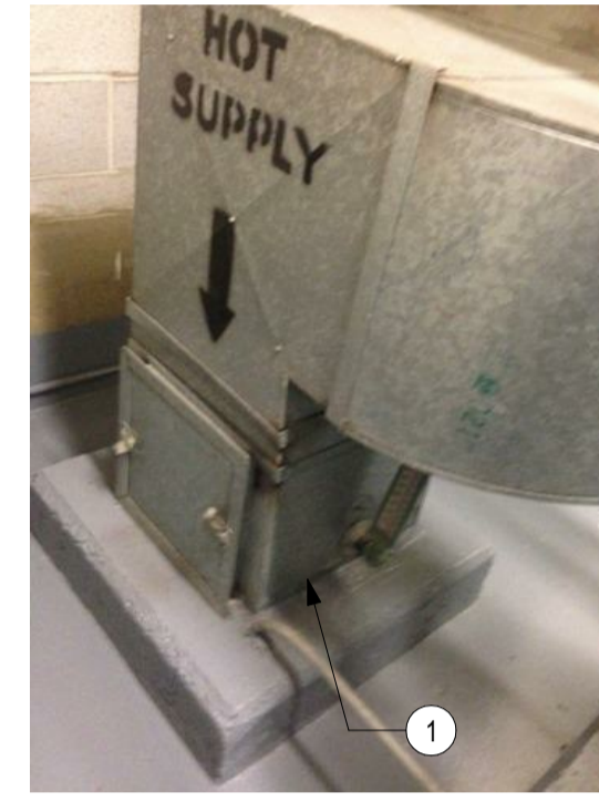
ROOM 102 - FAN ROOM PHOTO 219
