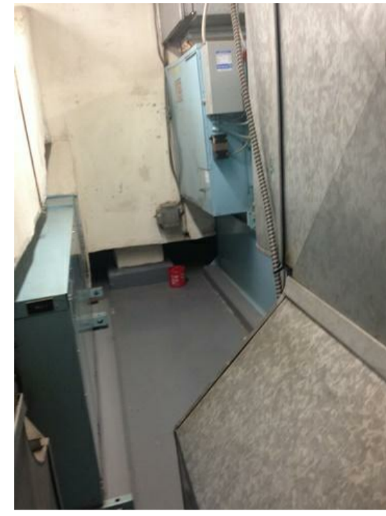
ROOM 102 - FAN ROOM PHOTO 220
