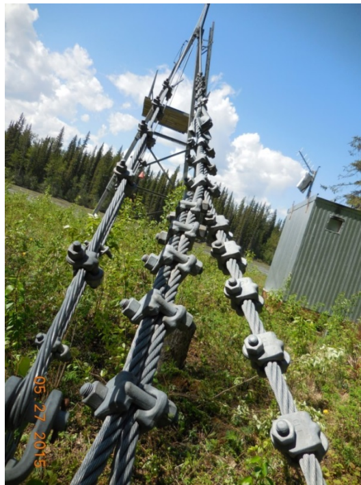
Photographie 4 : Extrémités de câbles de type pince typiques
