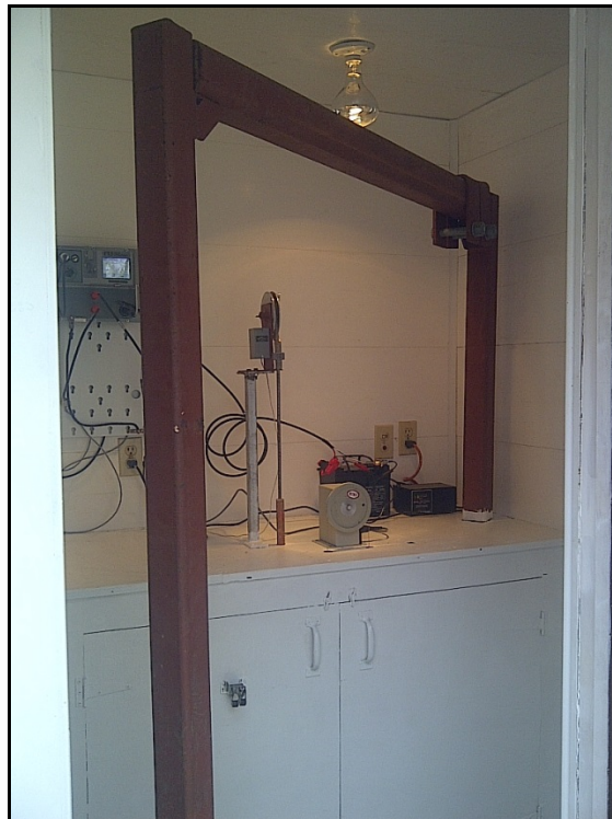
Photographie 6 : Structure d'ancrage antichute à l'intérieur d'un abri au-dessus d'un puits
