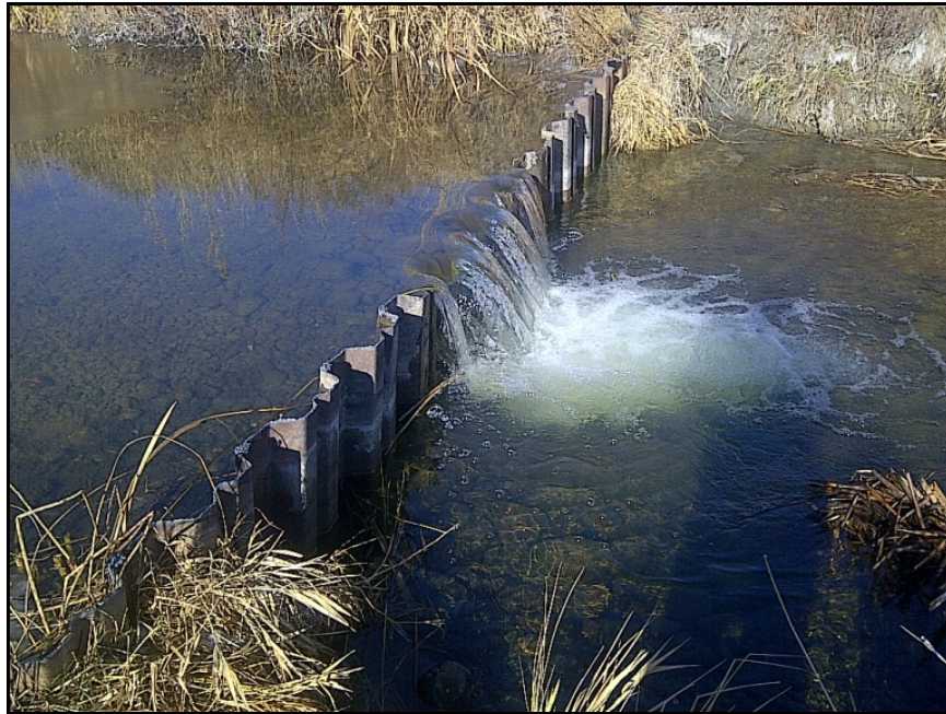
Photographie 7 : Déversoir en planches d'acier typique
