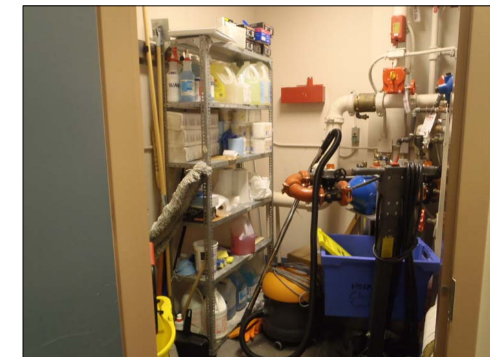
05 G150 SPRINKLER A007
