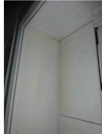
Fig.187 Dommages probables sur la face cachée des bâtis de fenêtre. - F25-S1
