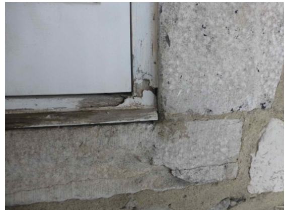
Fig.185 Seuils extérieurs détériorés - F25-S1
