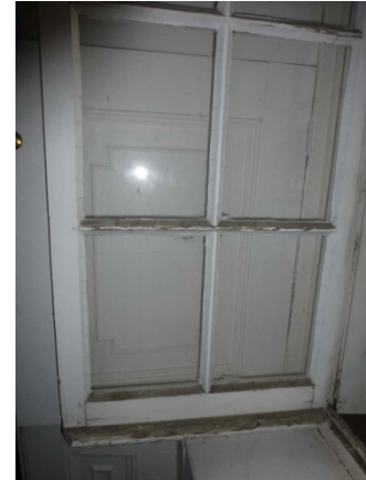
Fig.191 Détérioration des traverses inférieures, 2 e étage - F25-S1
