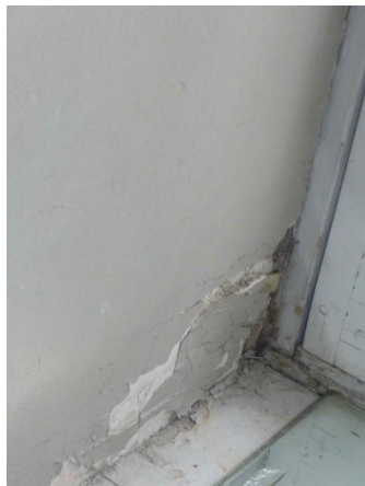
Fig.212 Infiltration d'eau et dommages aux finis intérieurs des lucarnes - F43-S1.
