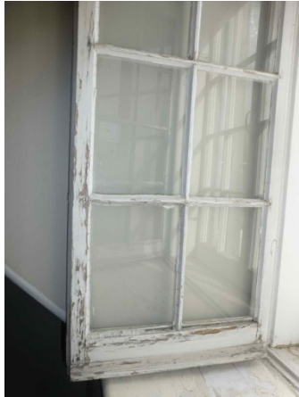
Fig.198 Détérioration des volets, exposés aux intempéries – F31-S1.
