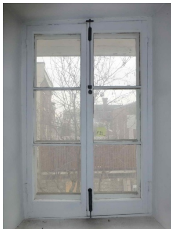
Fig.192 Volets adaptés à la déformation de la maçonnerie 3 e étage – F32-E3
