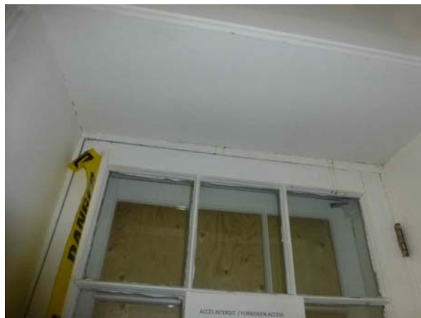
Fig.195 Infiltration d'eau jusqu'aux finis intérieures – P31-S2
