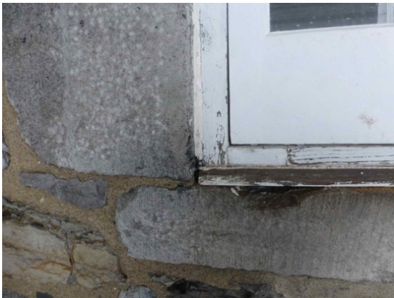
Fig.184 Seuils extérieurs détériorés - F25-S1
