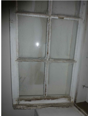
Fig.162 Détérioration des volets ouvrants - F23-S1
