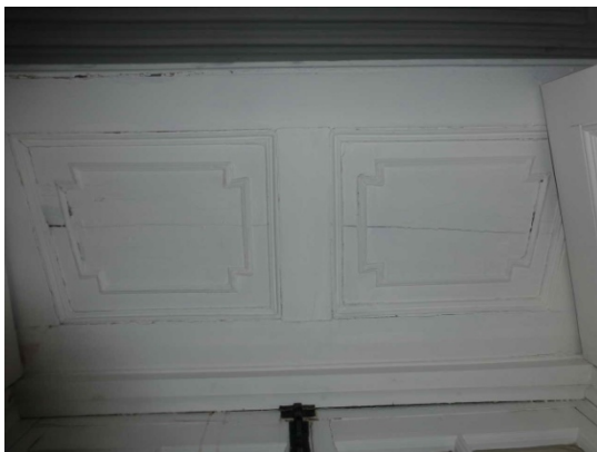
Fig.170 Boiseries murales endommagées, Mur S1 – F24-S1
