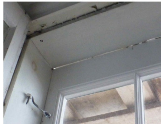
Fig.179 Déformation et infiltration d'air autour des contre-fenêtres. F25-S1
