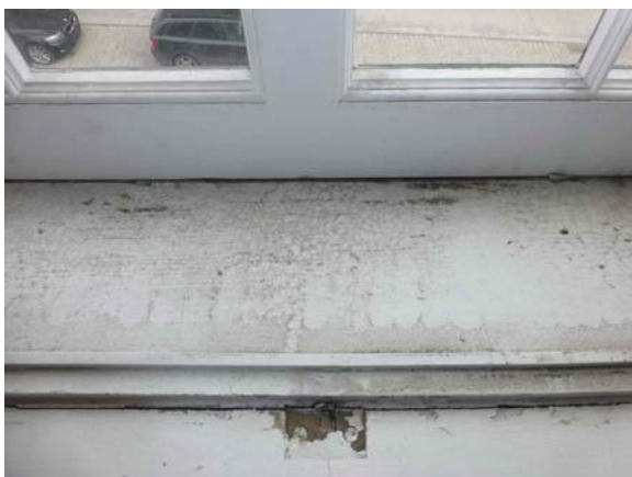
Fig.204 Seuils des lucarnes : Ruissellement dans l'entre-fenêtre – F33-N1.
