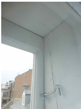
Fig.200 Ruissellement dans l'entre-fenêtre, Combles 1 – F42-S1.
