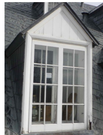
Fig.201 Finition et profil extérieurs des lucarnes favorisant l'infiltration – F34-S1.
