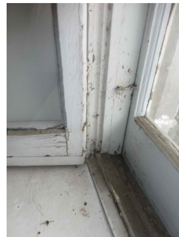
Fig.193 Seuils intérieurs sans protection – F32-E3
