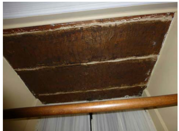
Fig.165 Linteaux en bois et infiltration au rez-de-chaussée - F11-S1
