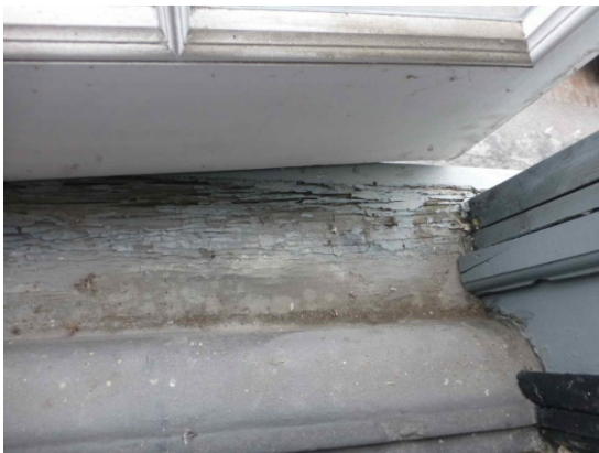
Fig.178 Seuils intérieurs sans protection - F26-N1
