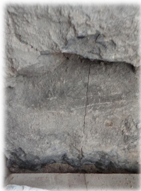
Photo 19 : Ouverture exploratoire 2 - Fissuration de la pierre
