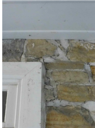
Fig.90 [Lézarde N2 à droite de la porte P11-E1].
