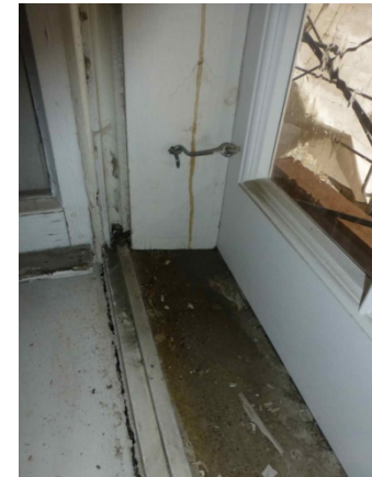
Fig.189 Seuils intérieurs détériorés, présence fréquente d'eau - F24-S1
