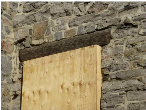
Fig.194 Linteau de bois non protégé favorisant l'infiltration dans le bâti – P31-S2
