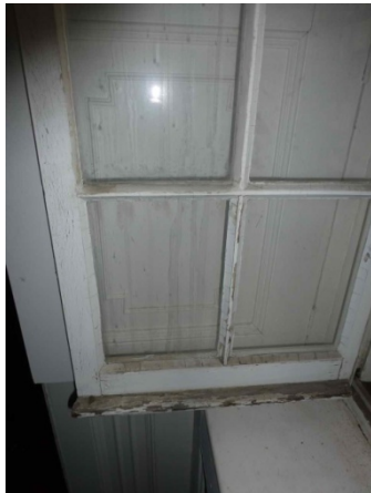
Fig.188 Ruissellement d'eau dans l'entre-fenêtre, - F24-S1
