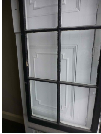
Fig.190 Mastic des vitrages à reprendre- F27-N1
