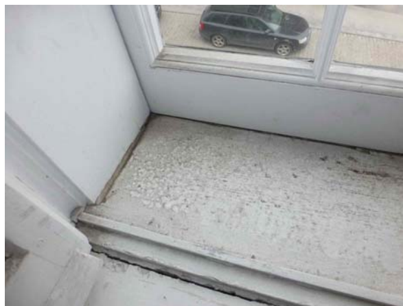
Fig.203 Ruissellement dans l'entre-fenêtre – F33-N1.
