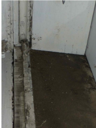
Fig.186 Seuils intérieurs détériorés par la présence prolongée d'eau - F25-S1
