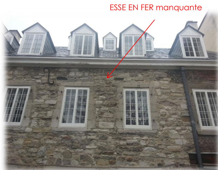
Photo 21 : Façade côté arrière- Esse en fer manquante
