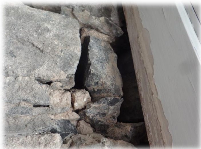
Photo 20 : Ouverture exploratoire 2 - Désordre côté extérieur du mur
