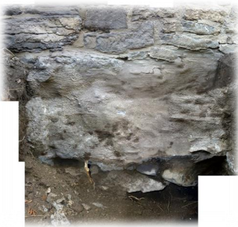
Photo 18 (transmise par l'architecte) : Cuisine - Fondation du mur de maçonnerie côté cour arrière
