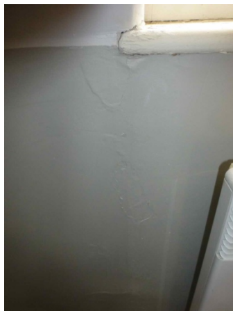
Fig.196 Infiltration de l'eau jusqu'aux finis intérieurs – F31-S1.
