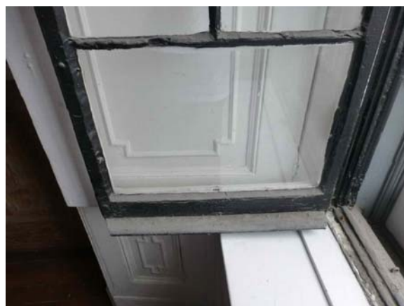
Fig.175 Petit bois et vitrage endommagé, F26-N1
