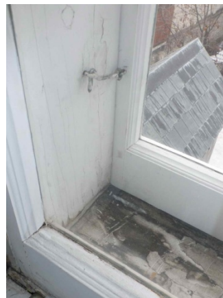
Fig.213 Ruissellement dans l'entre-fenêtre - F43-S1.
