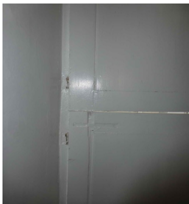
Fig.172 Réparation inadaptée d'un volet d'intimité
