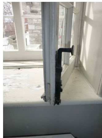
Fig.197 Infiltration de l'eau jusqu'aux finis intérieurs – F31-S1.
