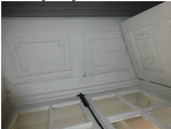
Fig.168 Boiseries murales endommagées, Mur S1 – F24-S1
