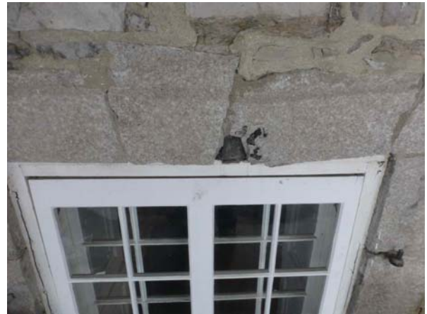
Fig.183 Déformation des ouvertures des fenêtres. F24-S1
