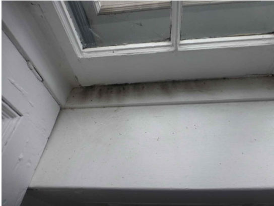
Fig.176 Infiltration d'air jusqu'à l'intérieur sous les volets, F26-N1
