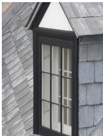
Fig.202 Profil extérieur des lucarnes favorisant l'infiltration – F42-N1.
