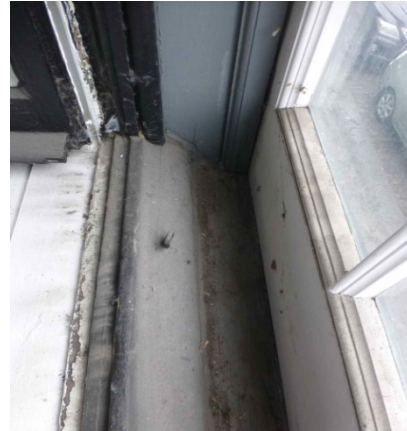
Fig.177 Infiltration d'air jusqu'à l'intérieur sous les volets, F26-N1
