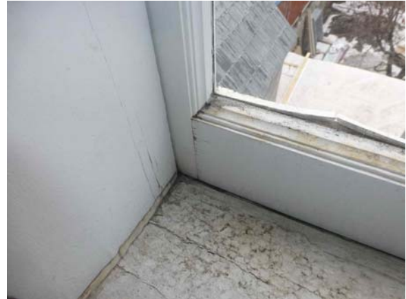
Fig.199 Ruissellement d'eau dans l'entre-fenêtre – F41-S1.
