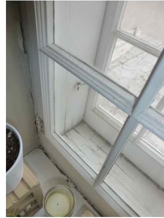
Fig.207 Ruissellement dans l'entre-fenêtre – F35-S1.
