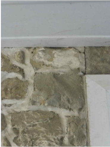
Fig.89 [Lézarde N2 à gauche de la porte P11-E1].
