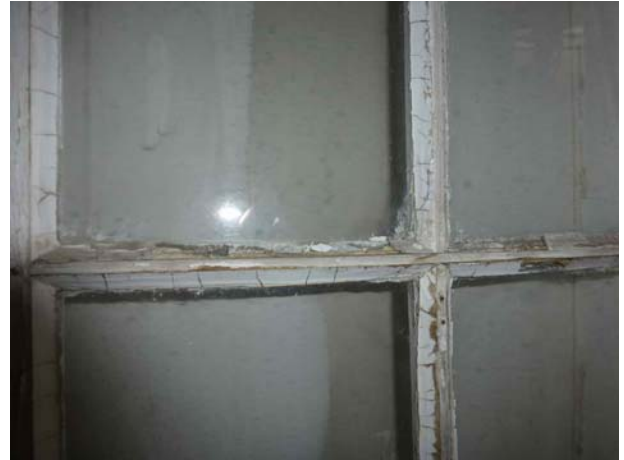
Fig.163 Mastic détérioré - F23-S1
