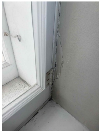
Fig.210 Infiltration et dommages aux finis intérieurs des lucarnes - F33-N1.
