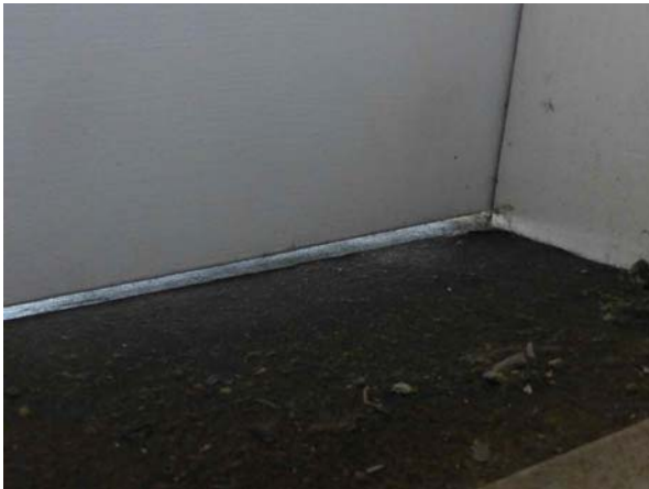
Fig.182 Déformation et infiltration d'air autour des contre-fenêtres. Mur S1
