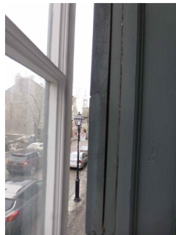
Fig.159 Bombement et infiltration dans le parement - F27-N1
