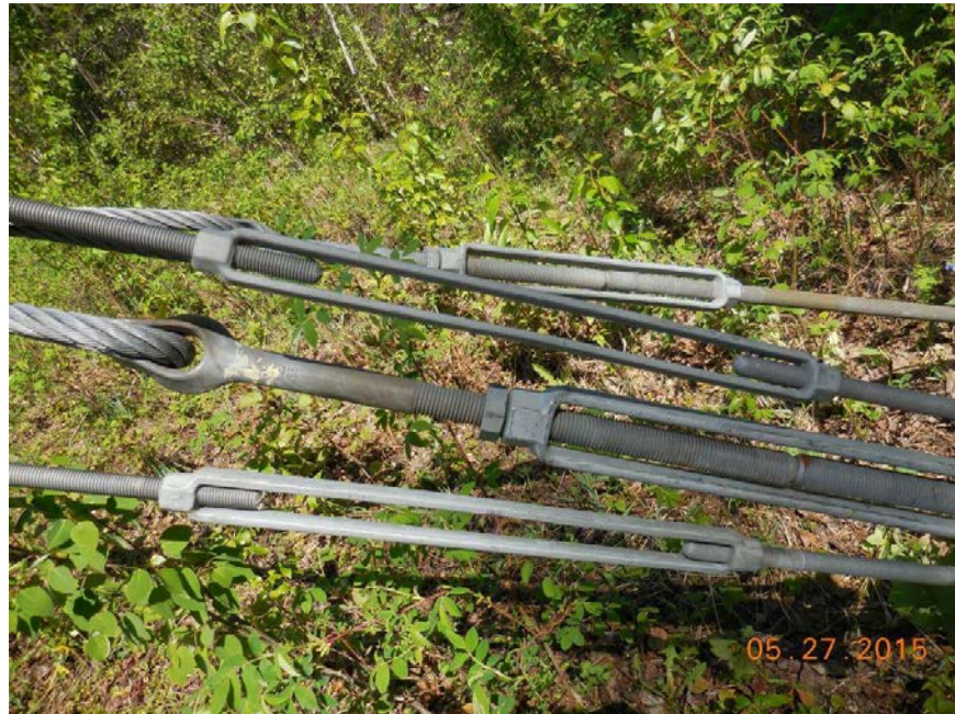
Photographie 3 : Tendeurs de câbles typiques
