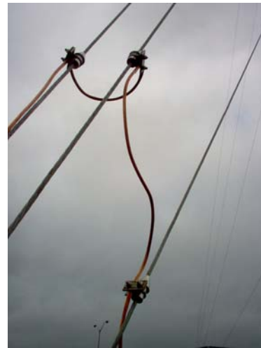
Figure 2-3 Des dispositifs brise-glace sont fixés au-dessus des attaches préformées pour empêcher la glace de faire affaisser les câbles et de les faire sortir des attaches. Une liaison résistante à la corrosion, par plaques en acier inoxydable, est aussi assurée entre le câble de terre en cuivre toronné et les câbles de hauban galvanisés par immersion à chaud.
