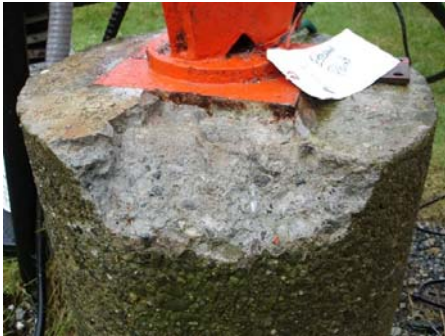
Figure 1-1 Effritement partiel d'une fondation de tour dû à un foudroiement.
