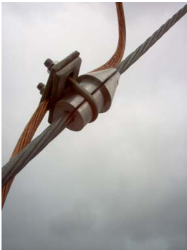
Figure 2-2 Mise à la terre individuelle des câbles de hauban près des ancres, au-dessus des attaches préformées, au moyen de dispositifs brise-glace en acier inoxydable.
