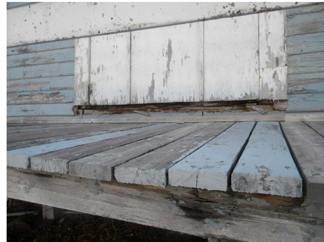
PHOTO 3 - SEUIL DE PORTE EXISTANT
