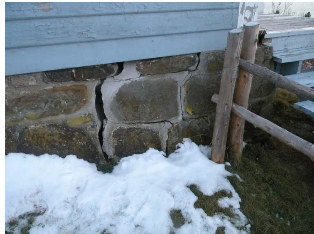
PHOTO 1 - FONDATION FISSURÉE EXISTANTE
