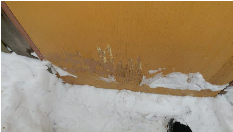
Photo 7 : Vue de la porte de bois du local mécanique où a été prélevé l'échantillon composé de peinture jaune avec sous-couche rosée pour l'analyse de la teneur en plomb totale (échantillon PM-EXT-PEINT-A).
