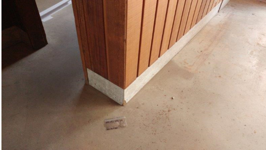
Photo 5 : Vue d'un panneau de fibrociment contenant de l'amiante de type chrysotile à 50 – 55% (échantillon PM-Mur-PFC – 03).
