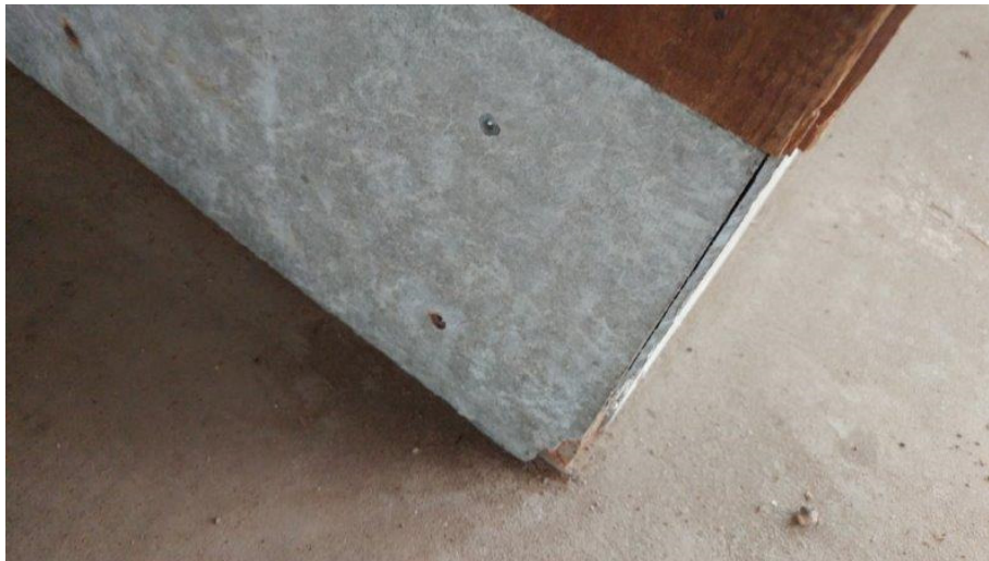
Photo 6 : Vue rapprochée d'un panneau de fibrociment contenant de l'amiante de type chrysotile à 50 – 55% (échantillon PM-Mur-PFC – 03).
