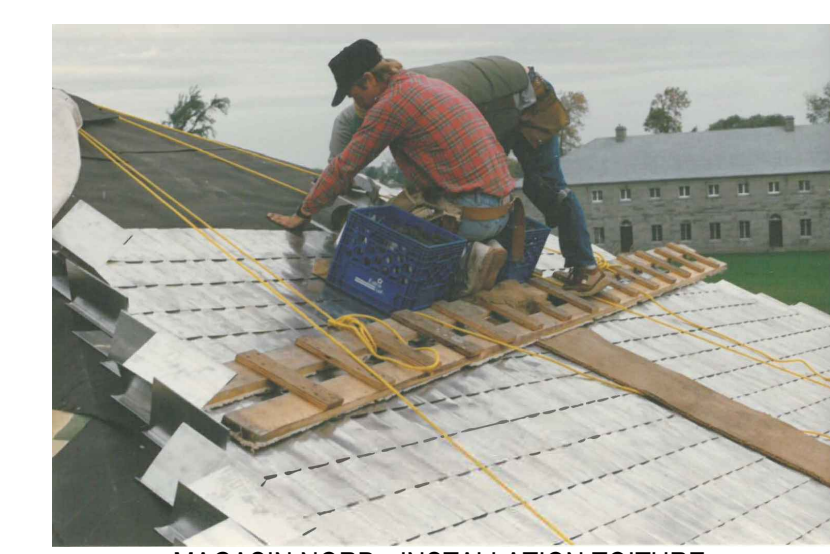
P2 MAGASIN NORD - INSTALLATION TOITURE EXTRAIT DU VOLUME 4 - 23 AVRIL 1991 SANS ECHELLE - Toiture_1989_1
