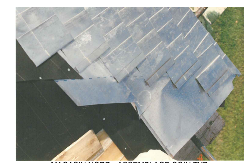
P4 MAGASIN NORD - ASSEMBLAGE COIN TYP. EXTRAIT DU VOLUME 4 - 23 AVRIL 1991 SANS ECHELLE - Toiture_1989_3
