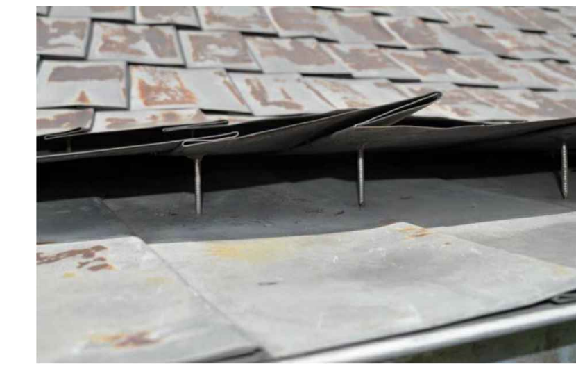
P6 MAGASIN NORD - FIXATION DE LA TÔLE EXISTANTE EXTRAIT DU "RAPPORT D'INVESTIGATION" MARS 2016 SANS ECHELLE - Photo_2015_Toiture_Fixation
