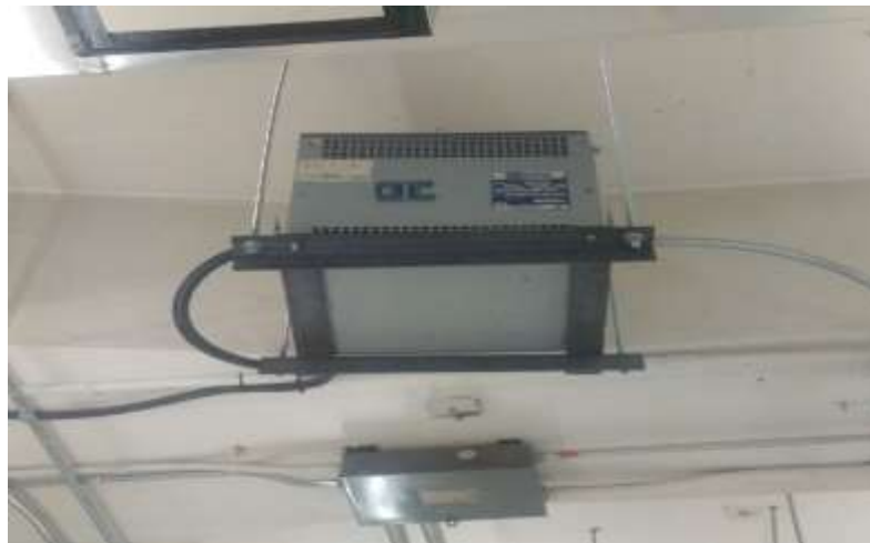
Figure 3-3 Transformateur actuel installé au plafond et utilisé avec le tour Primero PL-1840
