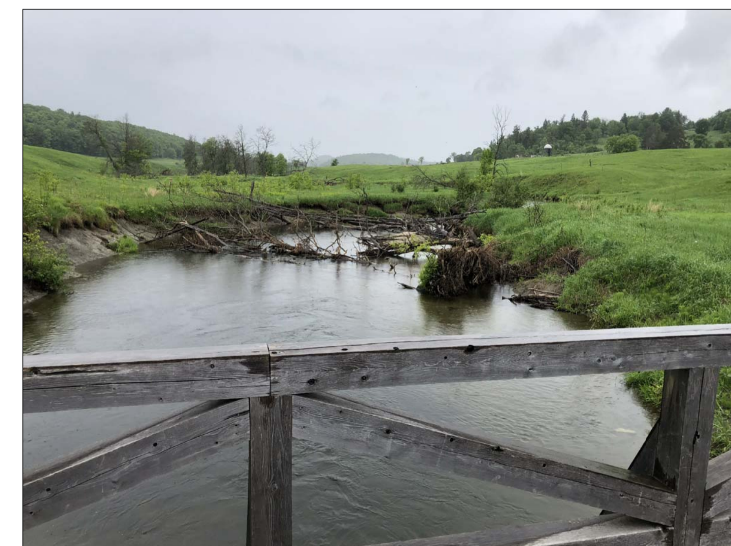
BLOCAGE D'ARBE À ÊTRE ENLEVÉ EN AVAL TREE BLOCKAGE TO BE REMOVED DOWNSTREAM
