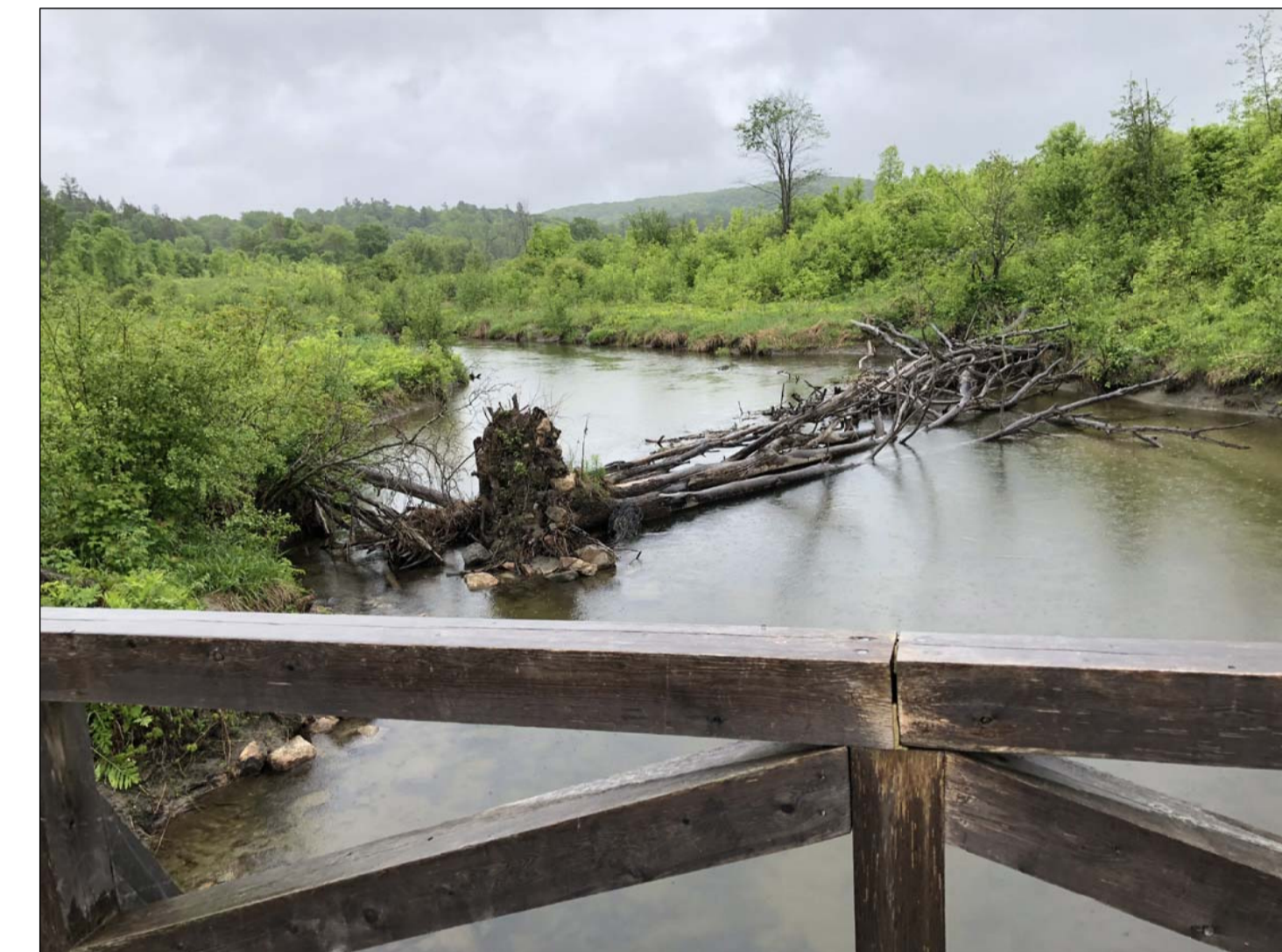
BLOCAGE D'ARBE À ÊTRE ENLEVÉ EN AMONT TREE BLOCKAGE TO BE REMOVED UPSTREAM
