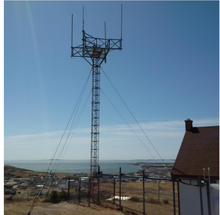
Pylône haubané de NAVCAN et son étagère à câbles
