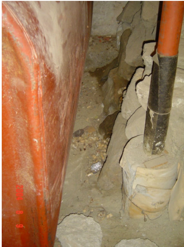
Photo 3: Vue de l'installation autour du réservoir. (727-06-08-2004.JPG)
