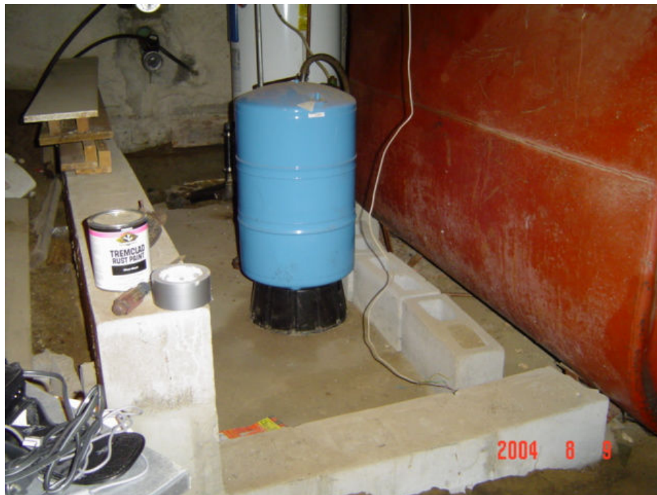
Photo 2: Vue de l'installation autour du réservoir. (727-02-08-2004.JPG)
