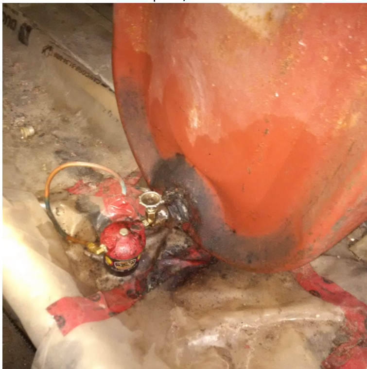
28. – Oil tank crawl space / Réservoir d'huile sous-sol
