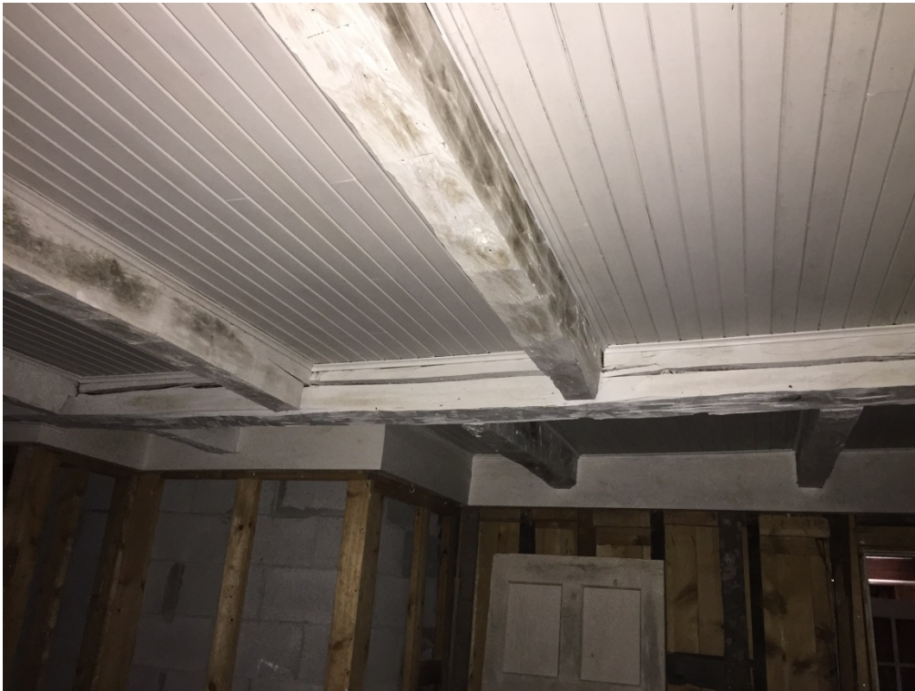
19. – Cracked beam (ground floor) / Poutre fissurée (rez-de-chaussée)
