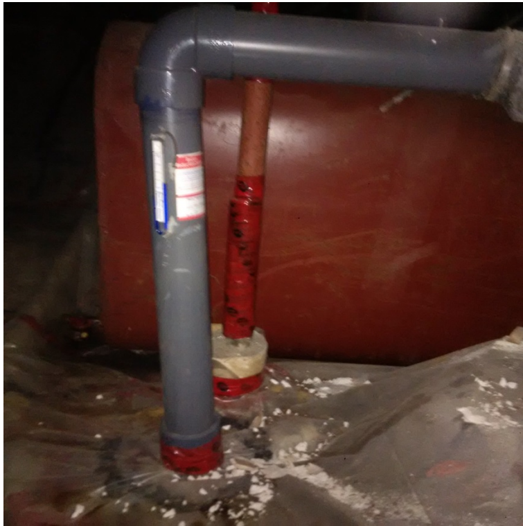
27. – Oil tank crawl space / Réservoir d'huile sous-sol
