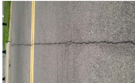
Fig. 4 : Fissures longitudinales et transversales de haute sévérité à sceller
