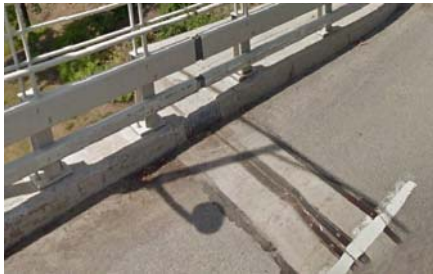
Fig. 3 : Fissure typique observée au niveau des joints d'expansion à sceller
