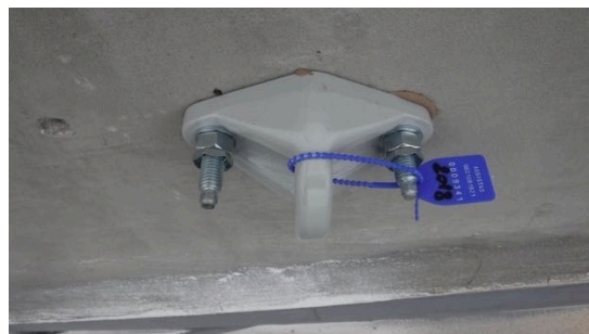
Point d'ancrage : Le repérage des points d'ancrage a été réalisé l'aide de scellés individuels suite à la vérification du N°9341 au N°9357
