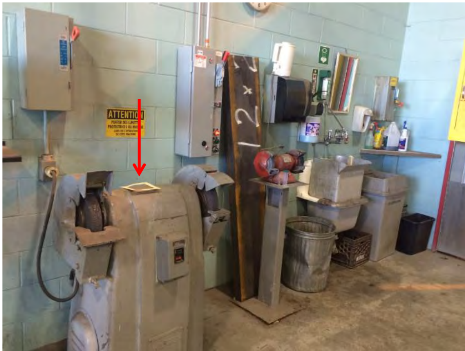
Photo 17 : Frottis de surface effectué sur un équipement – Échantillon prélevé sur la meuleuse (éch.# E-5, C > 11 µg/100 cm 2 )
