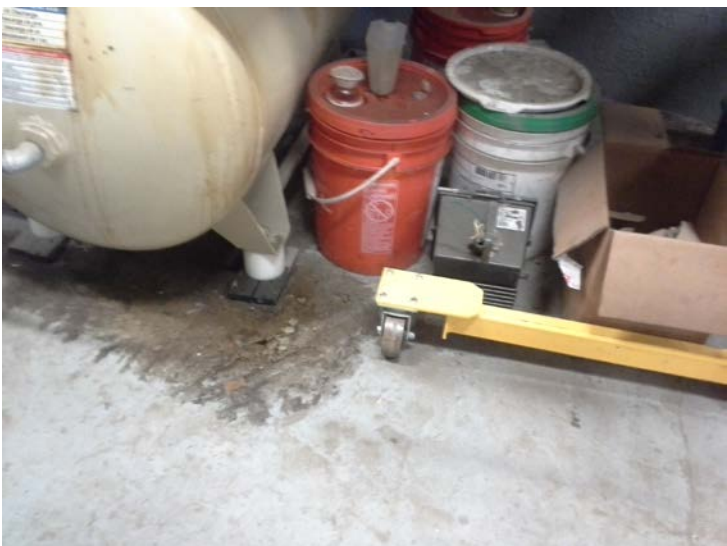
PHOTO 11 Taches d'huile observées sous le compresseur lors de la visite
