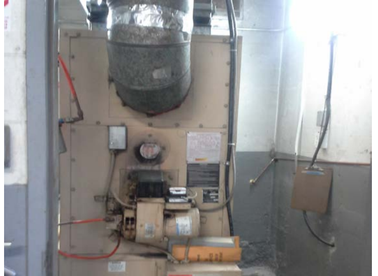
PHOTO 8 Fournaise alimentée par deux (2) réservoirs de mazout hors-sol
