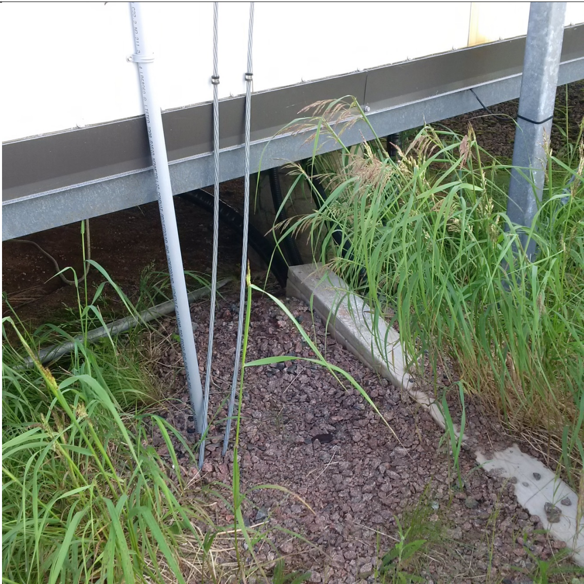
Photo 5 : Entrée des câbles
