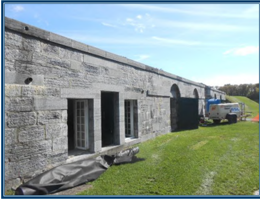
Photo 1: Vue générale de l'extérieur des casemates Nord L'emplacement des fenêtres représente la cuisine Murs extérieurs en pierre carrée et mortier (TPSGC-LENNOX-CASEMATES N-MORTIER EXT-2A-I) – ne contiennent pas d'amiante Peinture blanche sur les fenêtres de la cuisine Peinture verte sur les portes
