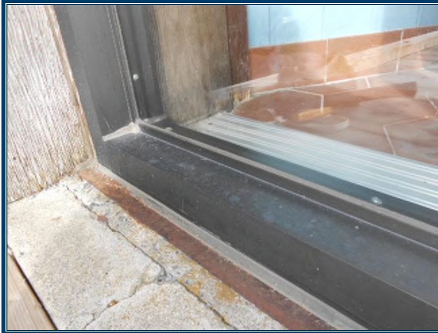
Photo 119: Joint d'étanchéité gris appliqué au pourtour extérieur des fenêtres (TPSGC-LENNOX-ACCUEIL-EXT-JOINT-1) – ne contient pas d'amiante
