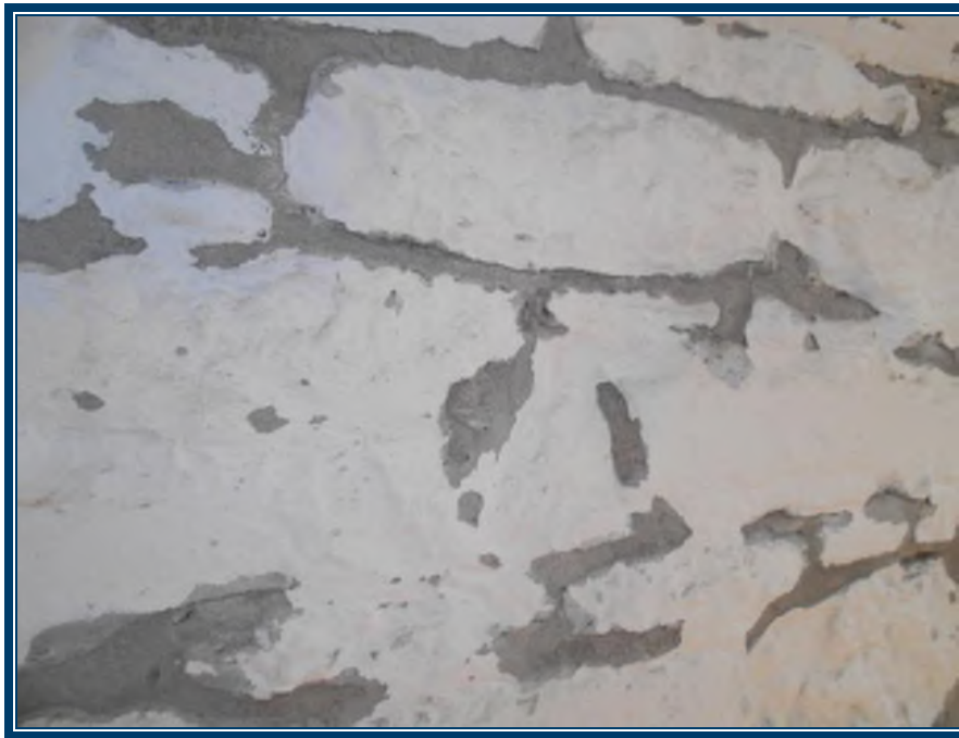
Photo 34: Rez-de-chaussée Murs au rez-de-chaussée en pierre recouvertes de plâtre ciment Plâtre ciment (TPSGC-LENNOX-MAG SUD-RDC-P/C-1A-I) – ne contient pas d’amiante Mortier de pierre (TPSGC-LENNOX-MAG NORD-EXT-MORTIER-5A-I) – ne contient pas d’amiante
