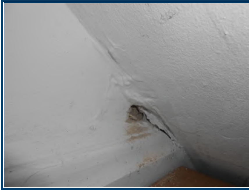
Photo 27: Rez-de-chaussée Mur en plâtre ciment en-dessous de l'escalier (TPSGC-LENNOX-OFFICIERS-RDC-MUR-P/C-6A-I) – contient 0,1-1% d'amiante de type chrysotile dans la phase ciment
