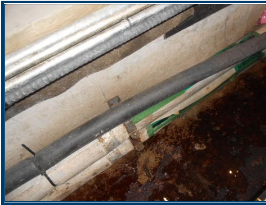
Photo 28: Vide sanitaire du bâtiment Tuyauterie isolée avec de la laine de verre ou avec un isolant de type armaflex
