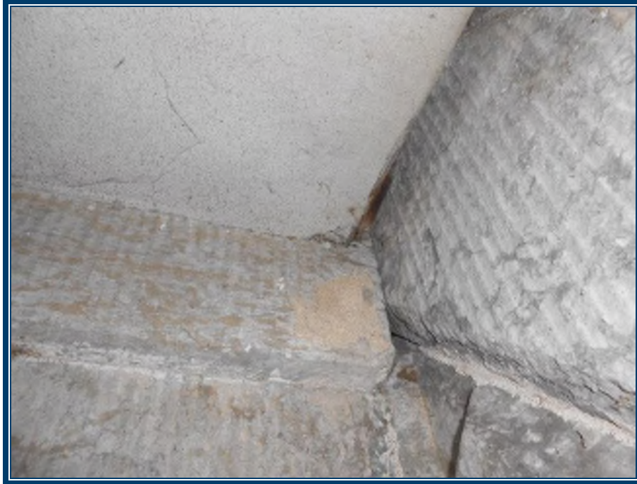
Photo 91: Extérieur Plafond en panneaux de ciment préfabriqués (TPSGC-LENNOX-CORPS-EXT-PANNEAU PREFAB-6) – ne contient pas d’amiante
