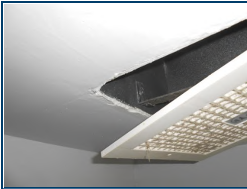
Photo 22: Étage Plafond en plâtre ciment dans la salle de bain (TPSGC-LENNOX-OFFICIERS-ETAGE-PF-P/C-3A-I) – ne contient pas d’amiante
