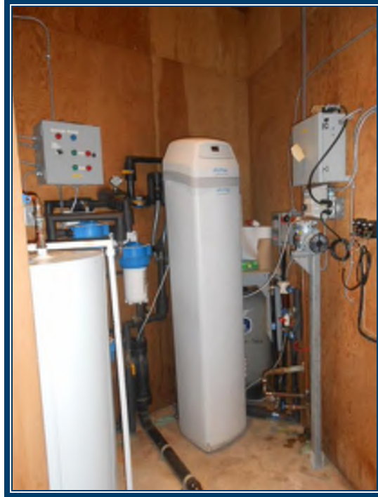
Photo 121: Vue de la salle mécanique Tuyauterie non isolée ou isolée avec un isolant de type armaflex Murs en panneaux de bois Plancher de béton
