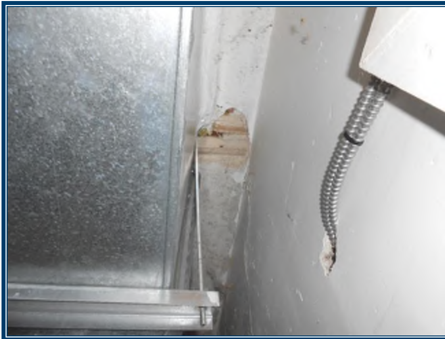
Photo 24: Étage Plafond en plâtre ciment endommagé dans la chaufferie (TPSGC-LENNOX-OFFICIERS-ETAGE-PF-P/C- 3A-I) – ne contient pas d'amiante
