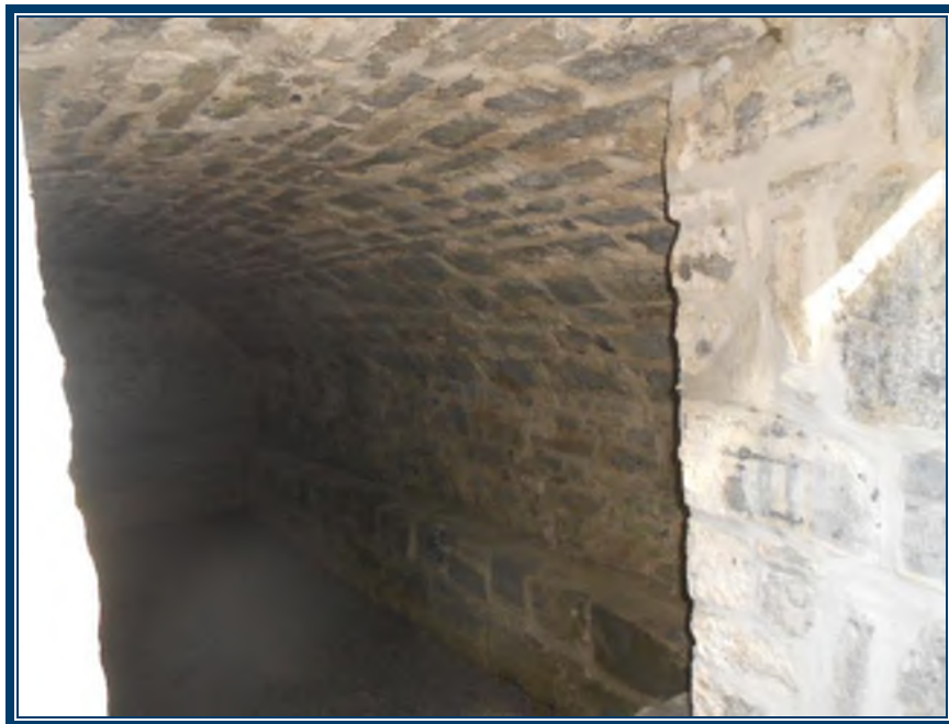
Photo 6: Murs et plafond (arche) des casemates en pierre et mortier Mortier de pierre intérieur (TPSGC-LENNOX-CASEMATES O-MORTIER INT-1A-I) – ne contient pas d'amiante
