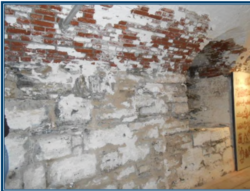
Photo 40: Rez-de-chaussée Mortier de brique (TPSGC-LENNOX-MAG NORD-RDC-MORTIER BRIQUE-2A, B, C, D) – ne contient pas d’amiante Mortier de pierre (TPSGC-LENNOX-MAG NORD-RDC-MORTIER PIERRE-1D, E, F, H) – ne contient pas d’amiante Plâtre ciment (TPSGC-LENNOX-MAG NORD-RDC-P/C-3A-I) – ne contient pas d’amiante
