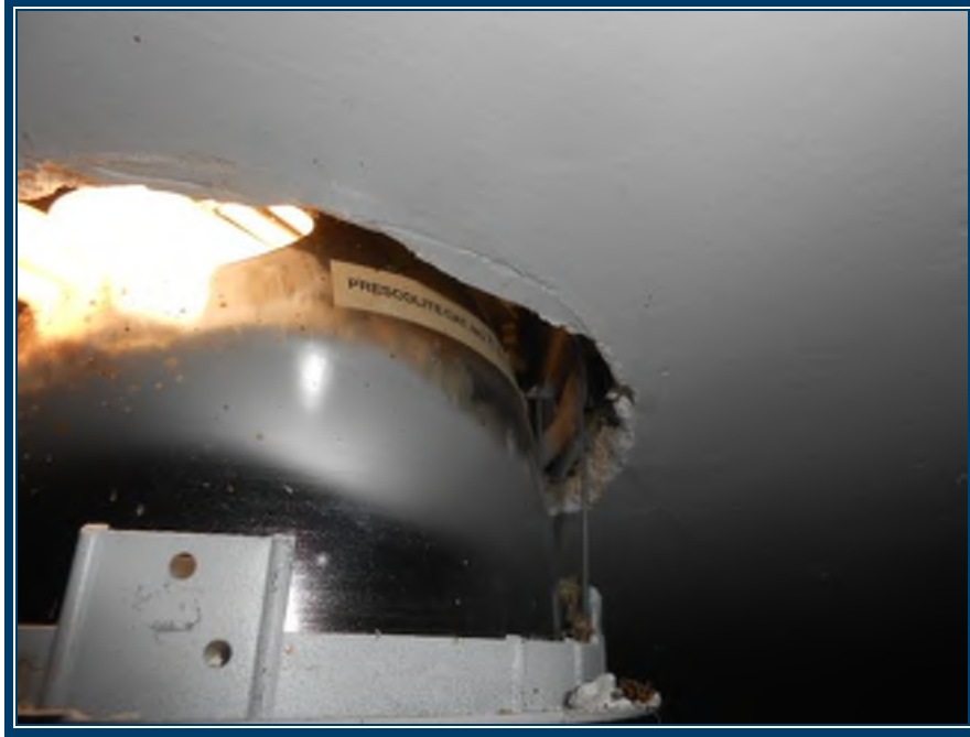
Photo 21: Étage Plafond en plâtre ciment dans le corridor (TPSGC-LENNOX-OFFICIERS-ETAGE-PF-P/C-3A-I) – ne contient pas d’amiante
