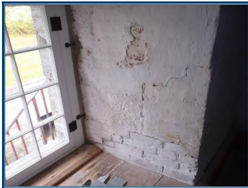
Photo 68: Étage, mur périphérique Mortier de brique (TPSGC-LENNOX-CASERNE-RDC-MORTIER-BRIQUE-MUR-4E-I) – contient 0,1-1% d’amiante de type chrysotile dans la phase composé à joints Plâtre ciment sur les murs (TPSGC-LENNOX-CASERNE-ETAGE-MUR-P/C-7A-I) – ne contient pas d’amiante
