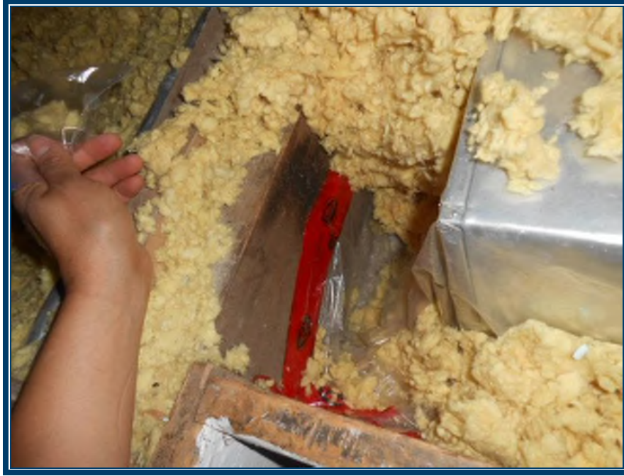
Photo 19: Grenier du bâtiment Laine isolante jaune au plancher
