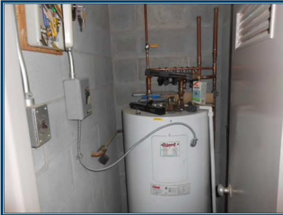
Photo 117: Conciergerie Tuyauterie non isolée Murs en blocs de béton non peints
