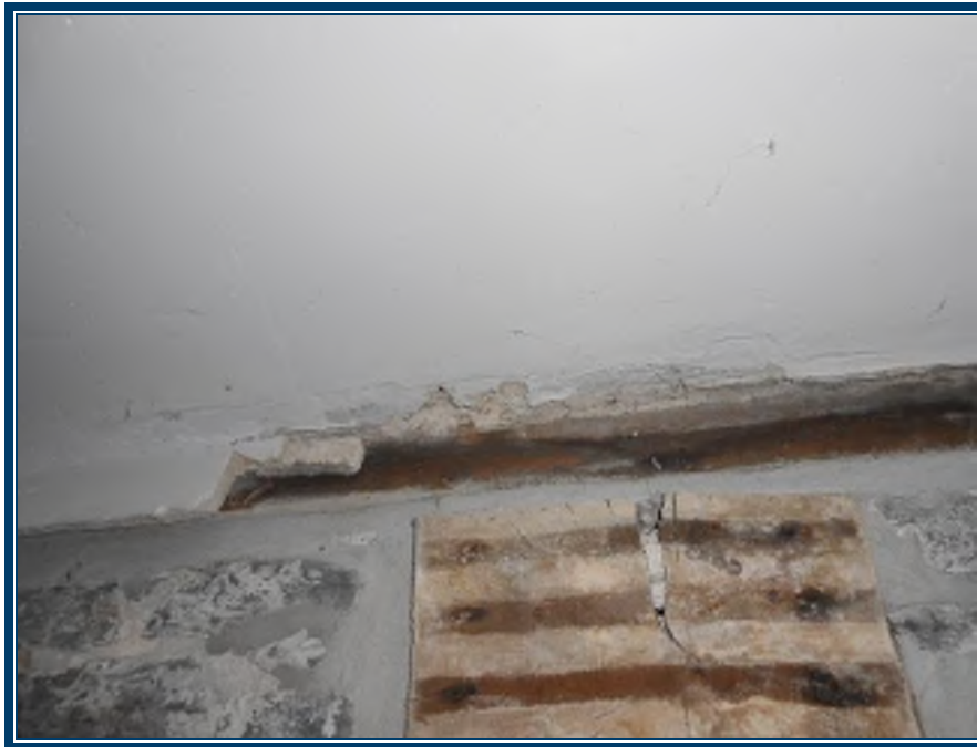
Photo 18: Étage, chaufferie Plâtre ciment au mur (TPSGC-LENNOX-OFFICIERS-ETAGE-MUR-P/C-1A-I) - contient 0,1-1% d’amiante de type chrysotile Plâtre ciment au plafond (TPSGC-LENNOX-OFFICIERS-ETAGE-PF-P/C-3A-I) – ne contient pas d’amiante Mur en pierre et mortier (TPSGC-LENNOX-OFFICIERS-MUR-MORTIER-4A-I) – ne contient pas d’amiante
