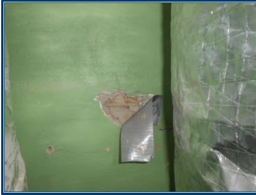
Photo 23: Étage Mur en plâtre ciment dans l'armoire du salon (TPSGC-LENNOX-OFFICIERS-ETAGE-MUR-P/C-1A-I) - contient 0,1-1% d'amiante de type chrysotile
