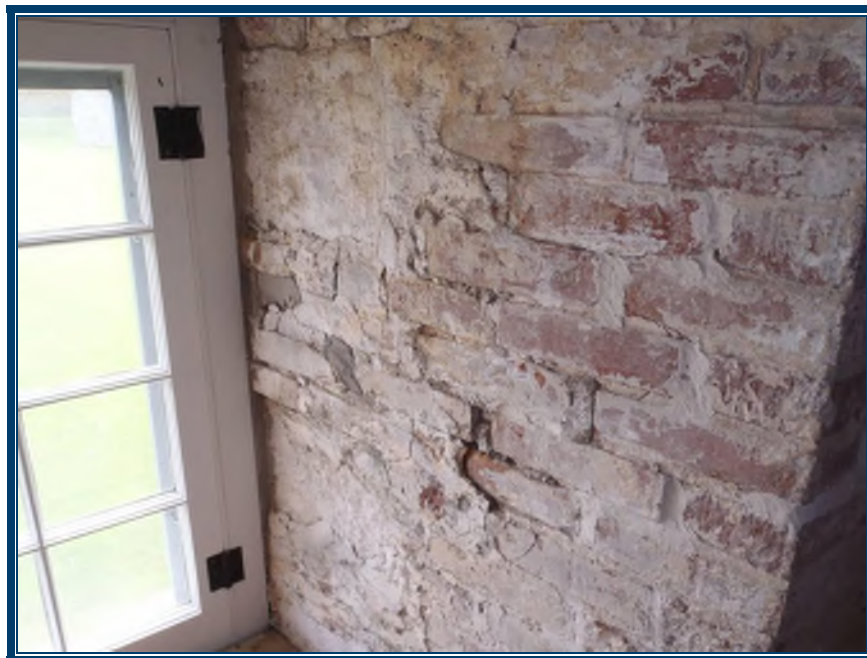
Photo 66: Étage, Mortier de brique des murs Mortier de brique (TPSGC-LENNOX-CASERNE-RDC-MORTIER-BRIQUE-MUR-4E-I) – contient 0,1-1% d'amiante de type chrysotile dans la phase composé à joints
