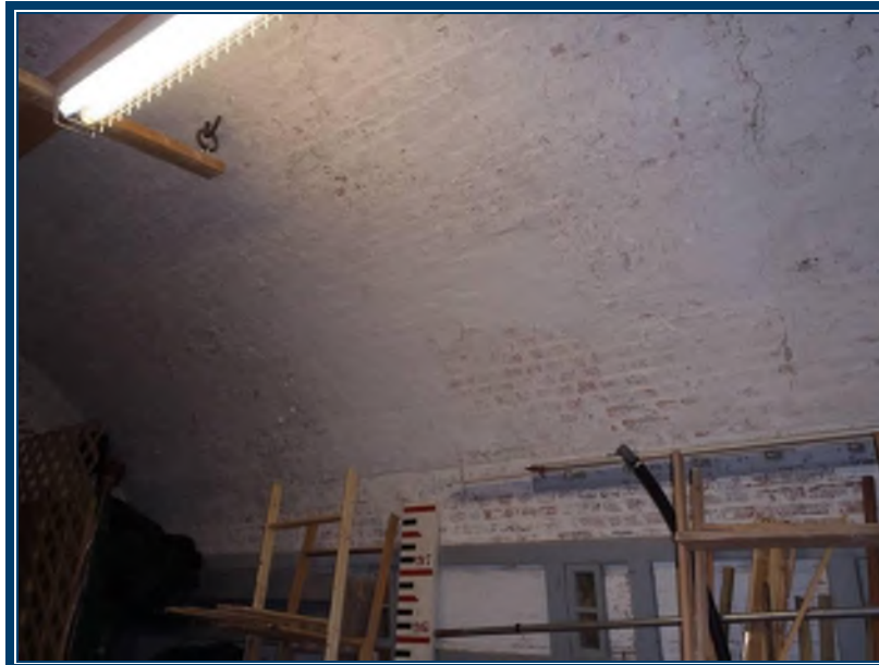
Photo 54: Rez-de-chaussée, entrepôt (local 115) Plâtre ciment des murs/plafonds en mauvais état (TPSGC-LENNOX-CASERNE-RDC-MUR-P/C-8A-I) – contient 0,1-1% d’amiante de type chrysotile dans la phase composé à joints Mortier de brique (TPSGC-LENNOX-CASERNE-RDC-MORTIER-BRIQUE-MUR-4A-D) – contient 0,1-1% d’amiante de type chrysotile dans la phase composé à joints
