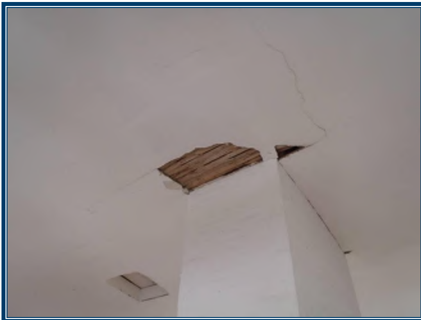
Photo 70: Étage, plafond en plâtre ciment sur lattes de bois endommagé (TPSGC-LENNOX-CASERNE-ETAGE-PF-P/C-6A-I) – ne contient pas d’amiante Plâtre ciment sur la colonne (TPSGC-LENNOX-CASERNE-ETAGE-MUR-P/C-7A-I) – ne contient pas d’amiante
