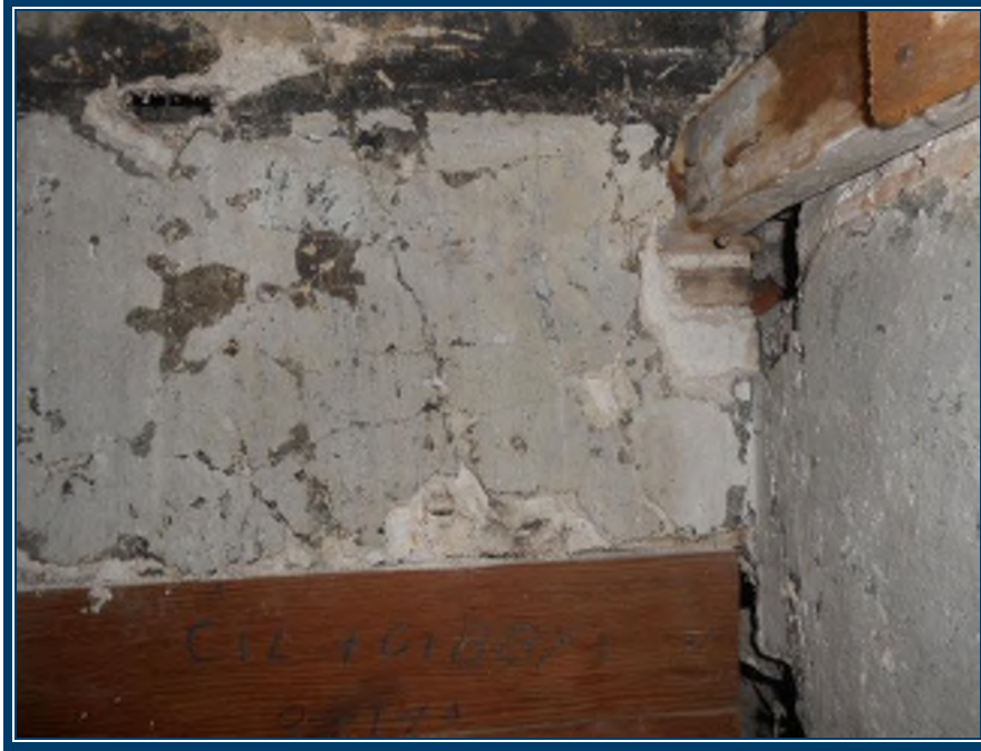
Photo 15: Étage, armoire près de la cheminée Plâtre ciment au niveau des murs (TPSGC-LENNOX-OFFICIERS-ETAGE-MUR-P/C-1A-I) - contient 0,1-1% d'amiante de type chrysotile Mortier de brique (TPSGC-LENNOX-OFFICIERS-MUR-MORTIER BRIQUE-2A-I) – ne contient pas d'amiante
