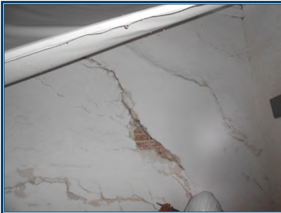
Photo 74: Murs en plâtre ciment sur briques dans le local 103 Murs en plâtre ciment (TPSGC-LENNOX-CORPS-RDC-MUR-P/C-2G) – ne contiennent pas d’amiante Mortier de brique (TPSGC-LENNOX-CORPS-RDC-MORTIER-BRIQUE-1A-I) – ne contient pas d’amiante
