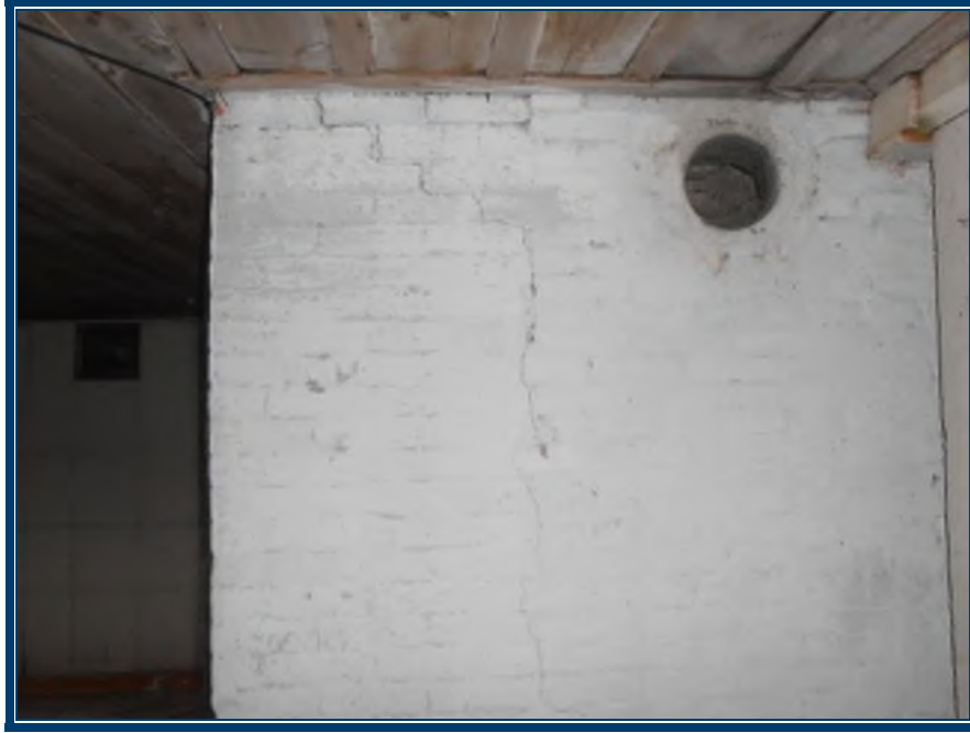
Photo 87: Étage, plâtre ciment présent sur les colonnes en brique au 2 e étage Plâtre ciment (TPSGC-LENNOX-CORPS-ETAGE-COLONNE-P/C-3I) – ne contient pas d’amiante Mortier de brique (TPSGC-LENNOX-CORPS-RDC-MORTIER-BRIQUE-1A-I) – ne contient pas d’amiante
