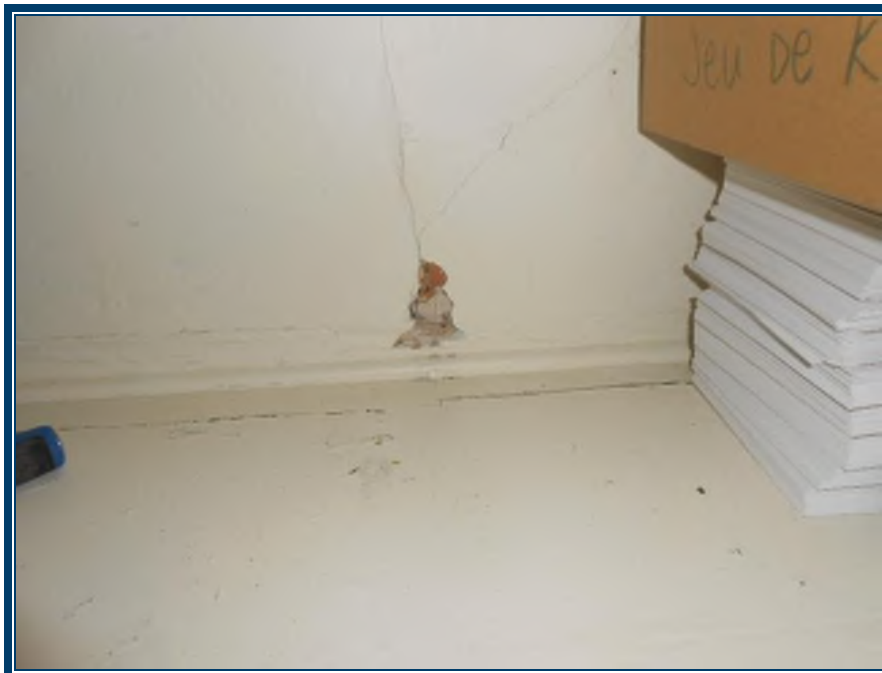
Photo 12: Étage Plâtre ciment au niveau des murs (TPSGC-LENNOX-OFFICIERS-ETAGE-MUR-P/C-1A-I) - contient 0,1-1% d'amiante de type chrysotile
