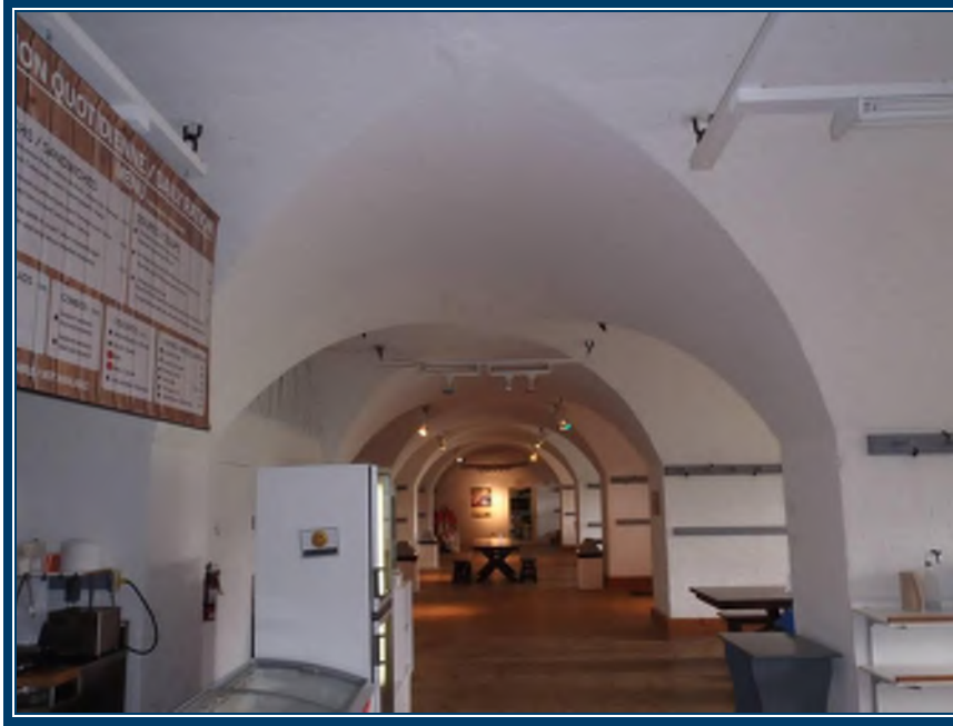
Photo 59: Rez-de-chaussée Vue générale des murs/plafonds formant des arches Plâtre ciment des murs/plafonds (TPSGC-LENNOX-CASERNE-RDC-MUR-P/C-8A-I) – contient 0,1-1% d’amiante de type chrysotile dans la phase composé à joints Mortier de brique (TPSGC-LENNOX-CASERNE-RDC-MORTIER-BRIQUE-MUR-4A-D) – contient 0,1-1% d’amiante de type chrysotile dans la phase composé à joints
