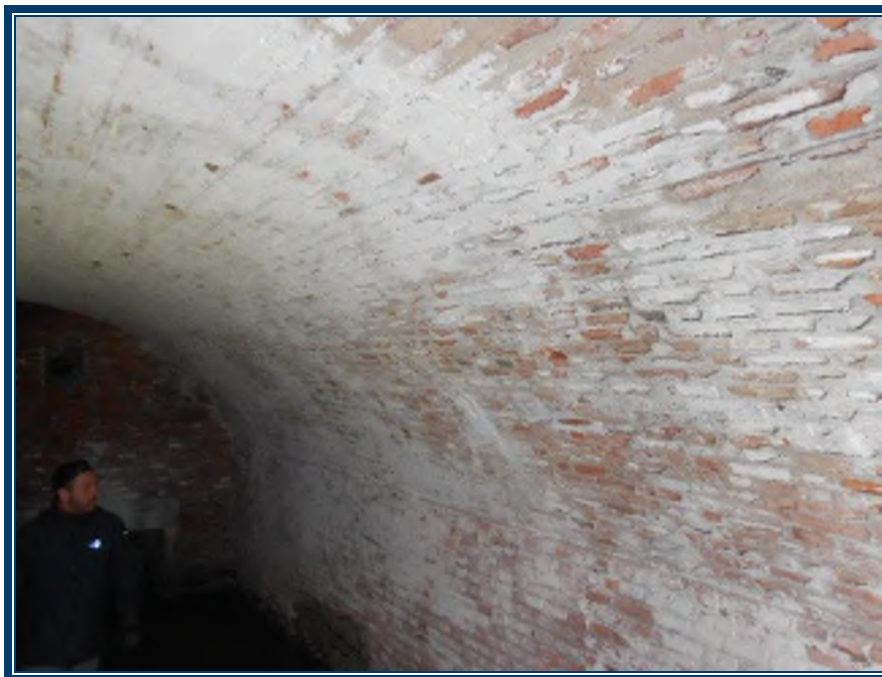
Photo 2: Murs et plafonds (arche) en briques et mortier dans le secteur des cuisines Mortier de brique (TPSGC-LENNOX-CASEMATES N-MORTIER CUISINE-3A-I) – ne contient pas d'amiante
