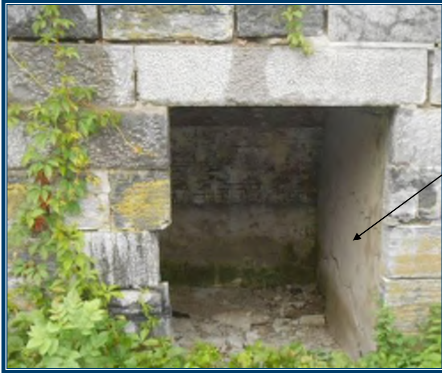
Photo 107: Murs en ciment dans les latrines (TPSGC-LENNOX-LATRINES-CIMENT INT-2A) – ne contient pas d’amiante
