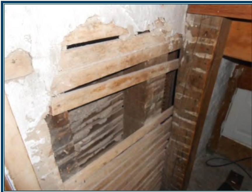
Photo 16: Étage, armoire près de la cheminée Plâtre ciment sur lattes de bois, vue de l'intérieur des murs du corridor principal (TPSGC-LENNOX-OFFICIERS-ETAGE-MUR-P/C-1A-I) - contient 0,1-1% d'amiante de type chrysotile
