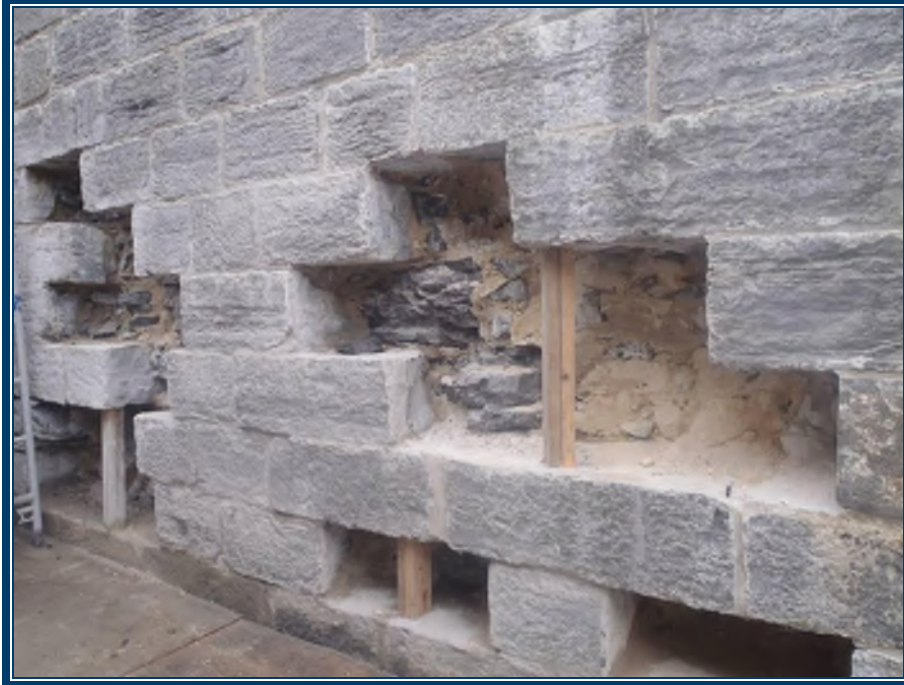
Photo 101: Vue des deux (2) types de mortier présents au niveau de la porte et du passage Nord Mortier extérieur gris sur pierres carrées (TPSGC-LENNOX-PORTE N-MUR-MORTIER-2A-I) – ne contient pas d’amiante Mortier intérieur beige sur pierres naturelles (TPSGC-LENNOX-PORTE N-MUR-MORTIER-1A-I) – ne contient pas d’amiante
