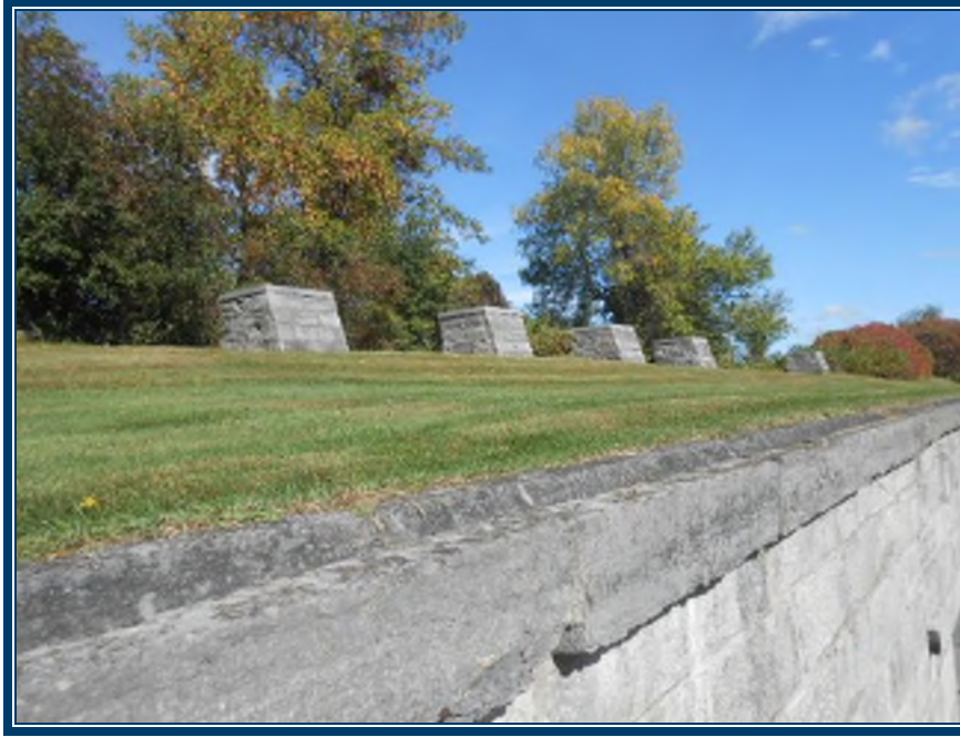
Photo 7: Vue extérieure des casemates Ouest Murs extérieurs en pierres carrées et mortier (TPSGC-LENNOX-CASEMATES O-MORTIER EXT-2A-I) – ne contient pas d'amiante
