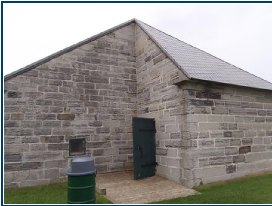
Photo 92: Vue générale extérieure de la poudrière Murs en pierre et mortier (TPSGC-LENNOX-POUDRIERE-MUR-MORTIER PIERRE-2A-I) – ne contient pas d’amiante
