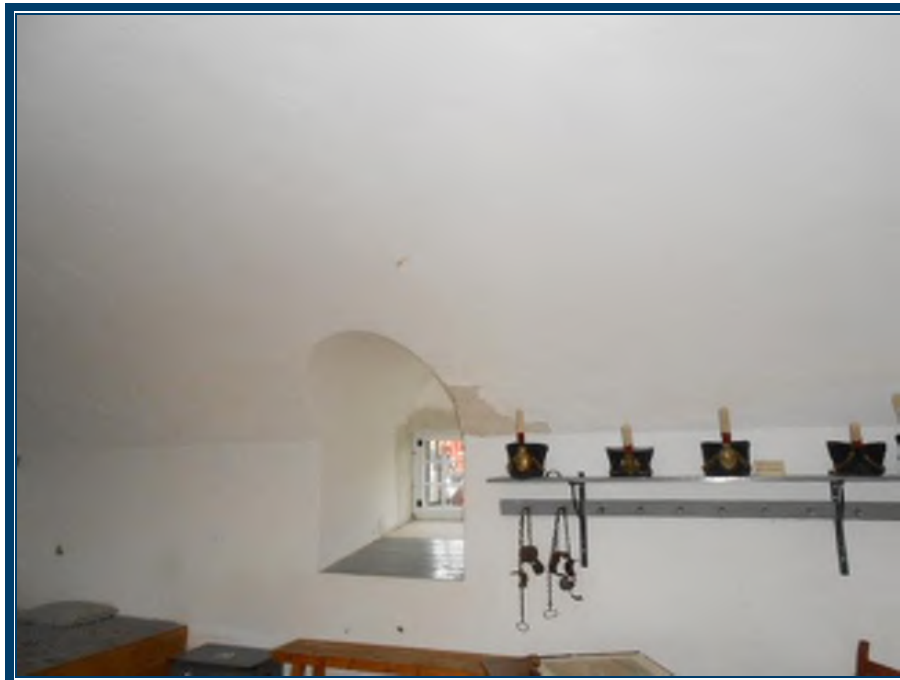
Photo 72: Murs en plâtre ciment sur briques au rez-de-chaussée Murs en plâtre ciment (TPSGC-LENNOX-CORPS-RDC-MUR-P/C-2G) – ne contiennent pas d’amiante Mortier de brique (TPSGC-LENNOX-CORPS-RDC-MORTIER-BRIQUE-1A-I) – ne contient pas d’amiante
