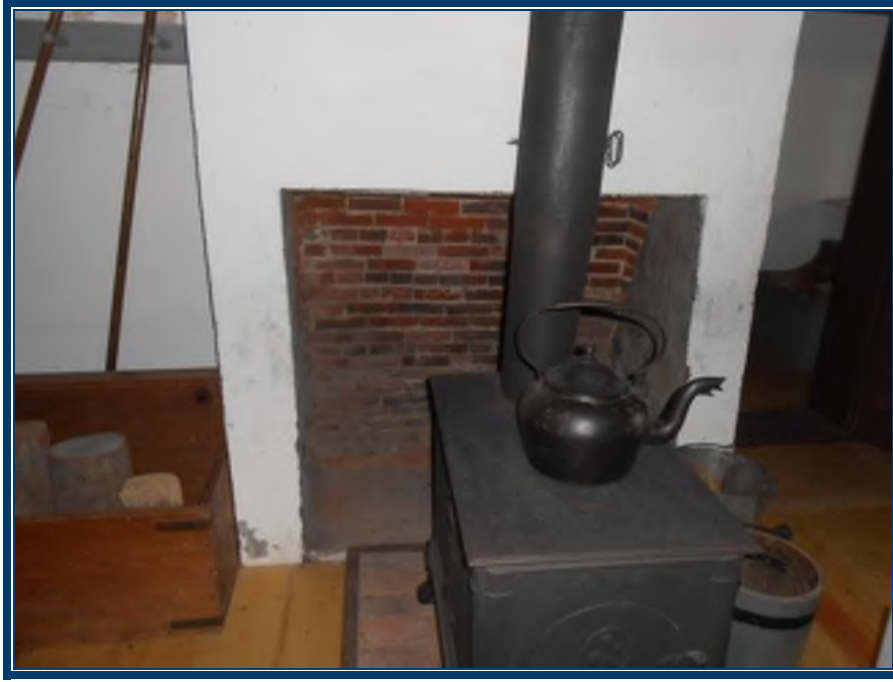
Photo 73: Murs en plâtre ciment sur briques au rez-de-chaussée et cheminée Murs en plâtre ciment (TPSGC-LENNOX-CORPS-RDC-MUR-P/C-2G) – ne contiennent pas d’amiante Mortier de brique (TPSGC-LENNOX-CORPS-RDC-MORTIER-BRIQUE-1A-I) – ne contient pas d’amiante
