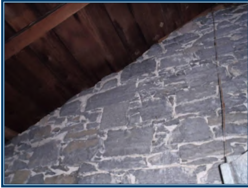
Photo 63: Grenier, vue de la structure en bois du bâtiment et des murs en pierre et mortier Mortier de pierre des murs (TPSGC-LENNOX-CASERNE-MUR-MORTIER INT-1A-I) – ne contient pas d’amiante
