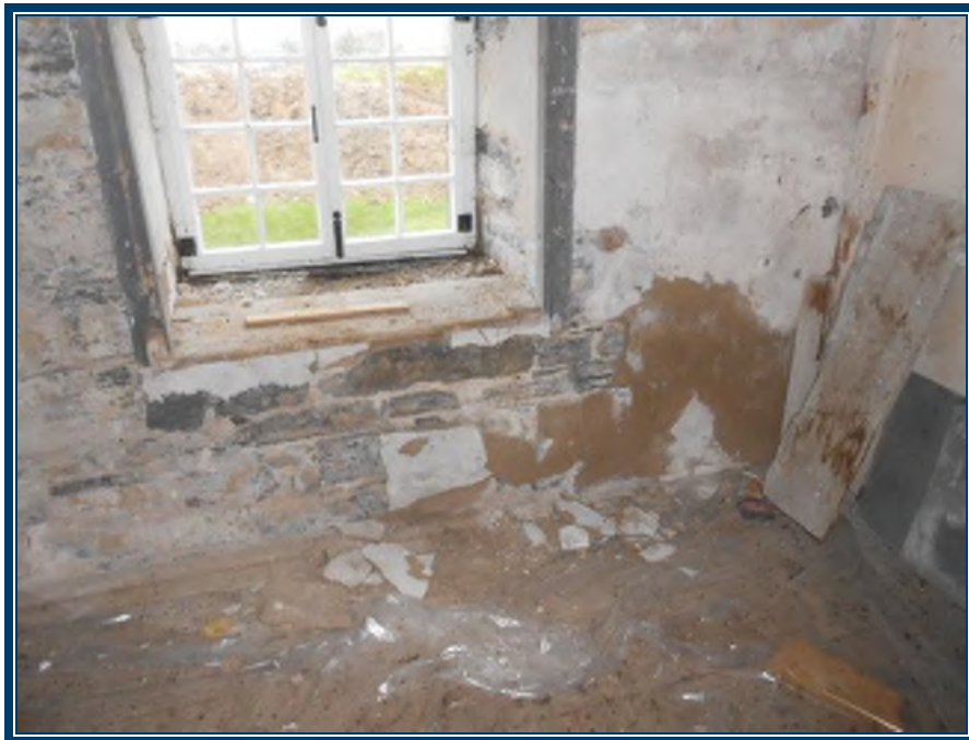
Photo 90: 2 e étage Plâtre ciment au niveau des murs en mauvais état et présence de débris (TPSGC-LENNOX-CORPS-ETAGE-MUR-P/C-4A) – contient 0,1-1% d’amiante de type chrysotile
