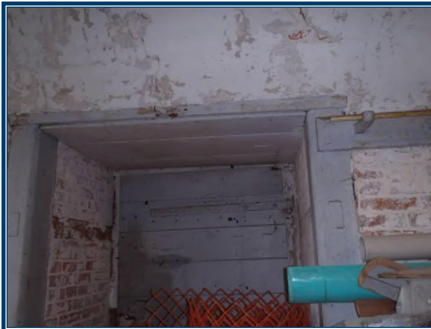
Photo 56: Rez-de-chaussée, entrepôt (local 115) Plâtre ciment des murs/plafonds en mauvais état (TPSGC-LENNOX-CASERNE-RDC-MUR-P/C-8A-I) – contient 0,1-1% d’amiante de type chrysotile dans la phase composé à joints Mortier de brique (TPSGC-LENNOX-CASERNE-RDC-MORTIER-BRIQUE-MUR-4A-D) – contient 0,1-1% d’amiante de type chrysotile dans la phase composé à joints
