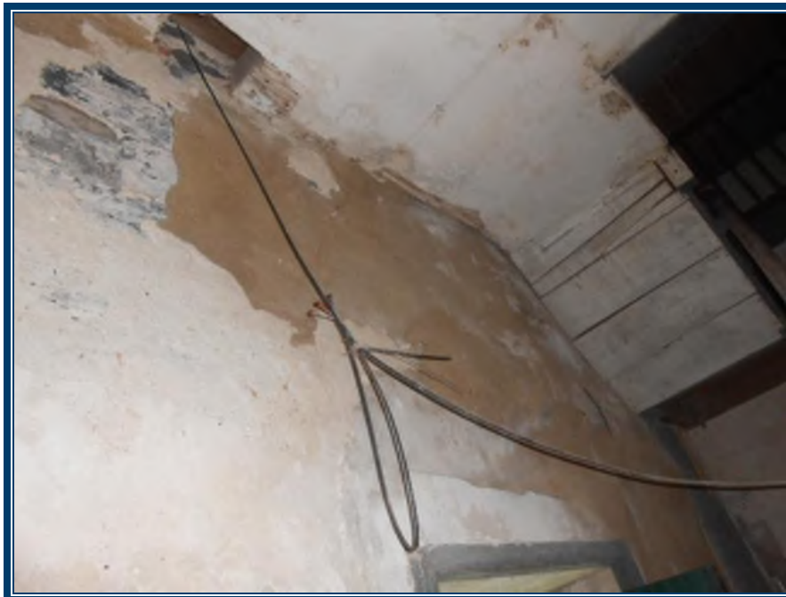
Photo 82: Murs en plâtre ciment au rez-de-chaussée, local 104 Murs en plâtre ciment (TPSGC-LENNOX-CORPS-RDC-MUR-P/C-2G) – ne contiennent pas d’amiante Mortier de brique (TPSGC-LENNOX-CORPS-RDC-MORTIER-BRIQUE-1A-I) – ne contient pas d’amiante
