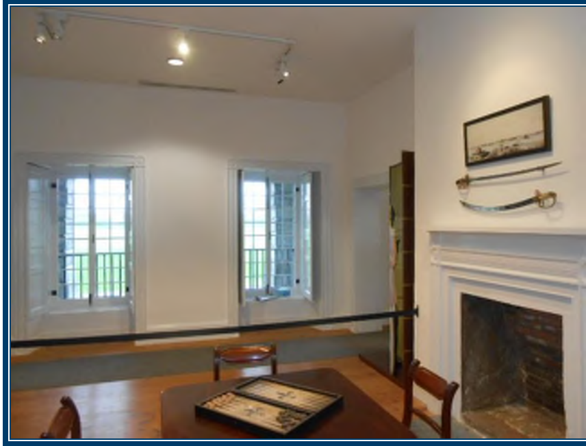
Photo 29: Rez-de-chaussée, vue générale Murs en plâtre ciment (TPSGC-LENNOX-OFFICIERS-RDC-MUR-P/C-6A-I) – contient 0,1-1% d’amiante de type chrysotile dans la phase ciment Plafond en gypse
