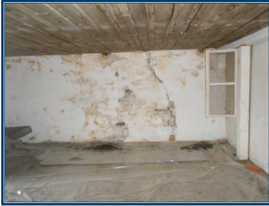
Photo 89: 2 e étage Plâtre ciment au niveau des murs en mauvais état (TPSGC-LENNOX-CORPS-ETAGE-MUR-P/C-4A) – contient 0,1-1% d’amiante de type chrysotile
