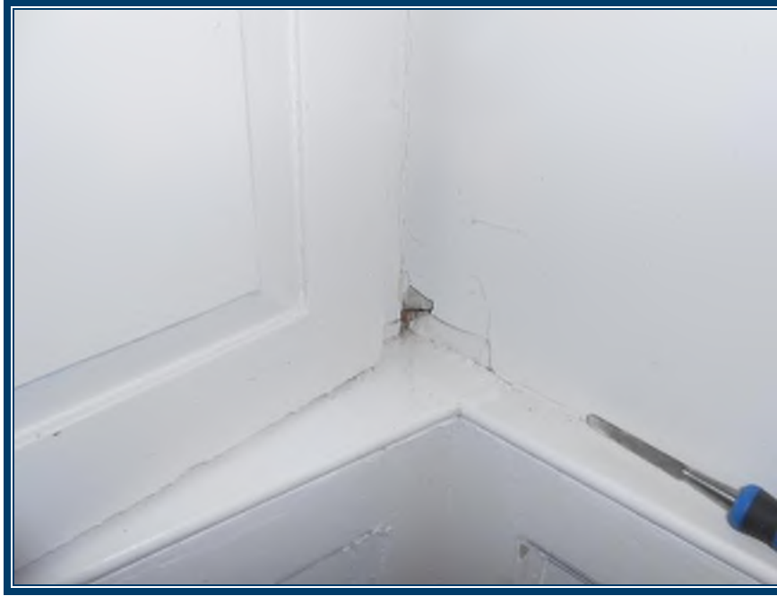
Photo 13: Étage Plâtre ciment au niveau des murs (TPSGC-LENNOX-OFFICIERS-ETAGE-MUR-P/C-1A-I) - contient 0,1-1% d'amiante de type chrysotile
