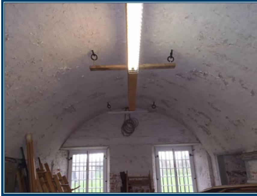
Photo 55: Rez-de-chaussée, entrepôt (local 115) Plâtre ciment des murs/plafonds en mauvais état (TPSGC-LENNOX-CASERNE-RDC-MUR-P/C-8A-I) – contient 0,1-1% d’amiante de type chrysotile dans la phase composé à joints Mortier de brique (TPSGC-LENNOX-CASERNE-RDC-MORTIER-BRIQUE-MUR-4A-D) – contient 0,1-1% d’amiante de type chrysotile dans la phase composé à joints
