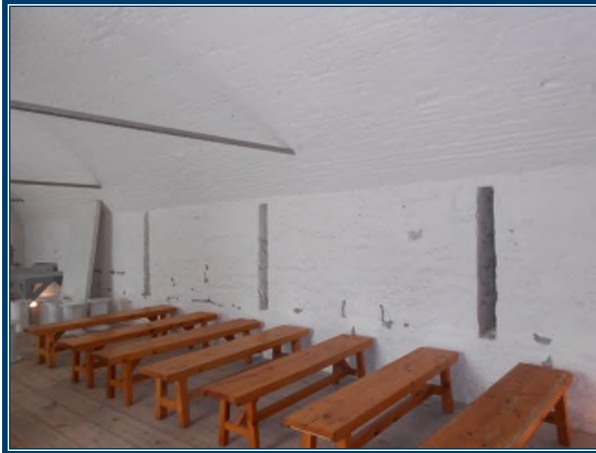
Photo 33: Rez-de-chaussée Murs et plafond (arche) au rez-de-chaussée en pierre recouvertes de plâtre ciment Plâtre ciment (TPSGC-LENNOX-MAG SUD-RDC-P/C-1A-I) – ne contient pas d’amiante Plancher de bois
