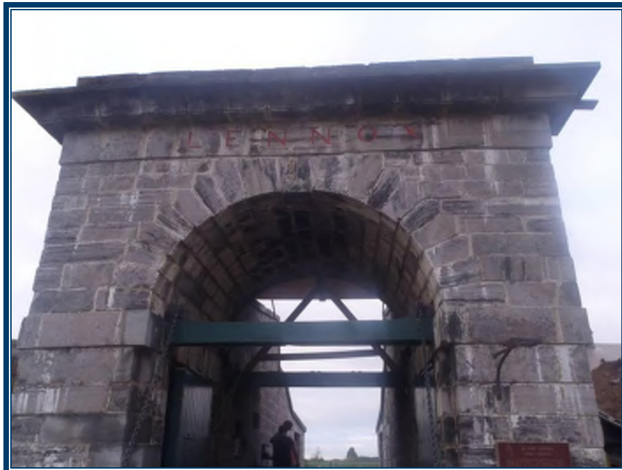
Photo 100: Vue générale de la porte et du passage Nord Peinture verte appliquée sur certains éléments de la porte
