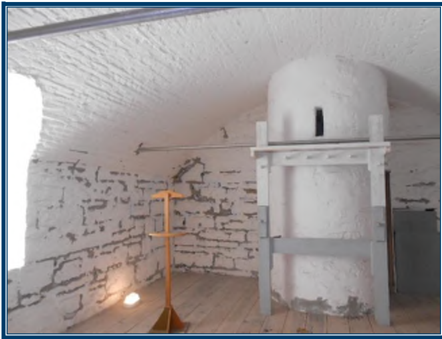
Photo 36: Rez-de-chaussée Plâtre ciment sur pierres au niveau de la tour composant la cage d’escalier (TPSGC-LENNOX-MAG SUD-RDC-P/C-1A-I) – ne contient pas d’amiante
