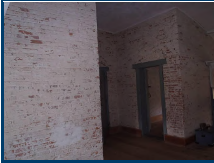
Photo 65: Étage, vue générale au centre de l'étage Mortier de brique (TPSGC-LENNOX-CASERNE-RDC-MORTIER-BRIQUE-MUR-4E-I) – contient 0,1-1% d'amiante de type chrysotile dans la phase composé à joints
