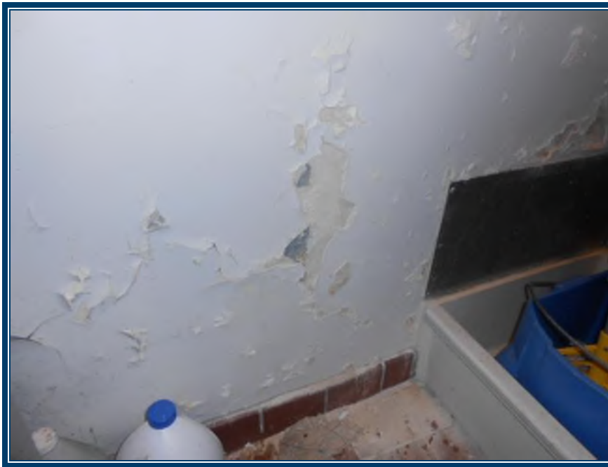
Photo 26: Rez-de-chaussée Mur en plâtre ciment en mauvais état et débris dans la conciergerie (TPSGC-LENNOX-OFFICIERS-RDC-MUR-P/C-6A-I) – contient 0,1-1% d'amiante de type chrysotile dans la phase ciment
