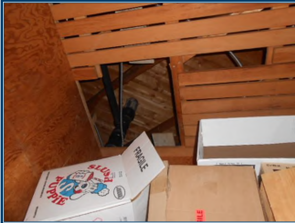
Photo 125: Plafond du rangement en lattes de bois Tuyauterie non isolée
