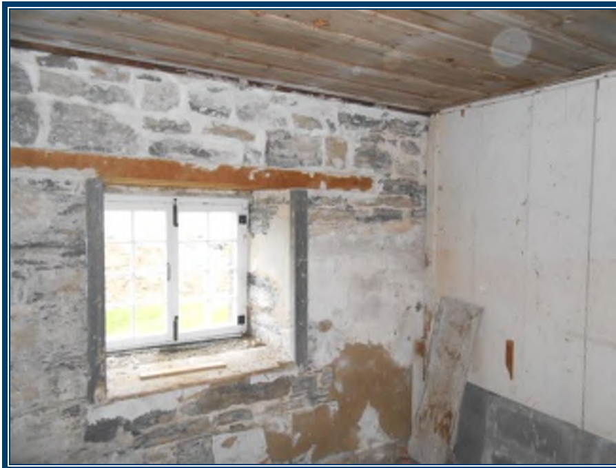
Photo 88: 2 e étage Mortier de pierre (TPSGC-LENNOX-CORPS-EXT-MORTIER-5A-I) - ne contient pas d’amiante Plâtre ciment (TPSGC-LENNOX-CORPS-ETAGE-MUR-P/C-4A) – contient 0,1-1% d’amiante de type chrysotile
