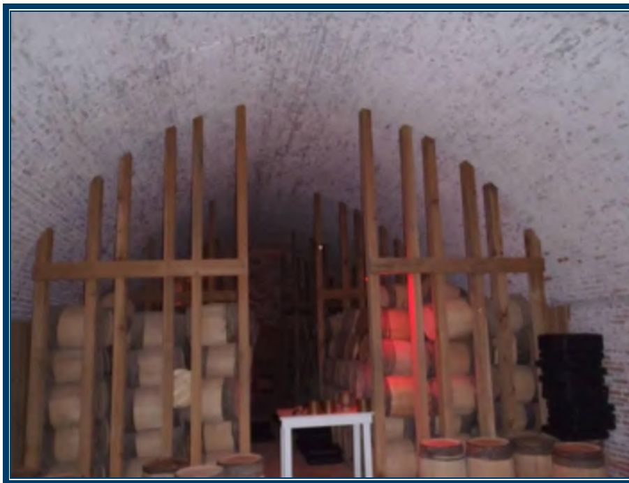
Photo 94: Murs/plafond en briques et mortier- arche (TPSGC-LENNOX-POUDRIERE-MUR-MORTIER BRIQUE-1A-I) – ne contient pas d’amiante
