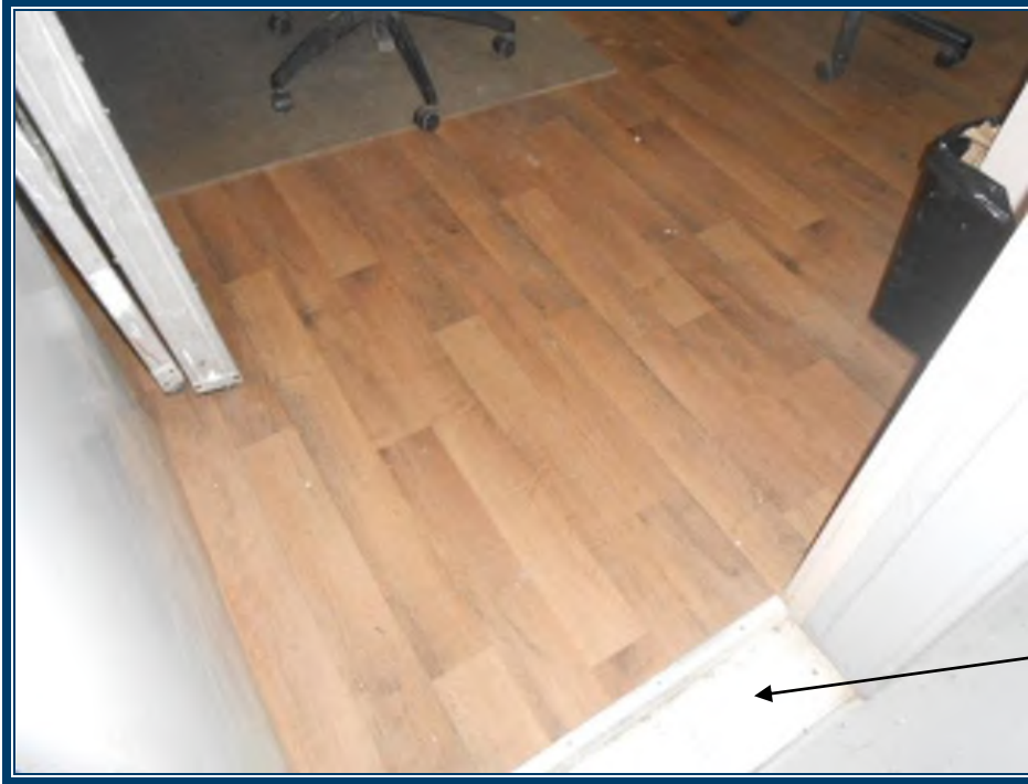
Photo 113: Plancher flottant de la salle de repos/bureau Tuiles de vinyle blanc au plancher à l'entrée du local et possiblement sous le plancher flottant (TPSGC-LENNOX-GARAGE-AT-PL-TV-4) – ne contiennent pas d'amiante
