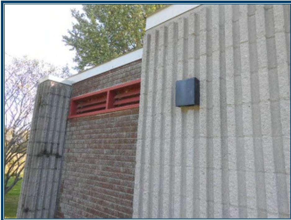
Photo 110: Vue de l'extérieur du bâtiment Murs en blocs de béton nervurés et mortier (TPSGC-LENNOX-TOILETTES-MORTIER EXT-1A) – ne contient pas d'amiante
