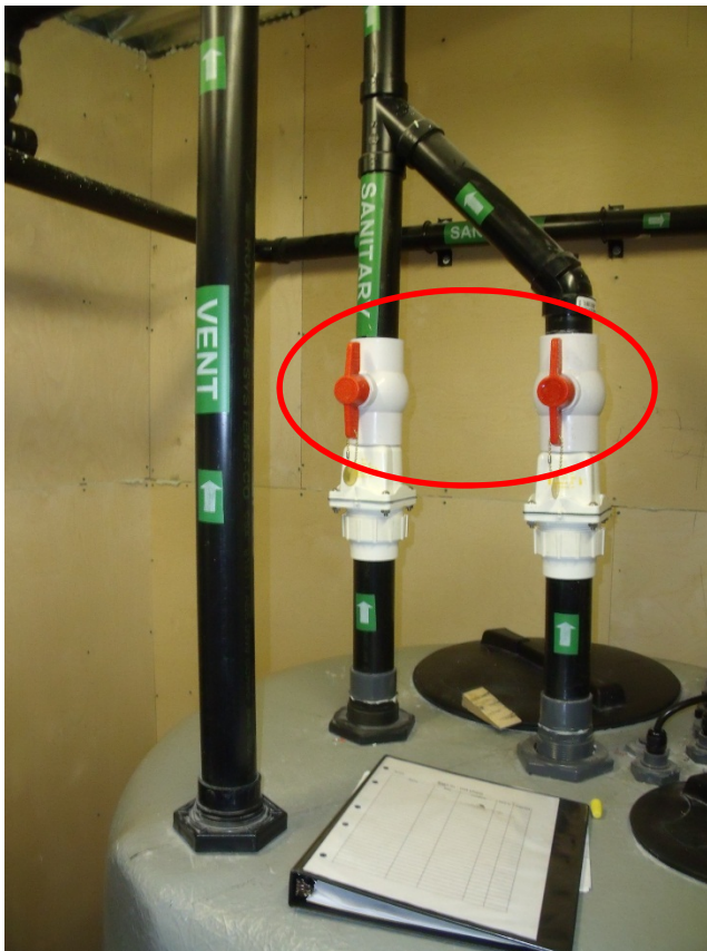
Robinets sur la canalisation des eaux usées en position ouverte
