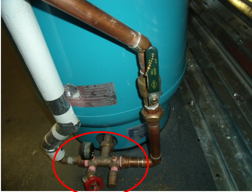
Drain et robinet de vidange du réservoir de stockage d'eau sous pression
