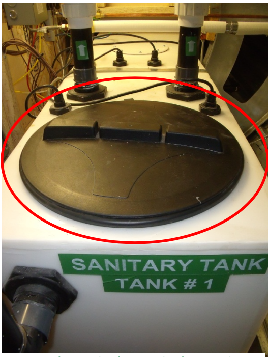
Trappe supérieure du réservoir de rétention des eaux usées
