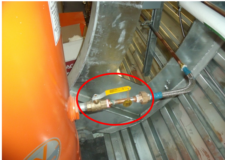
Robinet sur la canalisation d'air en position ouverte
