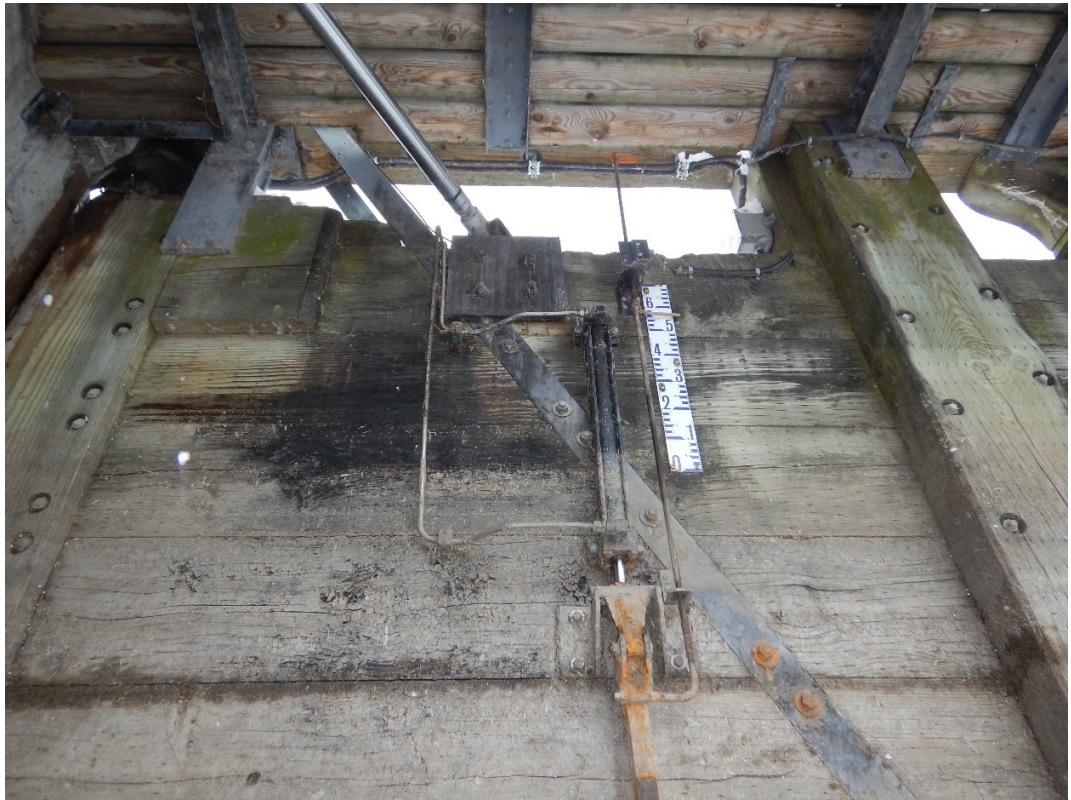
Photo n° 13 Porte #1 - Vérin de vanne guillotine (DSCN7173.jpg).
