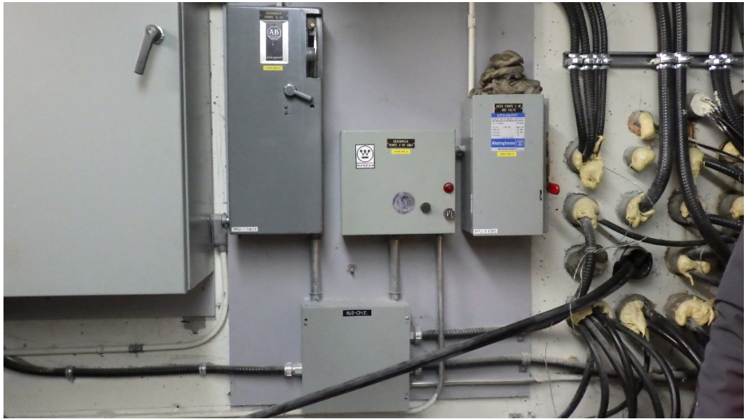
Photo n° 5 Salle Électrique de l'écluse #9 – partie centrale du mur Ouest (RIMG2870.jpg).
