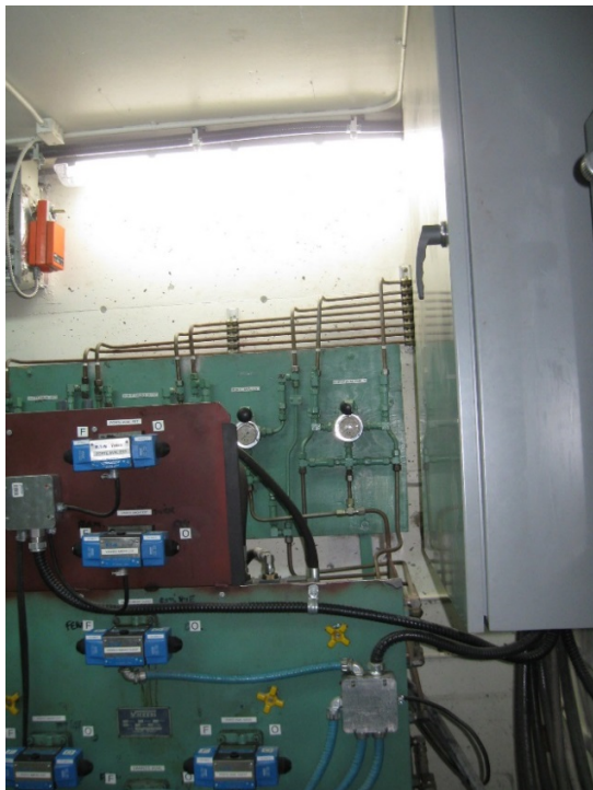
Photo n° 8 Salle Électrique de l'écluse #9 – vue vers le Sud (IMG_0503.jpg).
