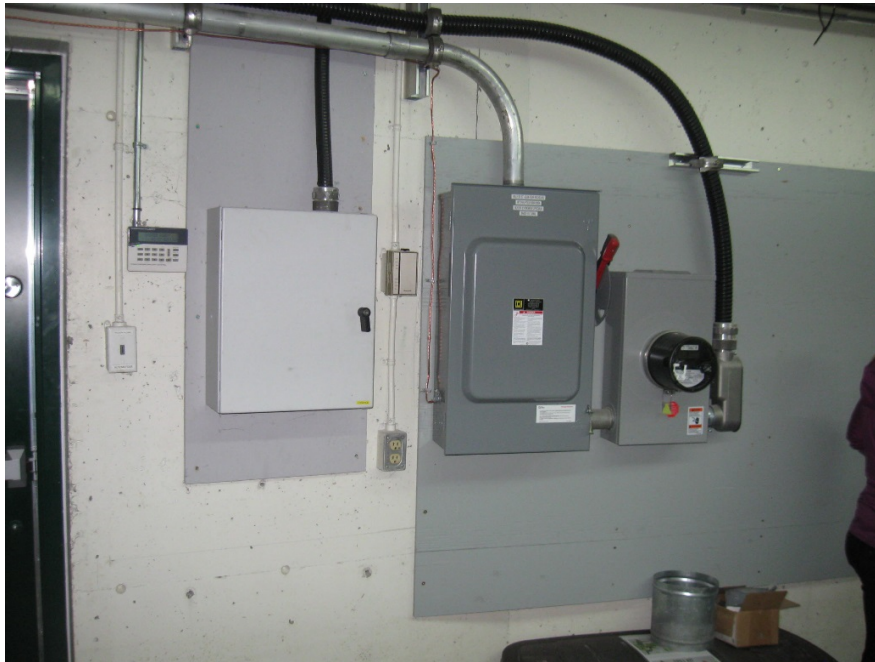
Photo n° 9 Salle Électrique de l'écluse #9 – mur le Sud près de la porte (IMG_0503.jpg).
