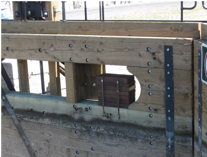
Photo n° 21 – Exemple de plaques en acier pour lester les portes amont de l'écluse #7 (IMG_2134.jpg).
