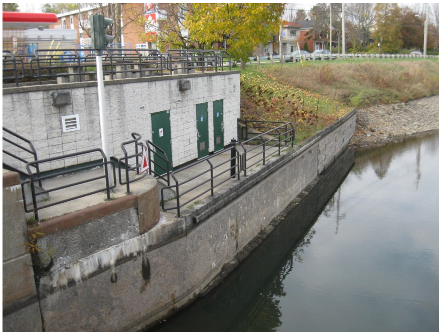
Photo n° 10 Salle Électrique de l'écluse #9 – première porte au pied de l'escalier (IMG_0459.jpg).
