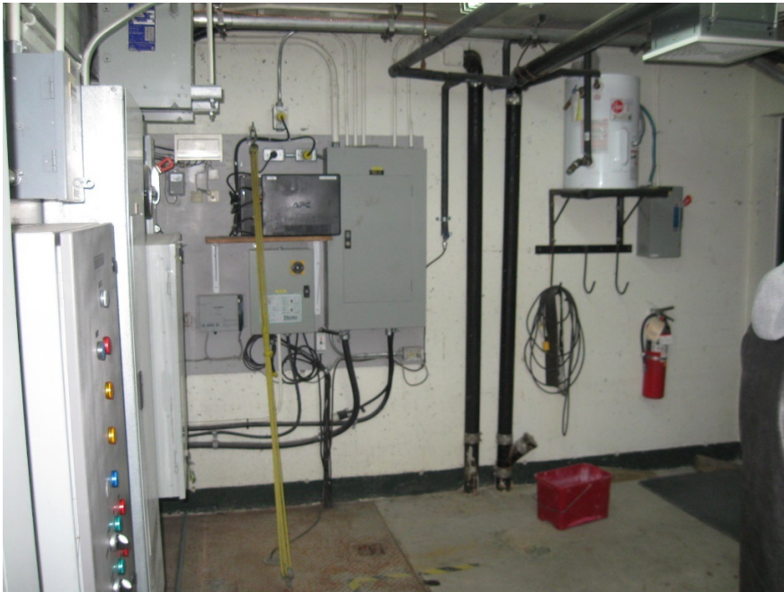
Photo n° 3 Salle Électrique de l'écluse #9 – mur Nord (IMG_0499.jpg).
