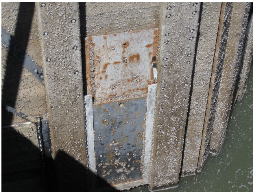
Photo n° 22 - Exemple de plaques en acier pour lester les portes amont de l'écluse #7 (IMG_2137.jpg).
