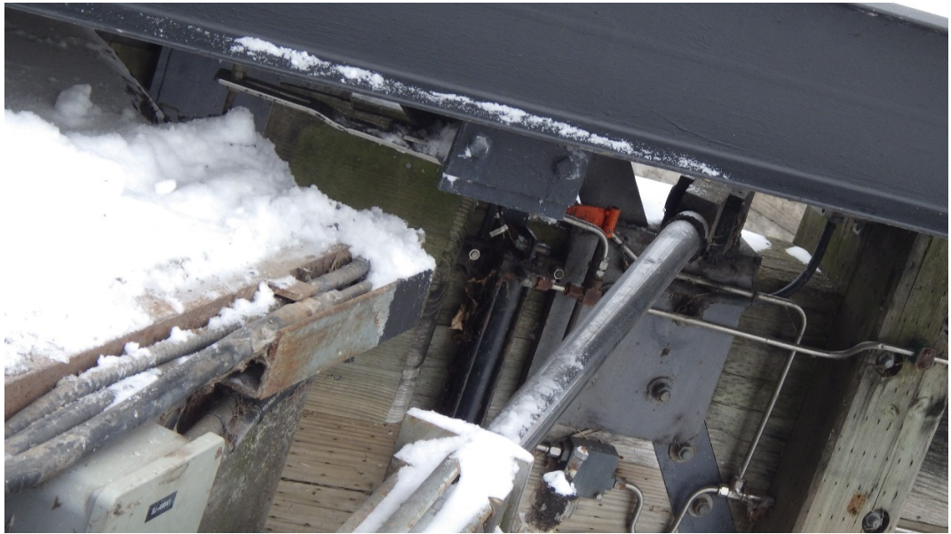
Photo n° 11 Porte #4 – vérin de porte (RIMG2845.jpg).
