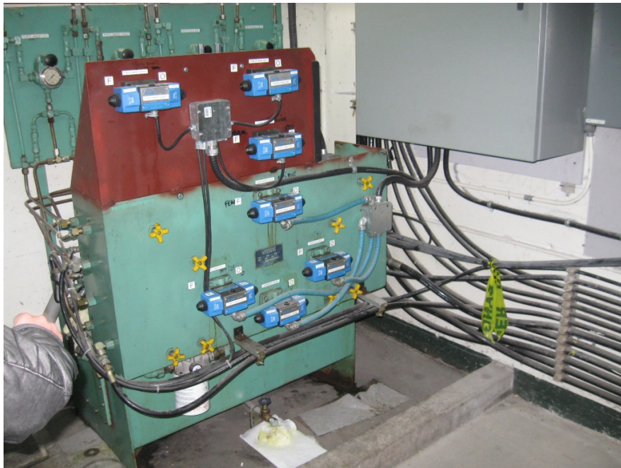
Photo n° 6 Salle Électrique de l'écluse #9 – jonction du mur Sud avec le mur Ouest (IMG_0498.jpg).
