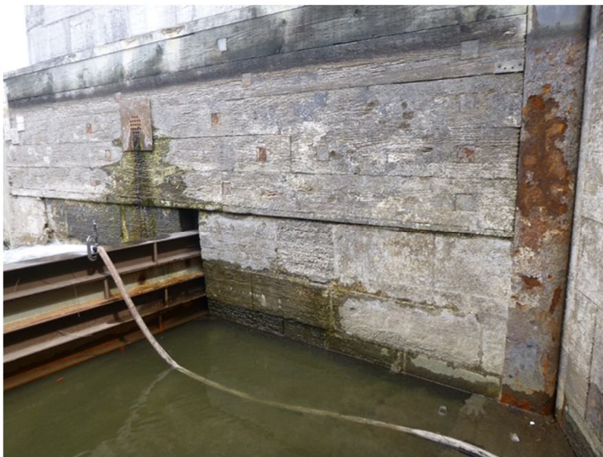
Photo n° 18 Exemple de batardeau mis en place en 2018 par l'APC en aval des portes aval de l'écluse #9 (photo APC).
