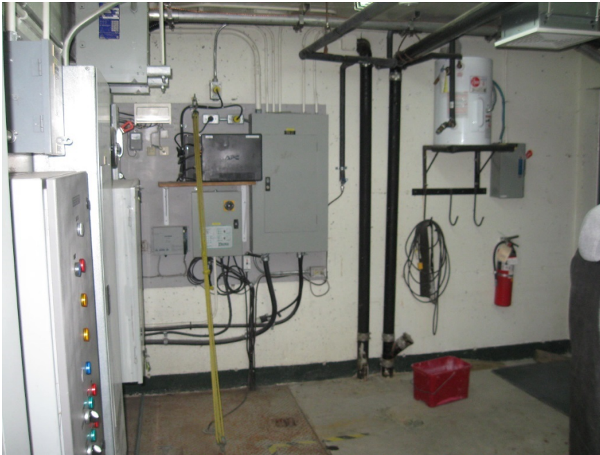
Photo n° 3 Salle Électrique de l'écluse #9 – mur Nord (IMG_0499.jpg).
