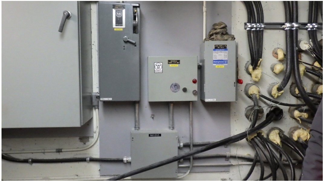
Photo n° 5 Salle Électrique de l'écluse #9 – partie centrale du mur Ouest (RIMG2870.jpg).
