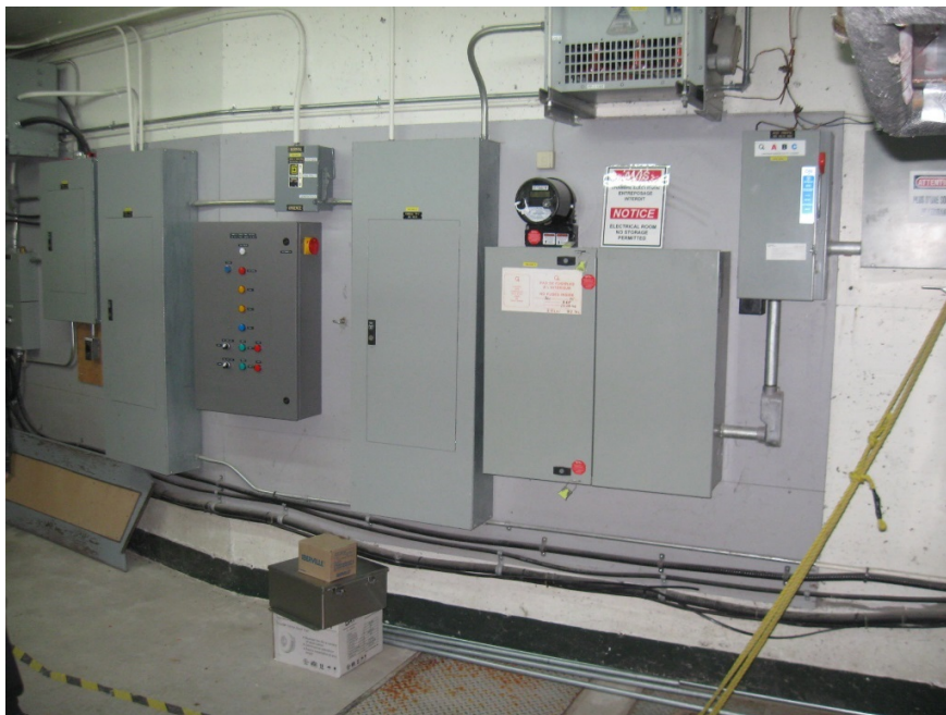
Photo n° 4 Salle Électrique de l'écluse #9 – mur Ouest à l'extrémité Nord (IMG_0500.jpg).
