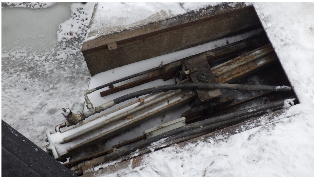
Photo n° 12 Porte #4 – vérin de porte (RIMG2843.jpg).
