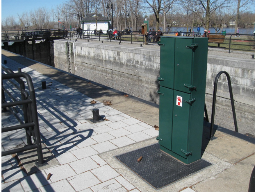
Photo n° 19 – Cabinet de contrôle des portes amont de l'écluse #9 (IMG_2200.jpg).
