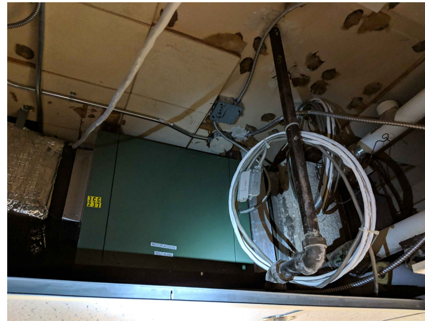
ROOM 1016 - EXISTING FAN COIL UNIT VENTILO CONVECTEUR EXISTANTE
