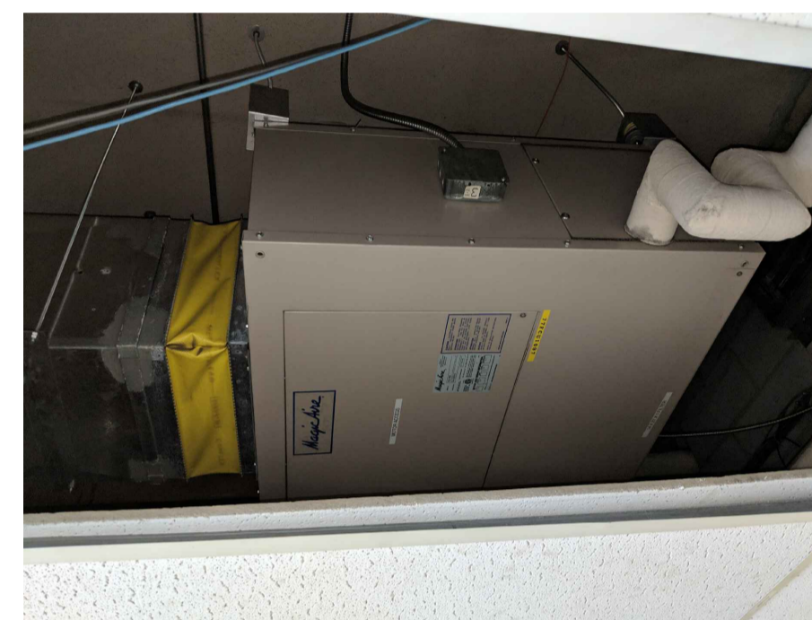
ROOM 1097 - EXISTING FAN COIL UNIT VENTILO CONVECTEUR EXISTANTE
