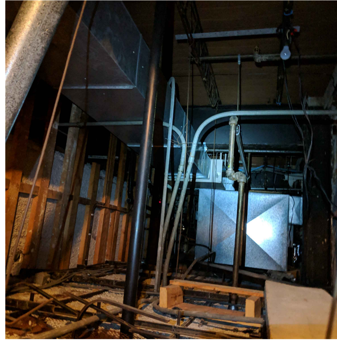
ROOM 1017 - EXISTING FAN COIL UNIT VENTILO CONVECTEUR EXISTANTE
