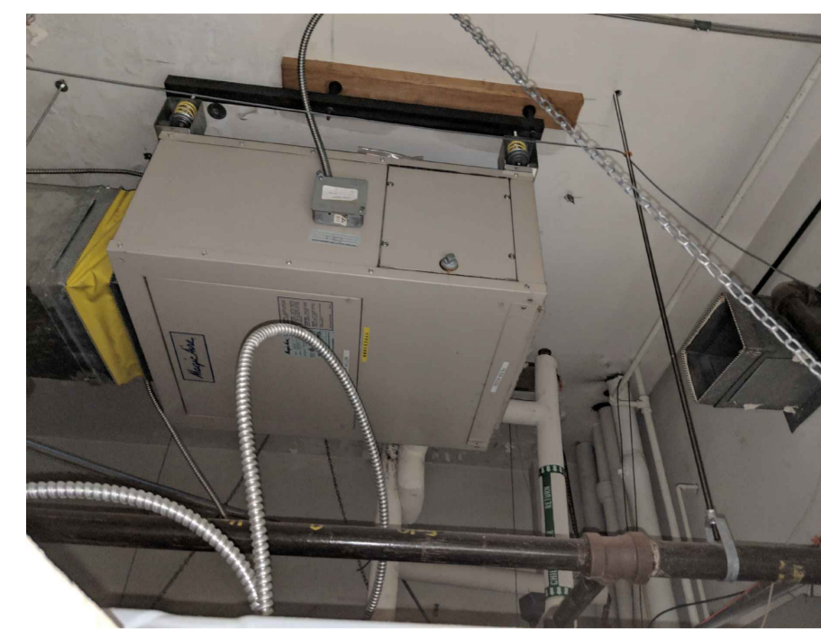
ROOM 1099 - EXISTING FAN COIL UNIT VENTILO CONVECTEUR EXISTANTE
