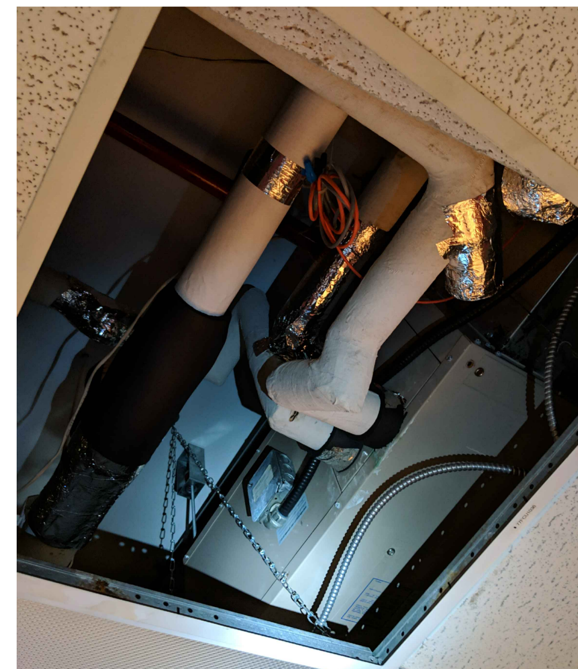
ROOM 1036 - EXISTING FAN COIL UNIT VENTILO CONVECTEUR EXISTANTE 3 M109 1:50
