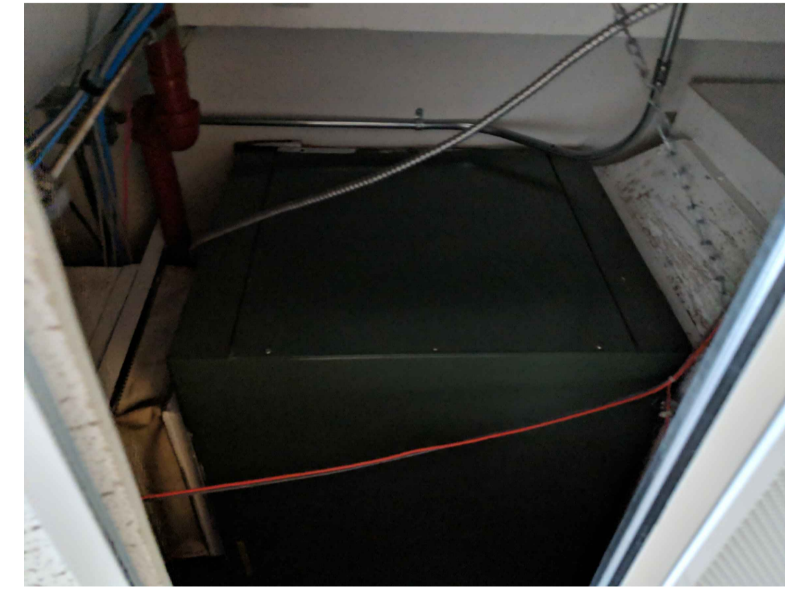
3 ROOM 1124 - EXISTING FAN COIL UNIT VENTILO CONVECTEUR EXISTANTE M111 1:50
