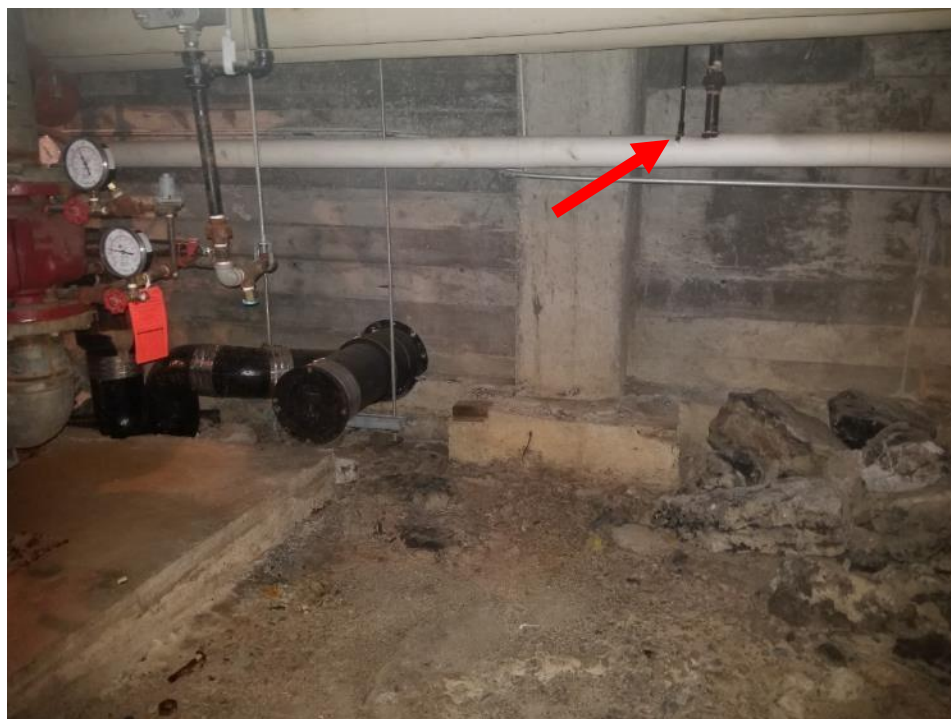
Photo 1. Sous-sol, vide sanitaire, <1 mètre carré d'isolant alvéolaire en mauvais état autour du support.
