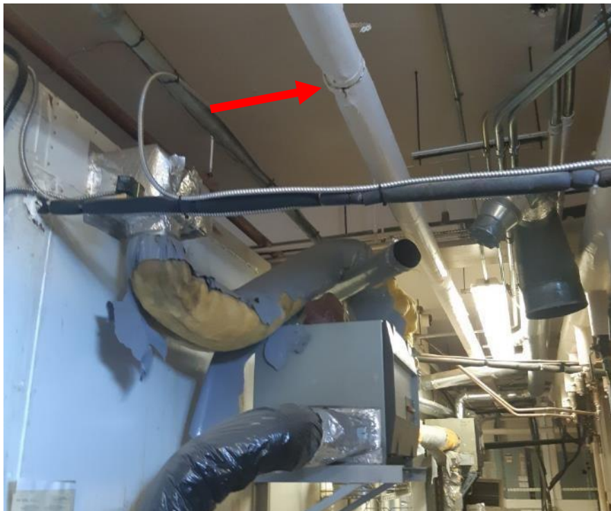
Photo 3. Sous-sol, lab. 15, le long du tuyau au-dessus du déshumidificateur sur le mur nord, <1 mètre linéaire d'isolant alvéolaire dans un état passable.
