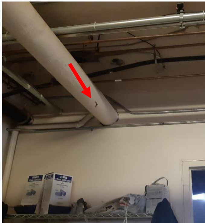
Photo 2. Sous-sol, lab. 12, mur nord du côté ouest de la pièce 14, <1 mètre carré d'isolant alvéolaire dans un état passable.
