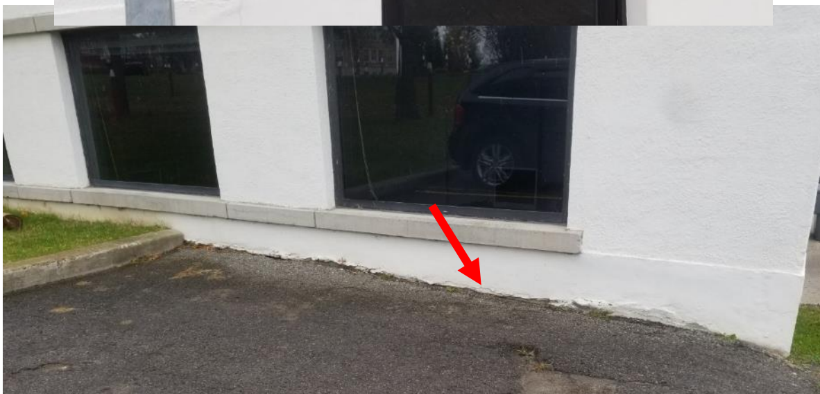
Photo 2. Extérieur, façade nord, 6 mètres linéaires du revêtement mural texturé en mauvais état.
