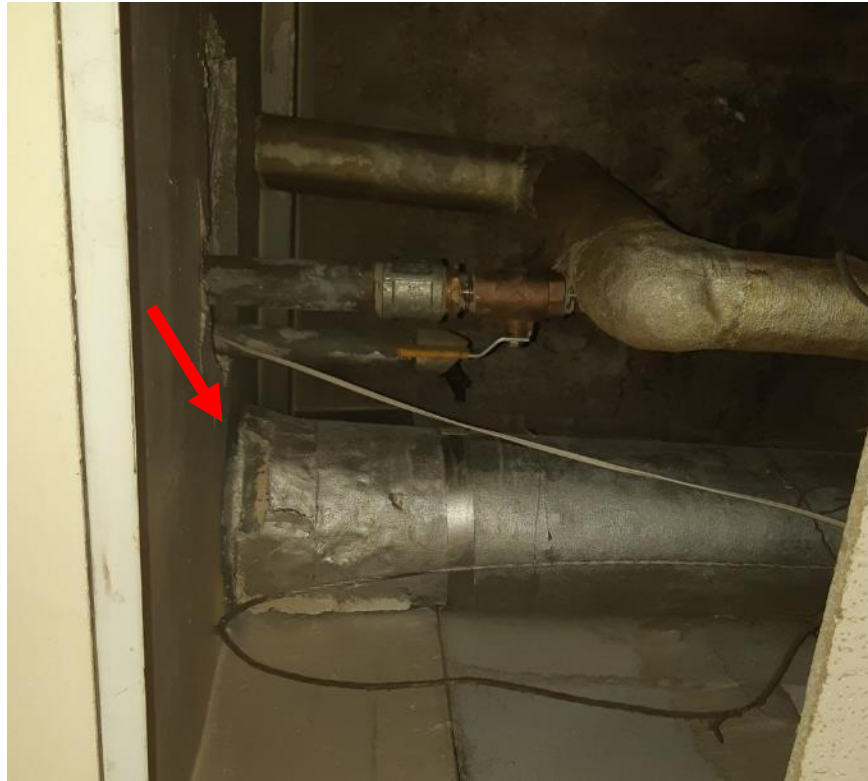
Photo 1. Sous-sol, corridor vers l'ascenseur, <1 mètre carré de blocs Magblock en mauvais état.
