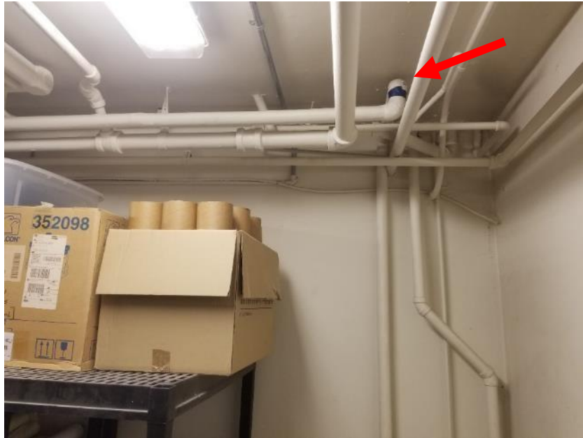
Photo 1. Sous-sol, aire d'entreposage, coin sud-est, un raccord en mauvais état.
