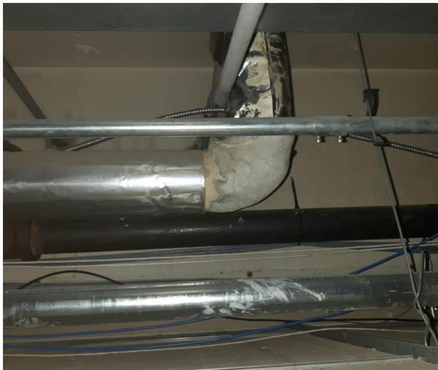
Photo 4. Sous-sol, corridor principal, devant le tuyau d'incendie en face de la pièce 102, un raccord de tuyau dans un état passable.
