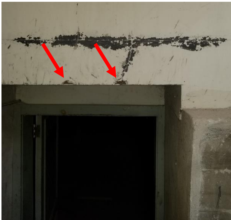
Photo 2. Escalier entre le sous-sol et le rez-de-chaussée, <1 mètre carré de fibrociment (Transite) sur le mur en mauvais état.
