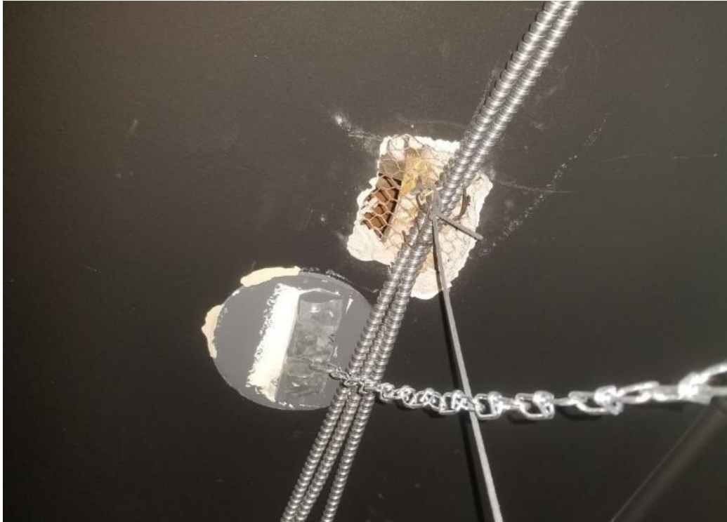
Photo 1. Sous-sol, B-4, <1 mètre carré de plâtre au plafond en mauvais état à l'emplacement de tous les supports.
