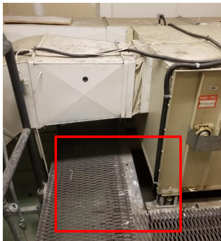
Photo 2. Mezzanine, au-dessus de la salle des chaudières, sur la passerelle, coin nord-est, 1 mètre carré de débris.
