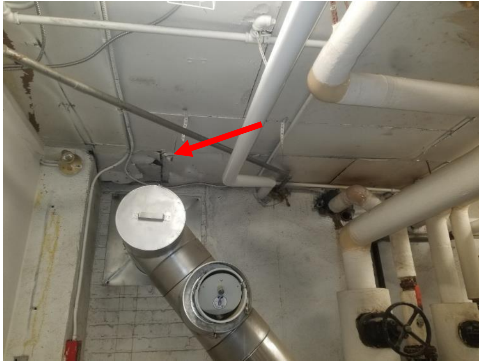
Photo 1. Sous-sol, salle des chaudières, mur ouest, 3 mètres carrés de fibrociment (Transite) au plafond en mauvais état.
