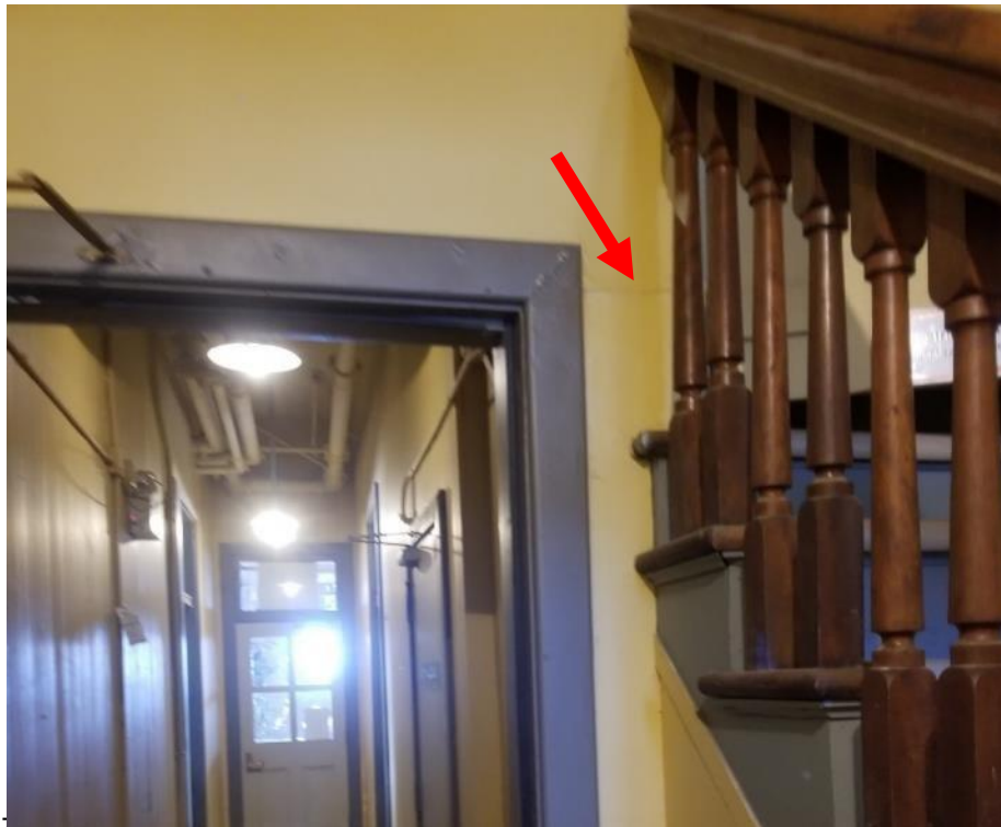
Photo 1. Rez-de-chaussée, corridor et vestibule, 21 mètres carrés de composé à joints à la droite de la porte, près de l'escalier, dans un état passable.
