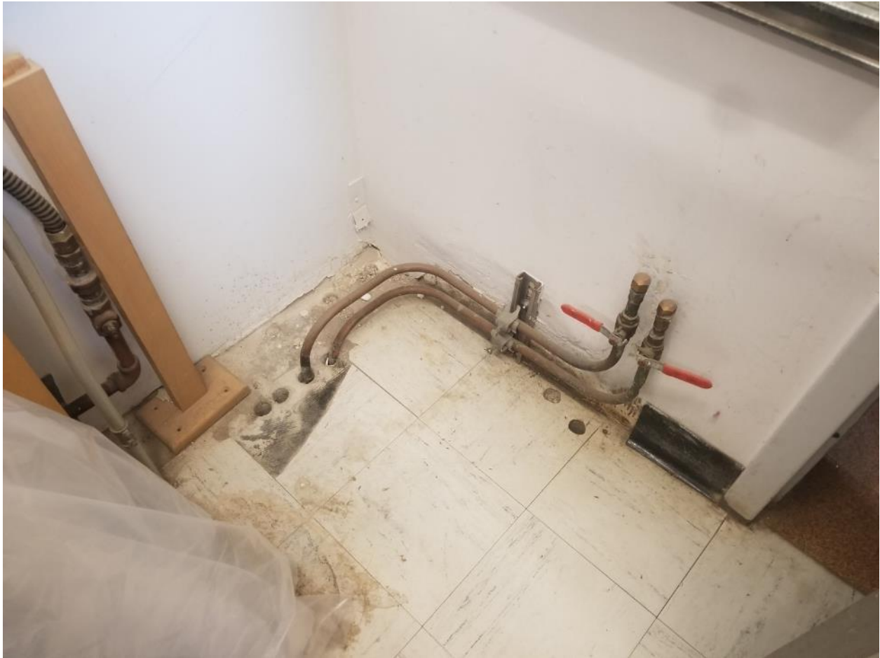
Photo 1. Premier étage, lab. EW-06, à côté de la porte sur le mur sud, 4 carreaux de plancher en vinyle dans un état passable.
