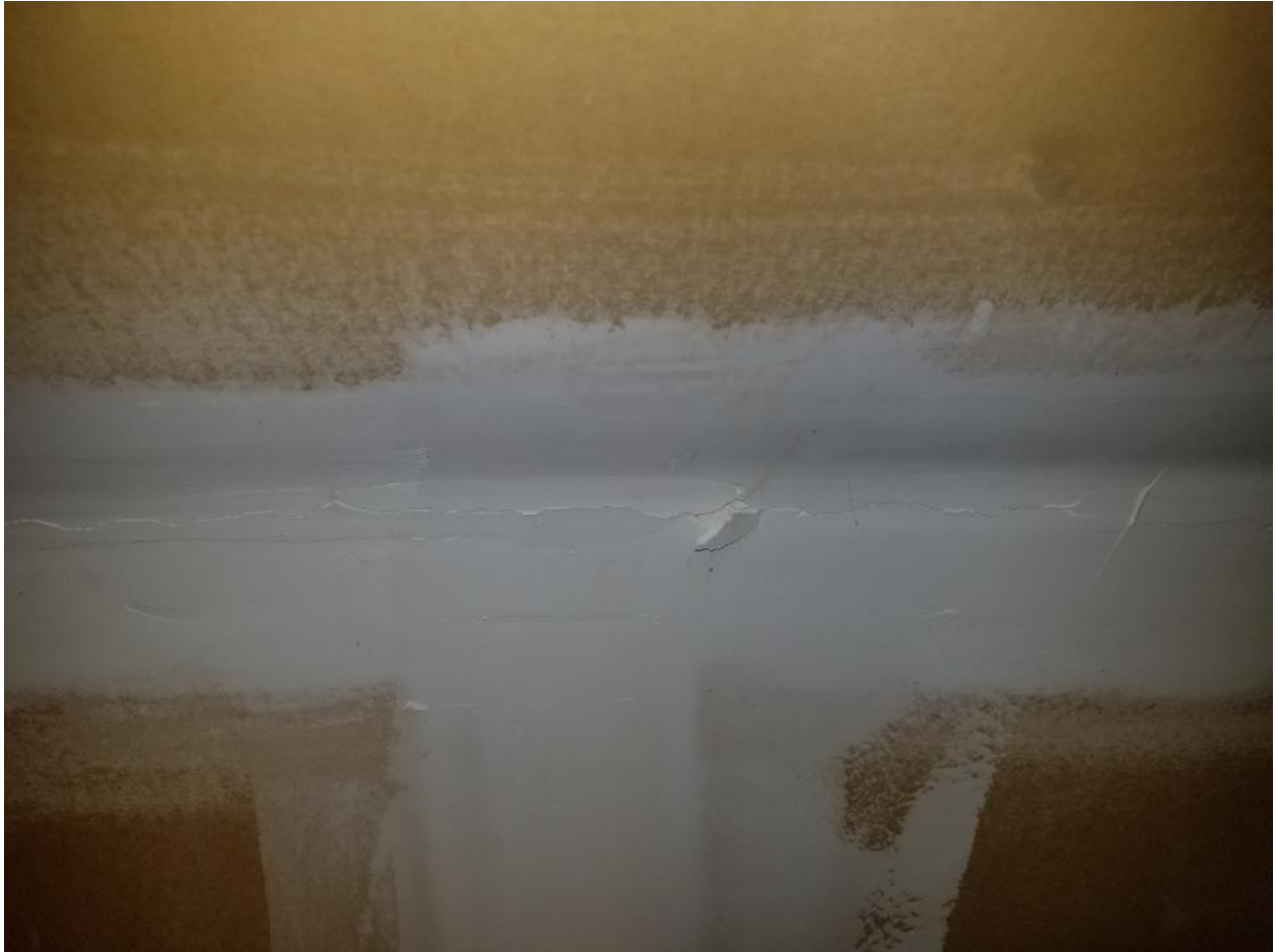
Photo 3. Comble, aire d'entreposage, pièce 3, 30 mètres linéaires de composé à joints dans un état passable au point de rencontre entre le mur incliné et le mur vertical.
