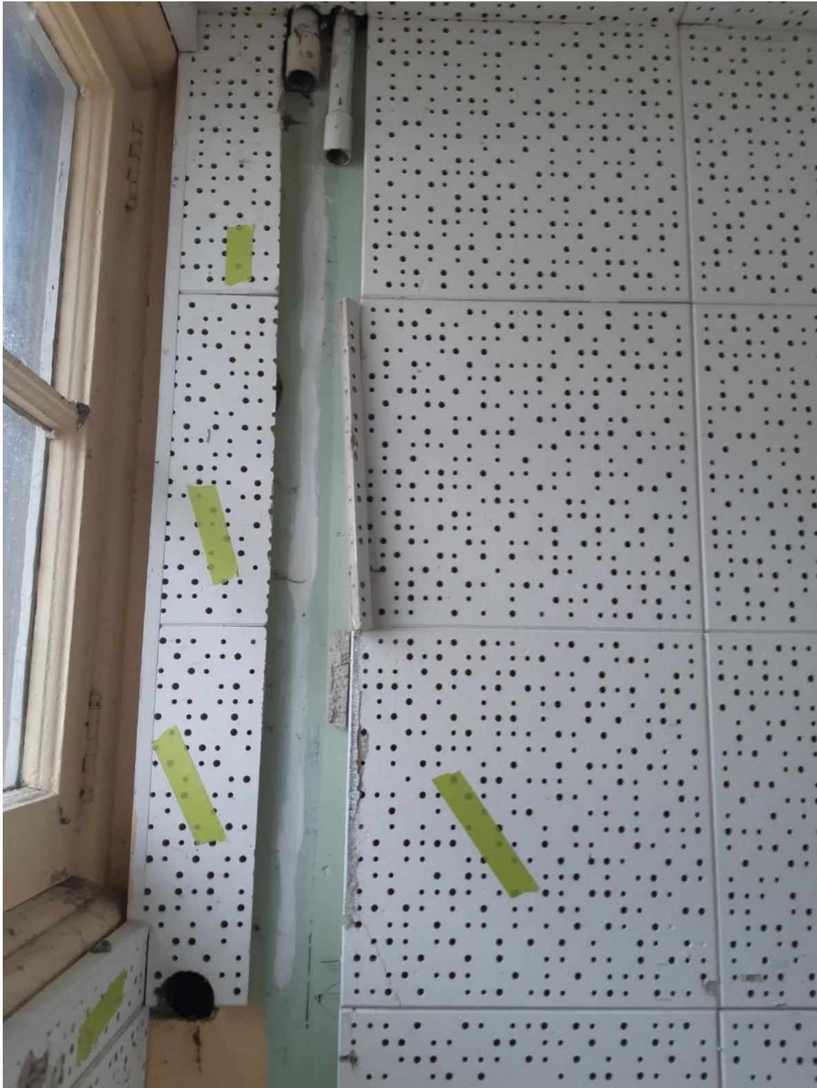
Photo 1. Rez-de-chaussée, bureau, carreaux insonorisants gris 1 pi x 1 pi en mauvais état sur tous les murs.
