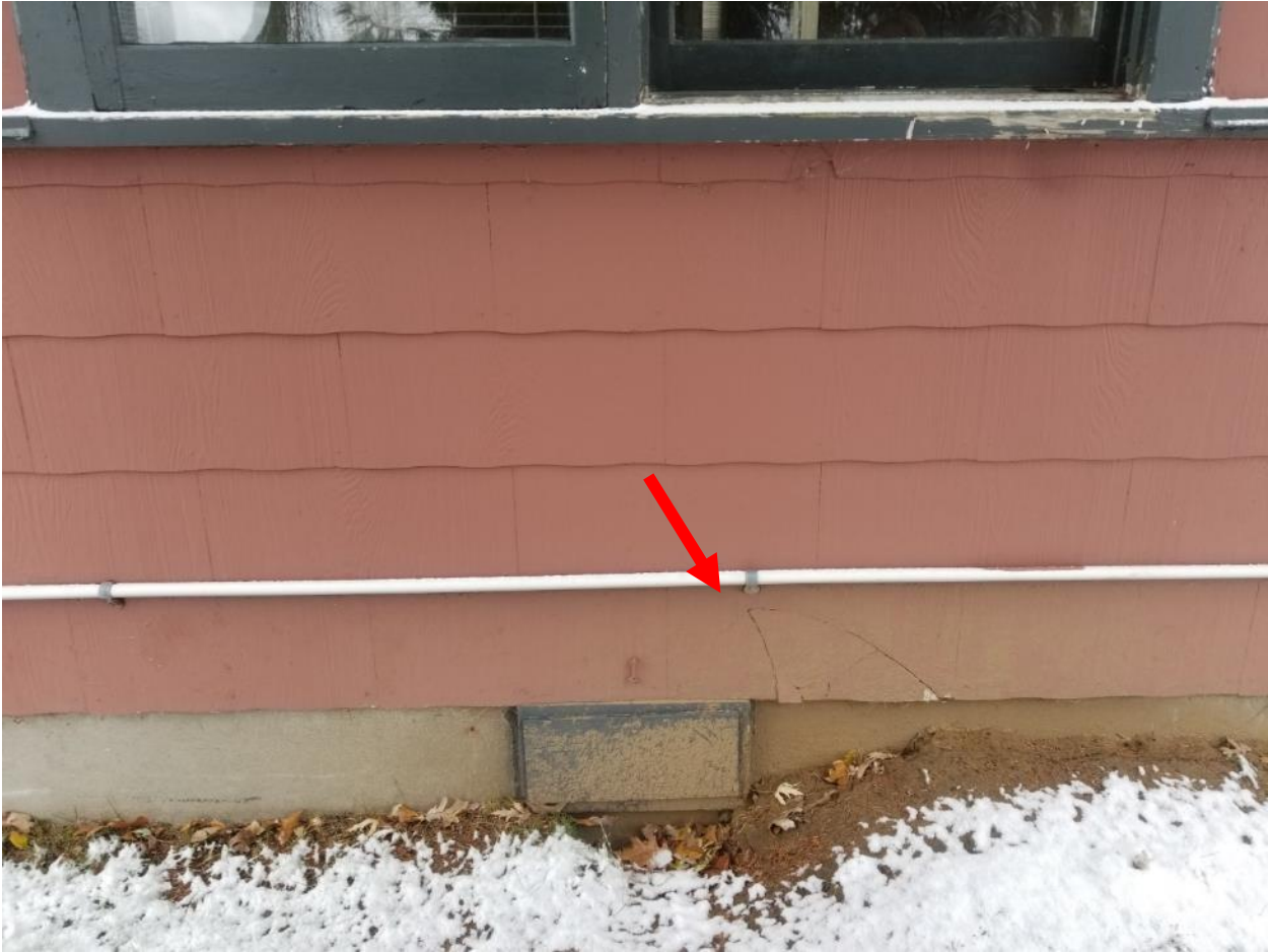
Photographies de matériaux endommagés contenant de l'amiante Ferme expérimentale centrale, Ottawa, Ontario
