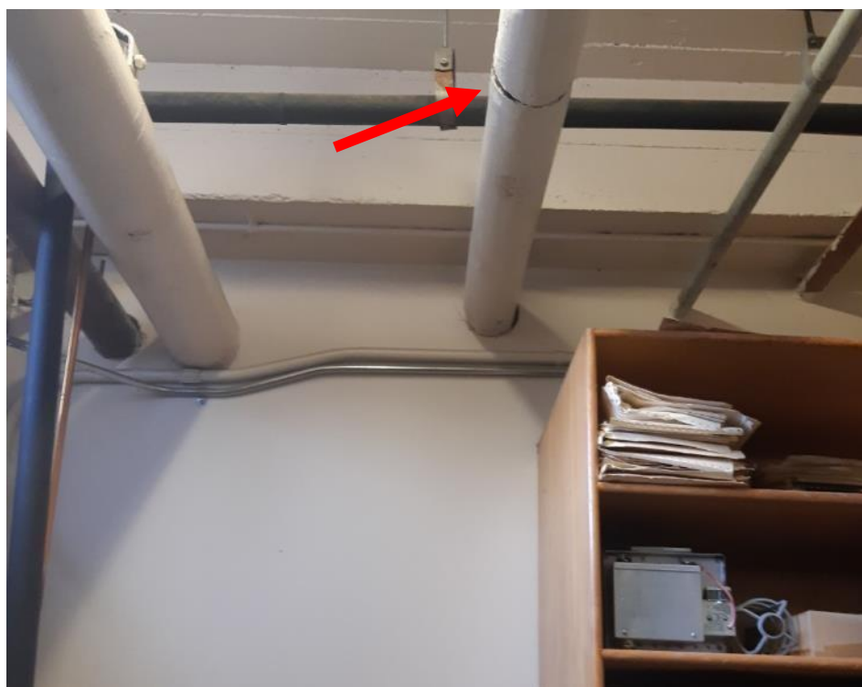
Photo 4. Sous-sol, lab. 15, le long du tuyau au-dessus du déshumidificateur sur le mur nord, <1 mètre linéaire d'isolant alvéolaire dans un état passable.
