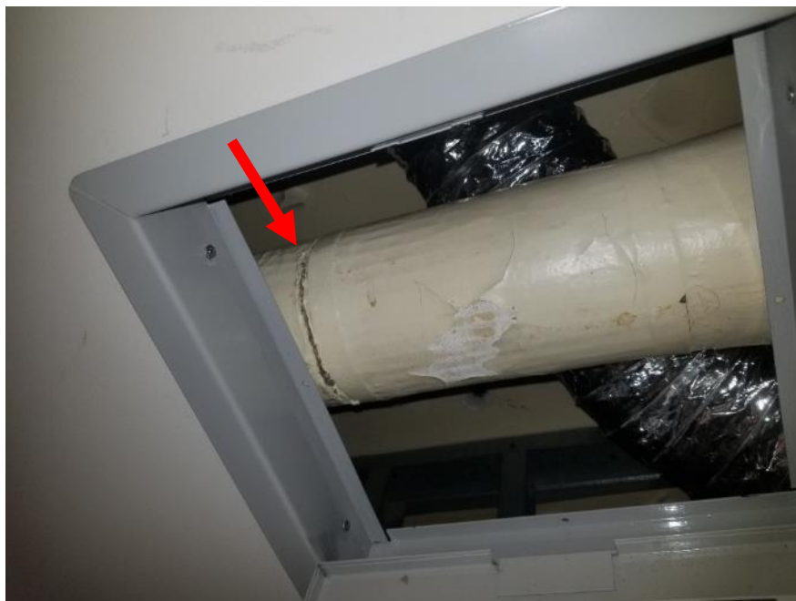
Photo 2. Sous-sol, salle de bain des hommes, trappe au plafond, <1 mètre linéaire d'isolant thermique à tuyau dans un état passable.
