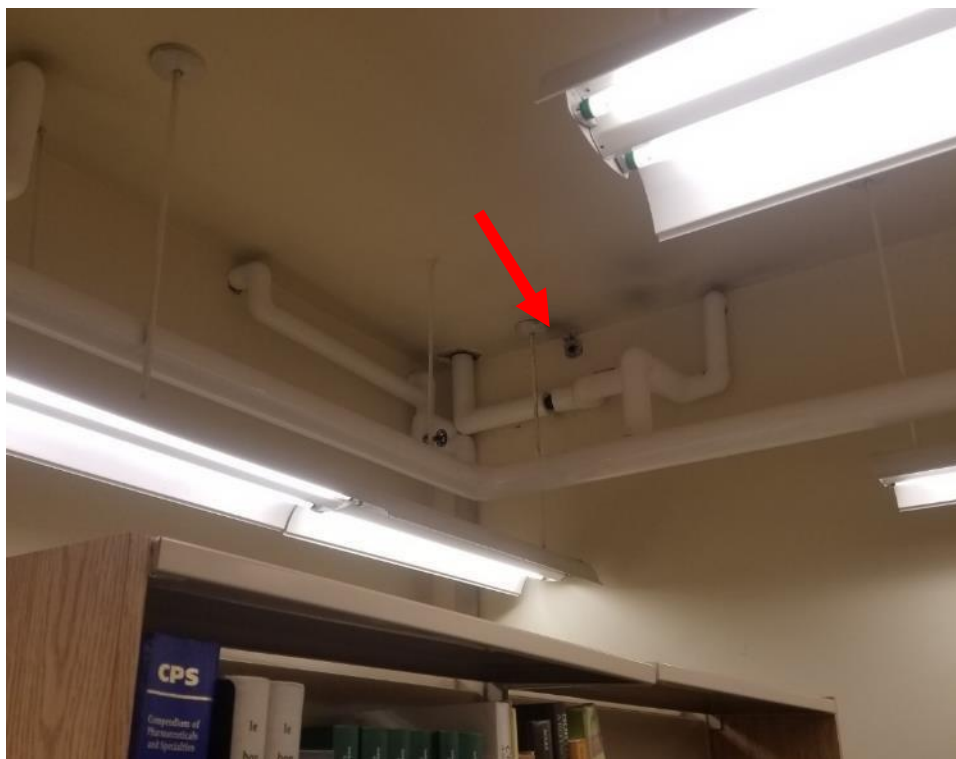
Photo 8. Sous-sol, bureau 114, mur est dans le coin nord-est, <1 mètre carré d'isolant alvéolaire en mauvais état à la percée d'un tuyau dans le mur.
