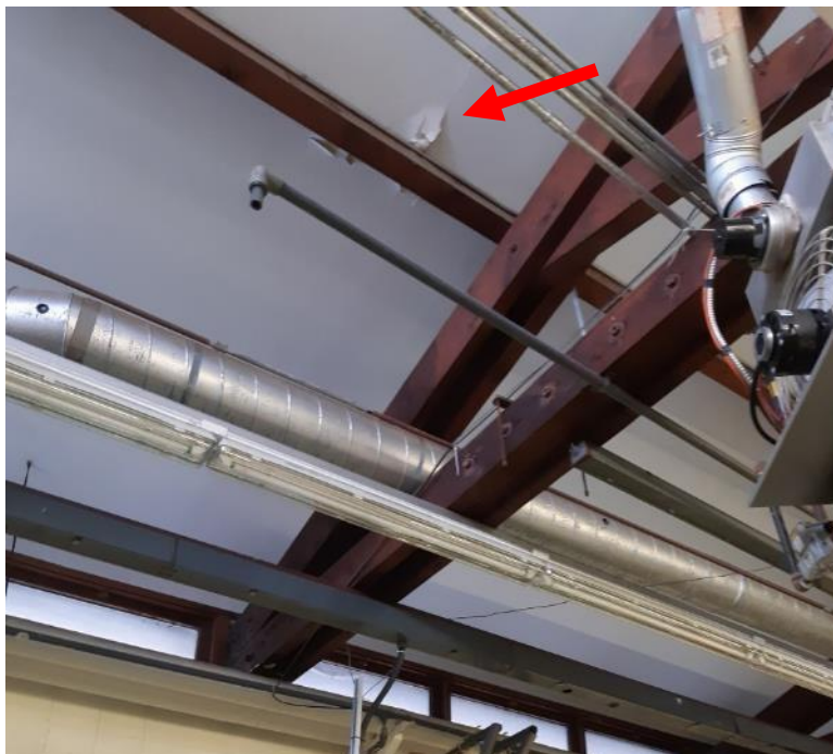
Photo 2. Rez-de-chaussée, pièce 1, au-dessus du module de croissance n° 17, 1 mètre carré de composé à joints en mauvais état.
