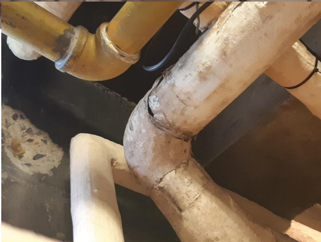
Photo 8. Sous-sol, local technique, mur ouest, un raccord dans un état passable.
