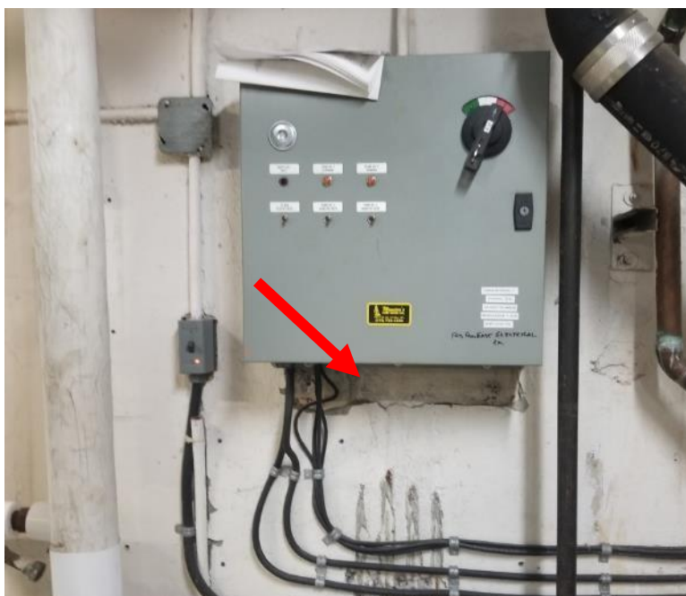
Photo 2. Sous-sol, B-6, autour du panneau d'urgence A sur le mur ouest, 1 mètre carré de plâtre texturé sur le mur en mauvais état.
