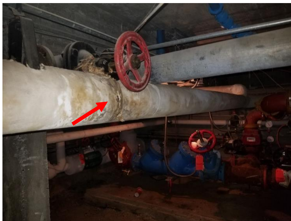
Photo 2. Sous-sol, vide sanitaire, centre-est, <1 mètre carré de raccord dans un état passable.
