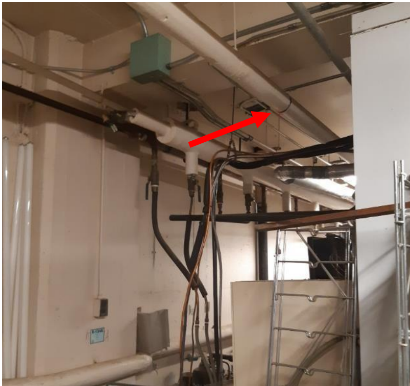
Photo 5. Sous-sol, lab. 15, le long du tuyau au-dessus du déshumidificateur sur le mur nord, <1 mètre linéaire d'isolant alvéolaire dans un état passable.
