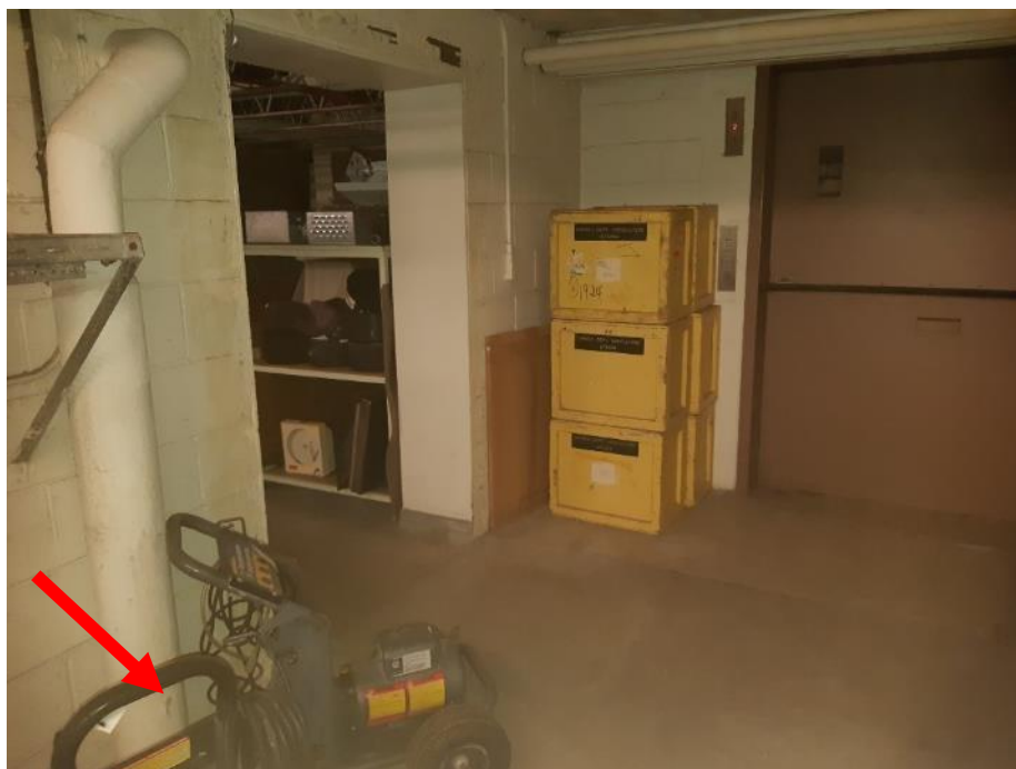
Photo 1. Deuxième étage, mezzanine, nord du monte-charge sur le mur est, <1 mètre linéaire d'isolant à tuyau en mauvais état.
