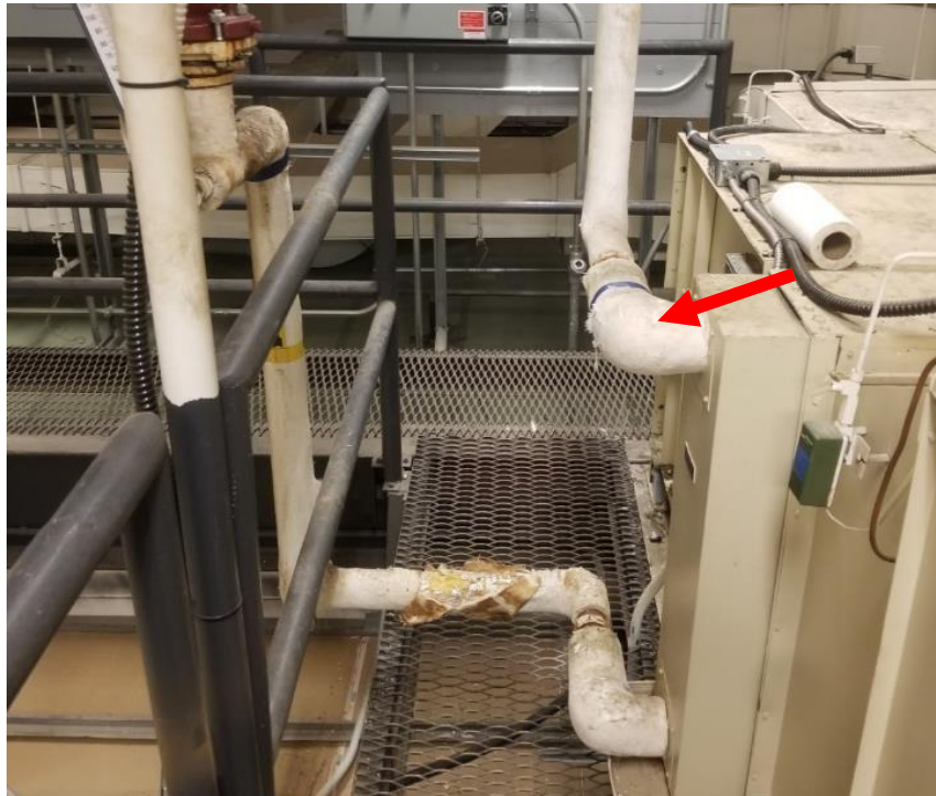
Photo 3. Mezzanine, au-dessus de la salle des chaudières, sur l'appareil de traitement de l'air n° 3, coin nord-est, un raccord en mauvais état.
