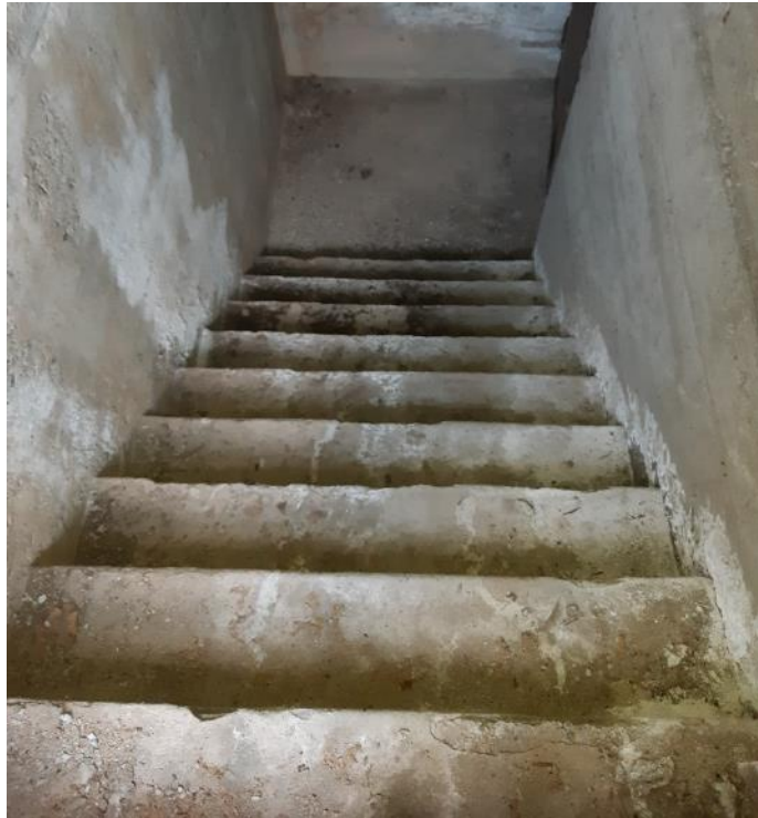
Photo 1. Sous-sol, plancher près de l'entrée, 4 mètres carrés de débris dans l'escalier.
