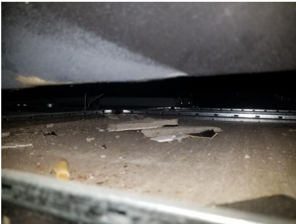
Photo 2. Sous-sol, B-4, 200 mètres carrés de débris de plâtre sur tout le plafond.
