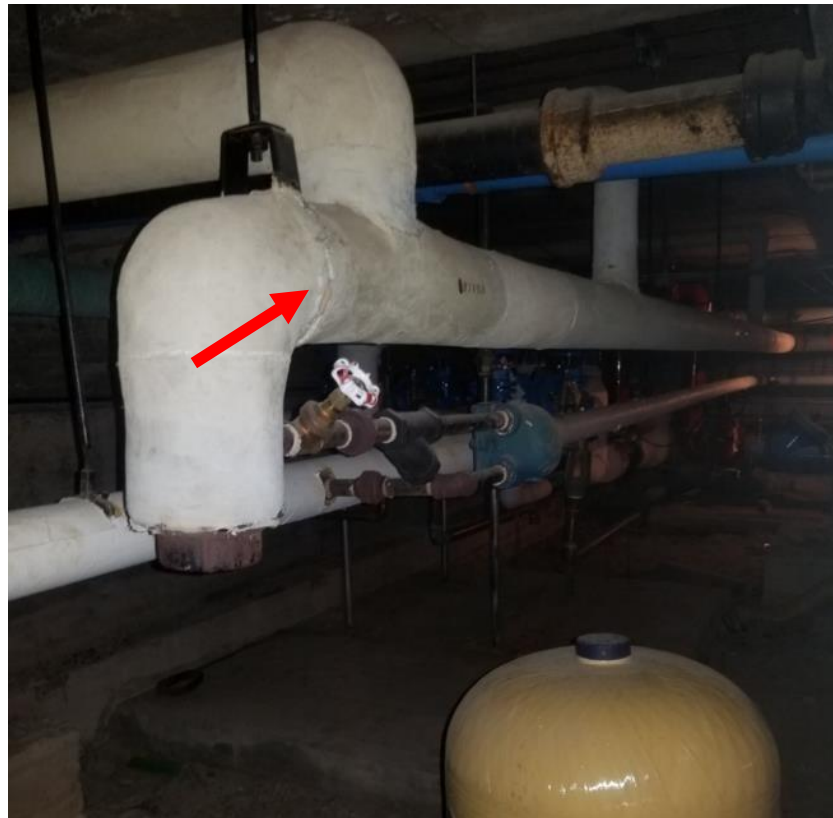
Photo 8. Sous-sol, vide sanitaire, mur est, au-dessus du réservoir d'eau jaune, un raccord en mauvais état.
