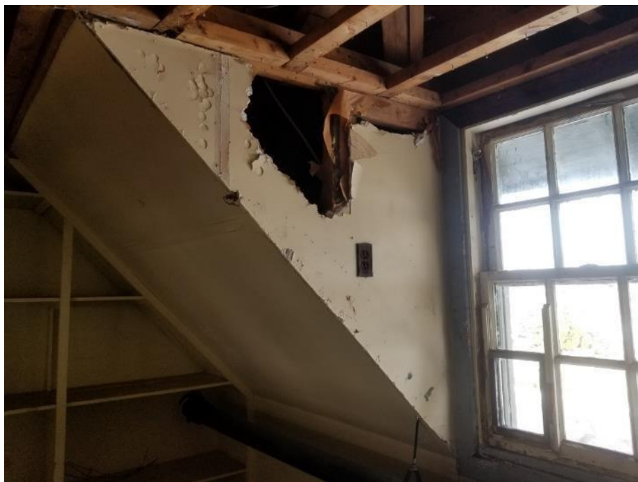
Photo 2. Troisième étage, aire d'entreposage, 2 mètres carrés de cloison sèche en mauvais état.
