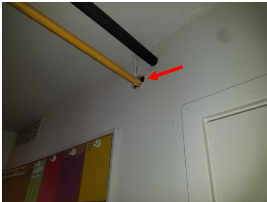
Photo 2. Rez-de-chaussée, vestibule, mur est à la percée du tuyau jaune, <1 mètre carré de composé à joints en mauvais état.
