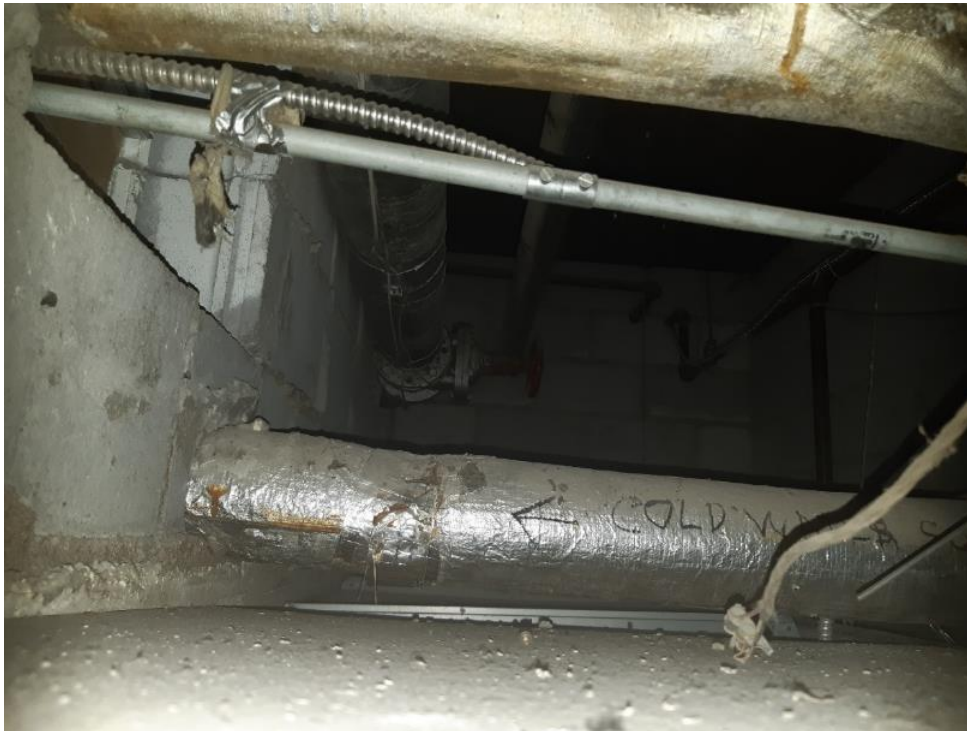
Photo 3. Sous-sol, corridor vers l'ascenseur, 4 mètres carrés de débris de blocs Magblock sur les carreaux de plafond.
