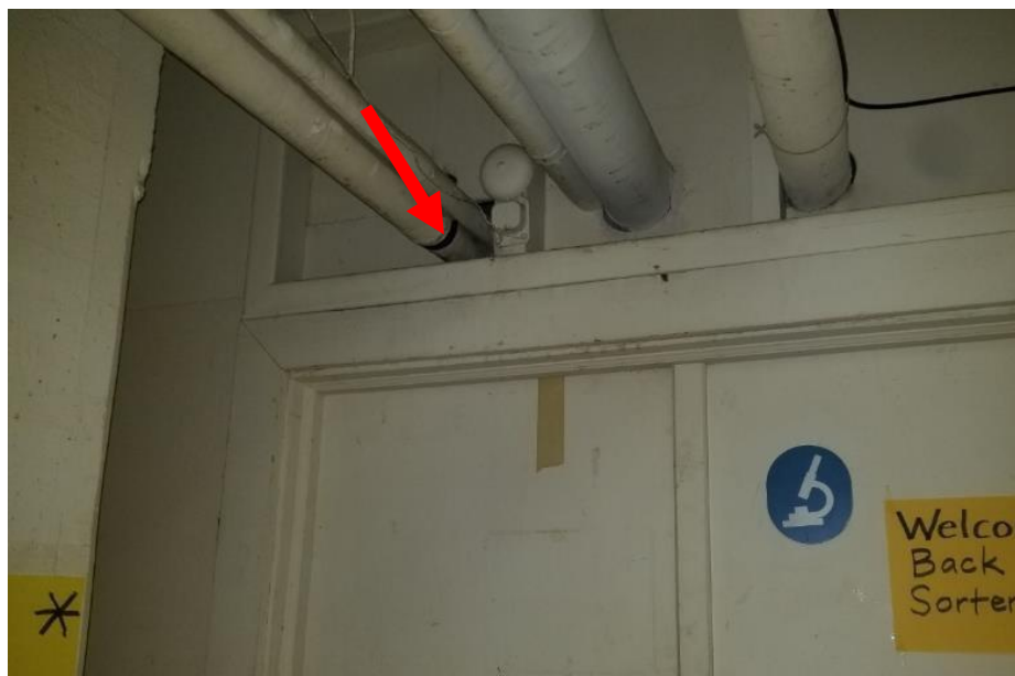
Photo 2. Sous-sol, au centre, bas de l'escalier près de la porte menant à la pièce B-1, <1 mètre linéaire d'isolant alvéolaire dans un état passable.
