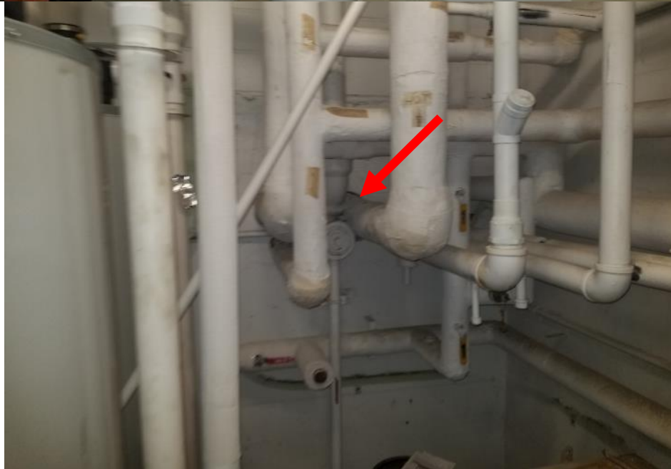
Photo 10. Sous-sol, local technique B23, mur nord au bas de l'escalier, <1 mètre linéaire d'isolant alvéolaire en mauvais état.
