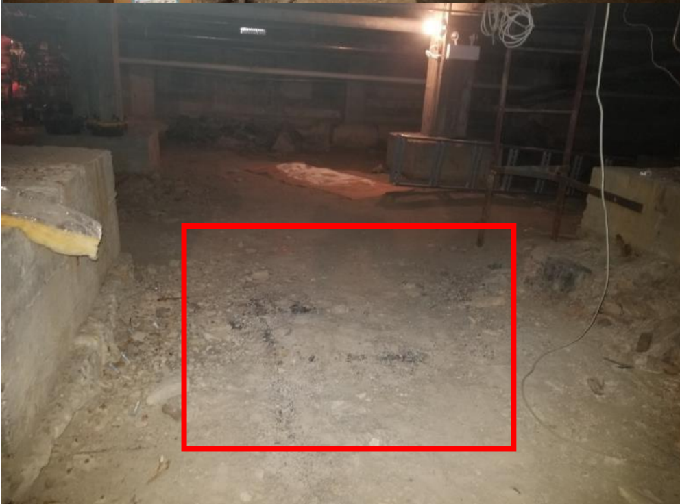
Photo 4. Sous-sol, vide sanitaire, au centre derrière l'échelle, 1 mètre carré de débris d'isolant alvéolaire sur le plancher.
