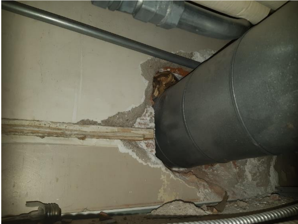
Photo 5. Sous-sol, corridor principal, 80 mètres carrés de plâtre en mauvais état aux percées de conduits (et de tuyaux) dans les murs.
