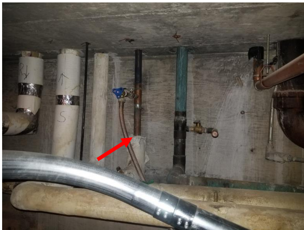
Photo 6. Sous-sol, vide sanitaire, coin nord-est, <1 mètre linéaire d'isolant alvéolaire en mauvais état.
