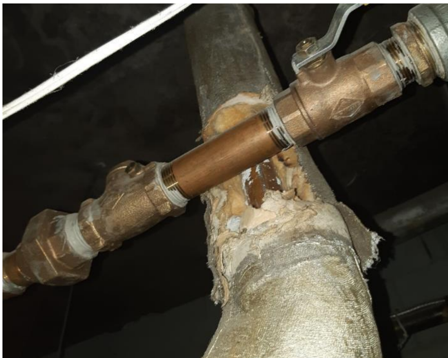
Photo 2. Sous-sol, corridor vers l'ascenseur, un raccord en mauvais état.
