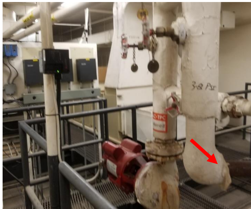
Photo 4. Mezzanine, au-dessus de la salle des chaudières, côté droit de la passerelle, centre-ouest, un raccord en mauvais état.
