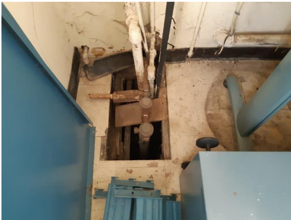
Photo 2. Rez-de-chaussée, bureau, mur est, 10 carreaux de plancher en vinyle dans un état passable.
