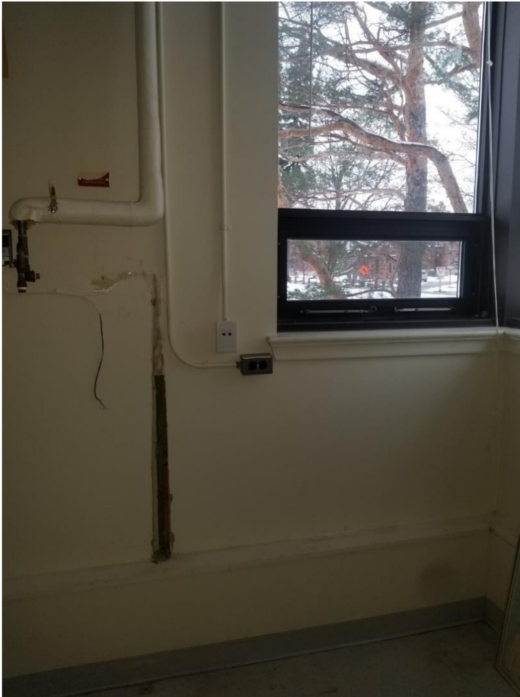
Photo 3. Rez-de-chaussée, salle principale, sous la fenêtre du mur ouest, <1 mètre linéaire de composé à joints dans un état passable.
