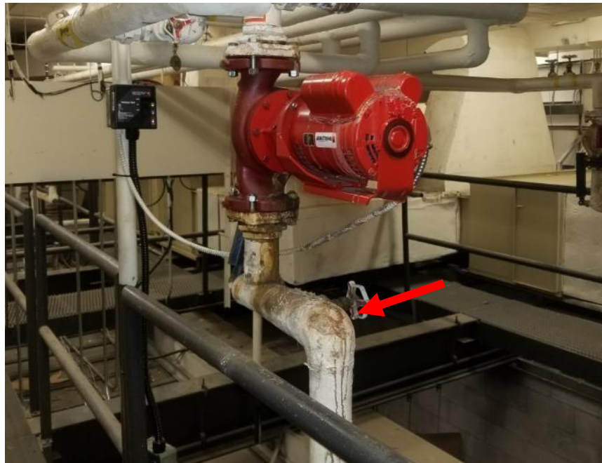
Photo 1. Mezzanine, au-dessus de la salle des chaudières, sous la machine Armstrong rouge, côté nord-est, un raccord en mauvais état.
