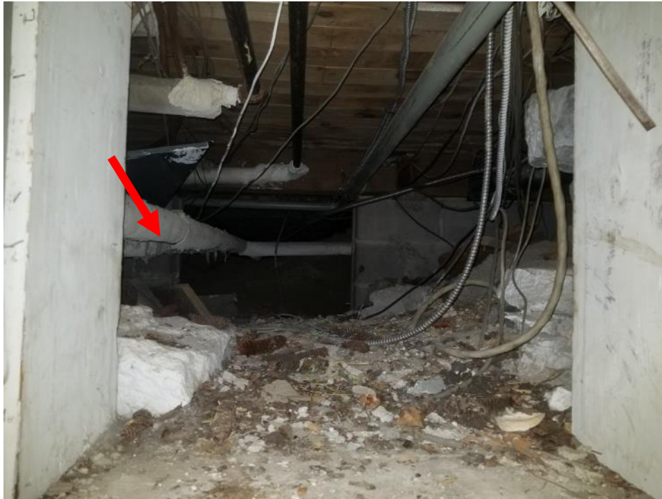
Photo 1. Sous-sol, local d'entreposage, entre la cheminée et la chaufferie, derrière le panneau du mur du fond dans le vide sanitaire, 20 mètres linéaires d'isolant alvéolaire en mauvais état.
