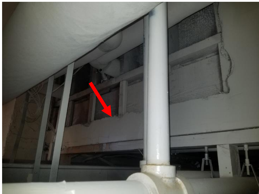
Photo 1. Sous-sol, Salle des dossiers sécurisée, mur sud, 2 mètres carrés de plâtre au plafond en mauvais état.
