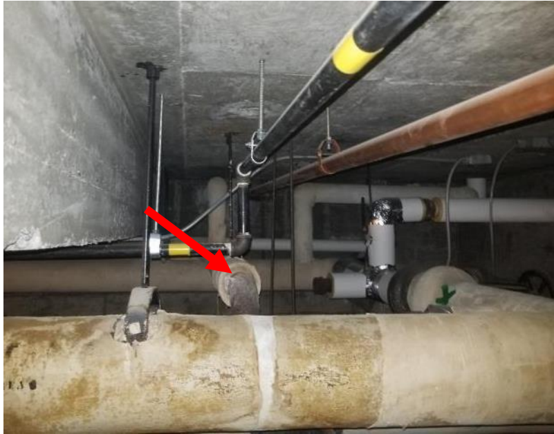
Photo 7. Sous-sol, vide sanitaire, coin nord-est, <1 mètre carré de débris d'isolant alvéolaire sur un tuyau en fonte.
