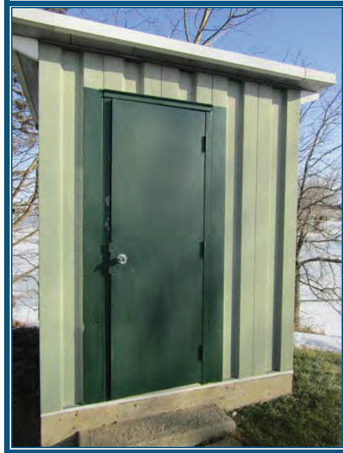
Photo 69: Vue du poste de contrôle du niveau d'eau Joint d'étanchéité au bas du mur extérieur ne contient pas d'amiante
