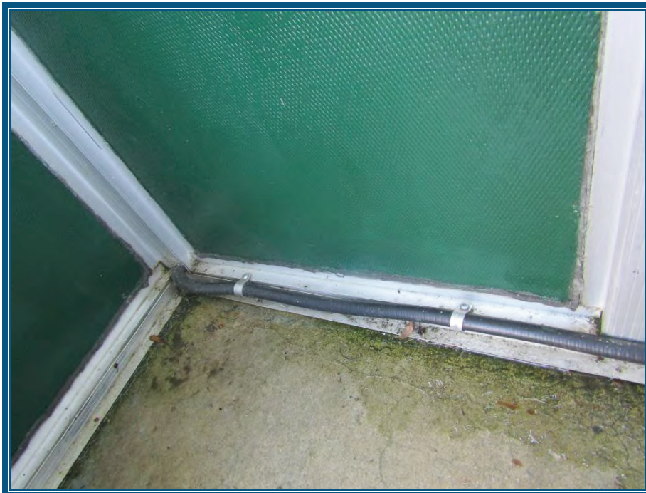
Photo 30: Logette contrôle amont le joint d'étanchéité au bas du mur contient de l'amiante
