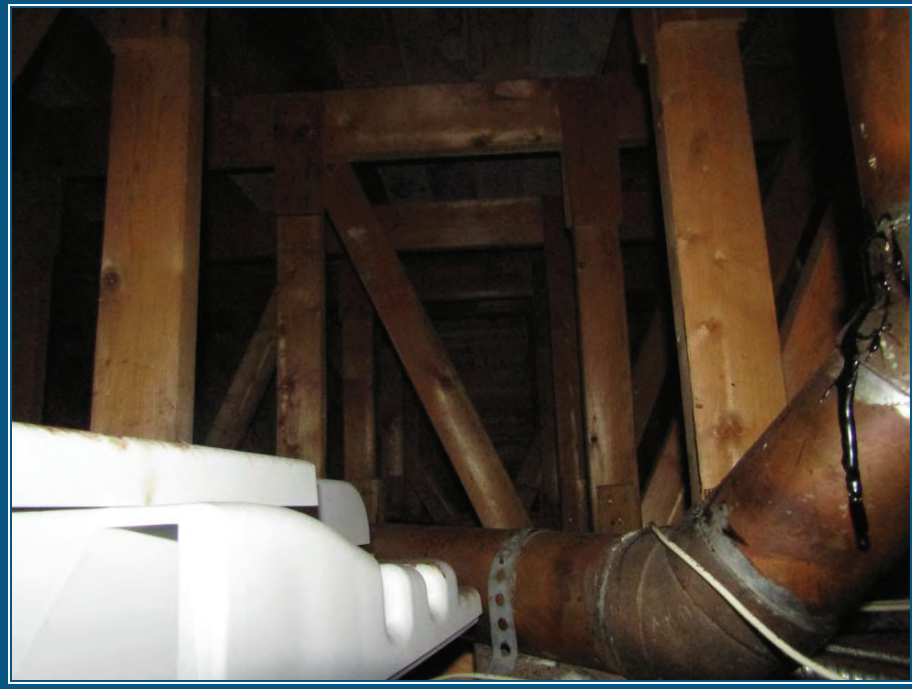
Photo 5: Vue du grenier Conduit non isolé
