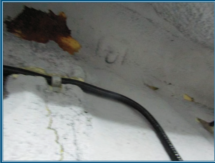
Photo 73: Murs isolés avec du polyuréthane
