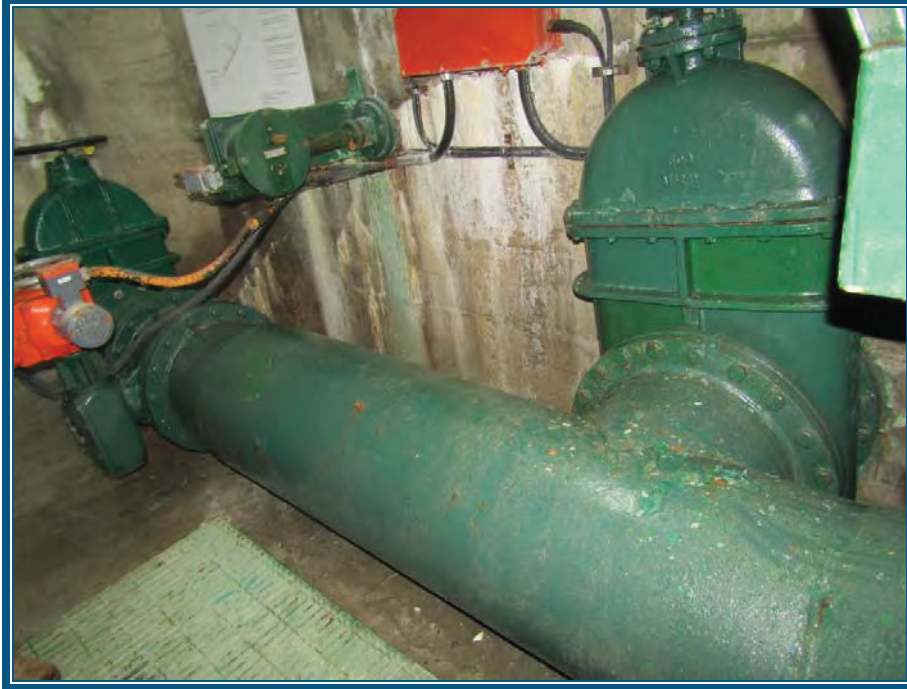
Photo 75: Tuyauterie dans le pilier 6
