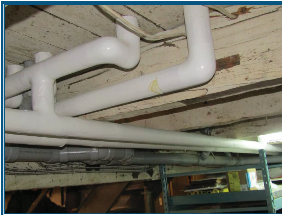
Photo 54: Tuyaux au sous-sol en PVC
