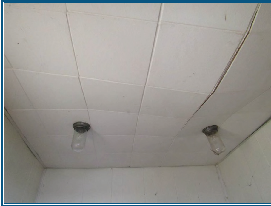
Photo 71: Vue de l'intérieur du poste de contrôle du niveau d'eau Plafond en tuiles acoustiques ne contient pas d'amiante
