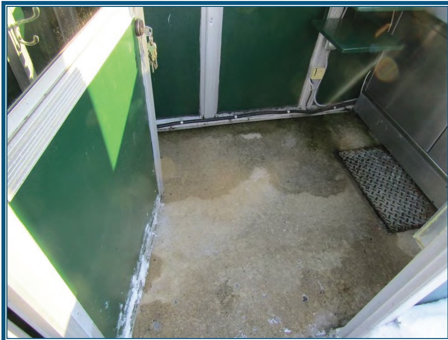
Photo 28: Logette contrôle amont Plancher béton
