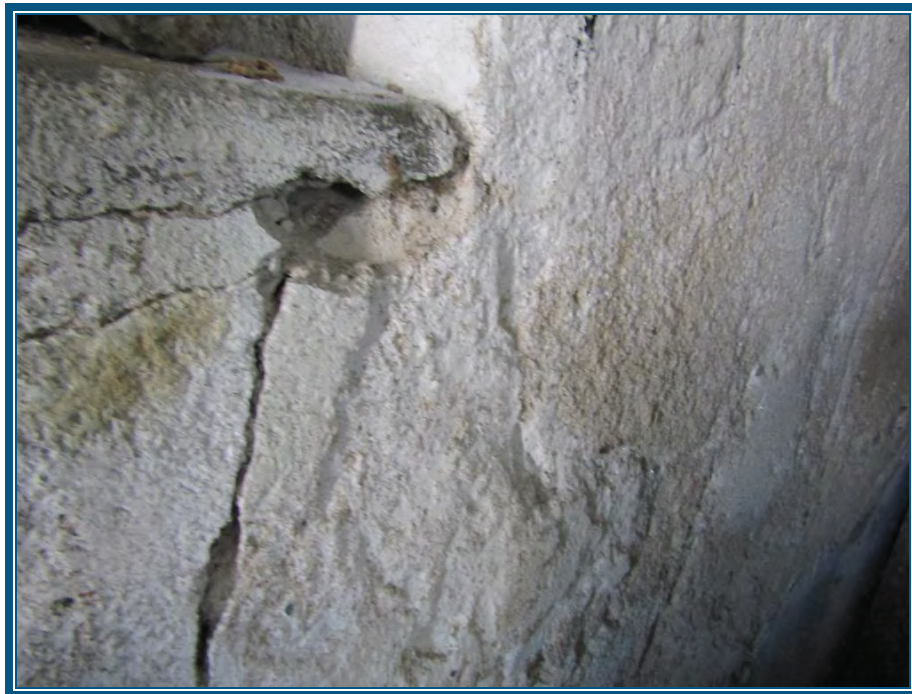
Photo 18: Mur de l'entrepôt – fissures Le plâtre-ciment des murs périphériques ne contiennent pas d'amiante
