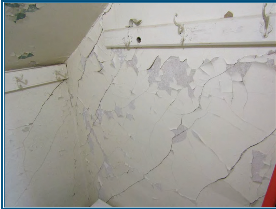
Photo 61: Plâtre-ciment au plafond dans les garde-robes à l'étage contient de l'amiante Endommagé par endroits
