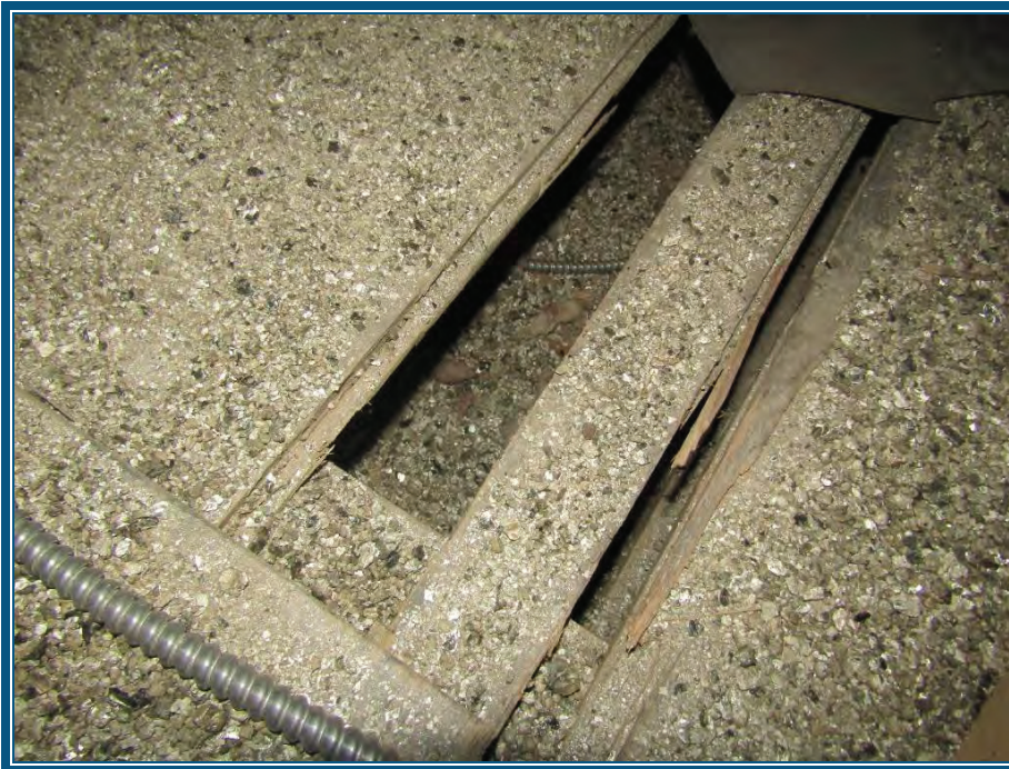
Photo 64: Vermiculite contenant de l'amiante présente dans le grenier de l'étage
