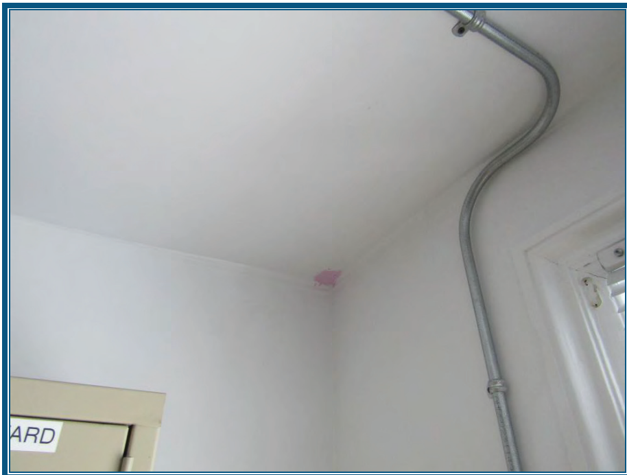
Photo 60: Murs et plafond de gypse dans le vestiaire à l'étage ne contiennent pas d'amiante
