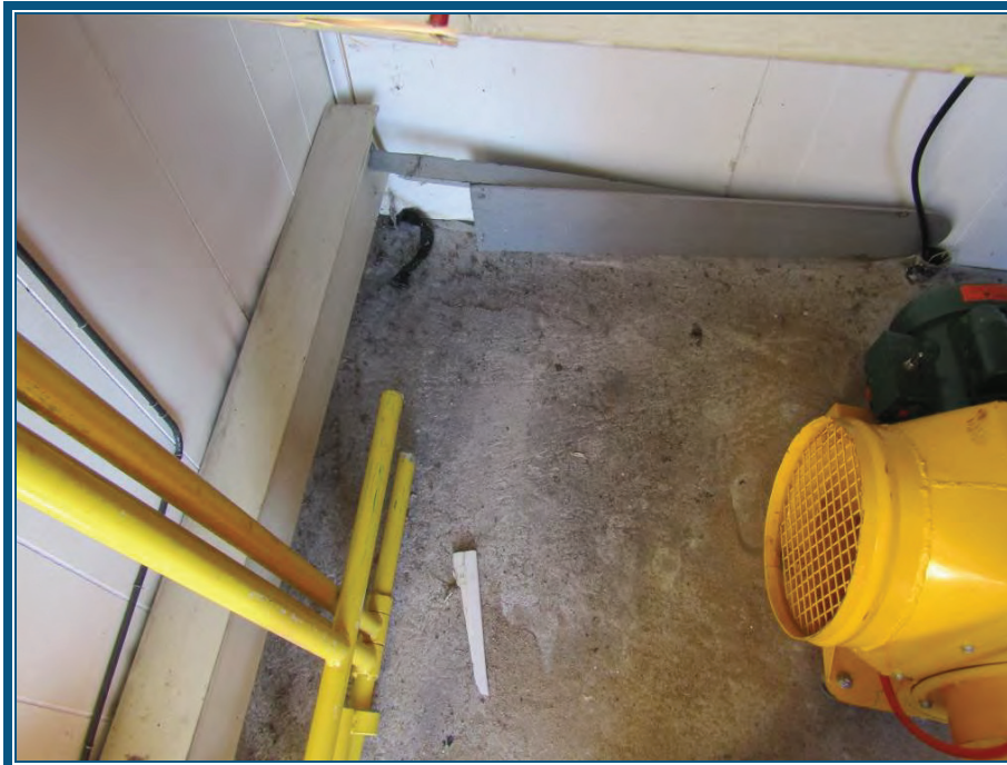
Photo 70: Vue de l'intérieur du poste de contrôle du niveau d'eau Plancher en béton Mur en préfinis
