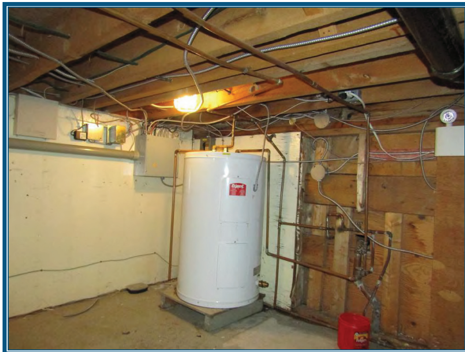
Photo 40: Local d'entreposage au rez-de-chaussée Mur en béton, plancher et plafond en bois Tuyaux non isolés
