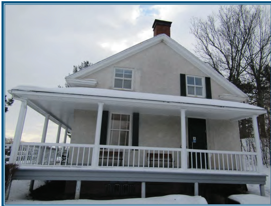
Photo 50: Vue de la façade est de la maison du maître éclusier Le crépi de ciment avec agglomérats de pierre des murs extérieurs contiennent de l'amiante (phase fini décoratif) Le crépi de ciment du mur de fondation ne contient pas d'amiante
