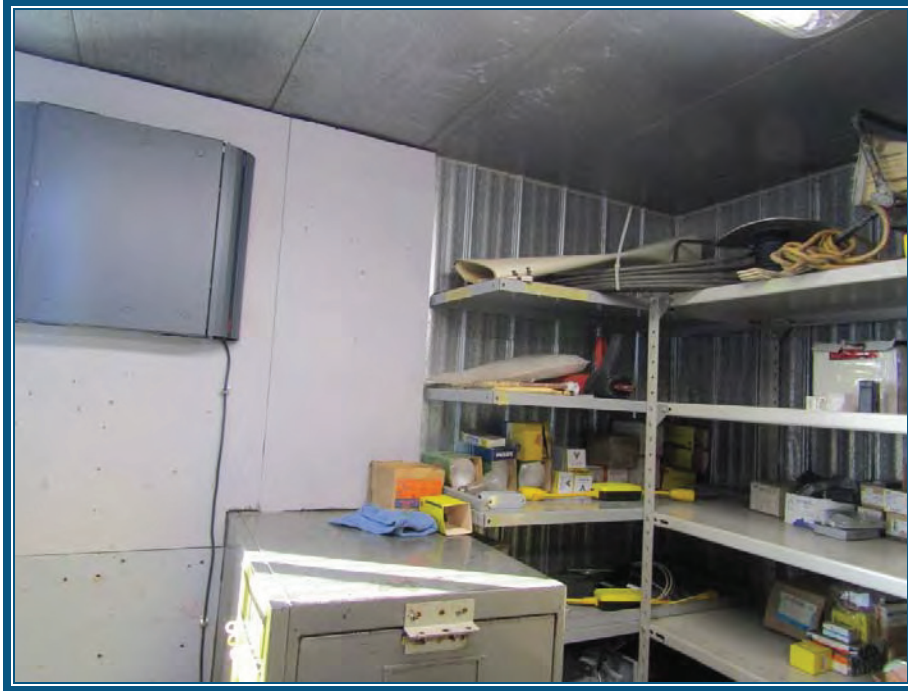
Photo 67: Vue de l'intérieur du poste de contrôle du barrage
