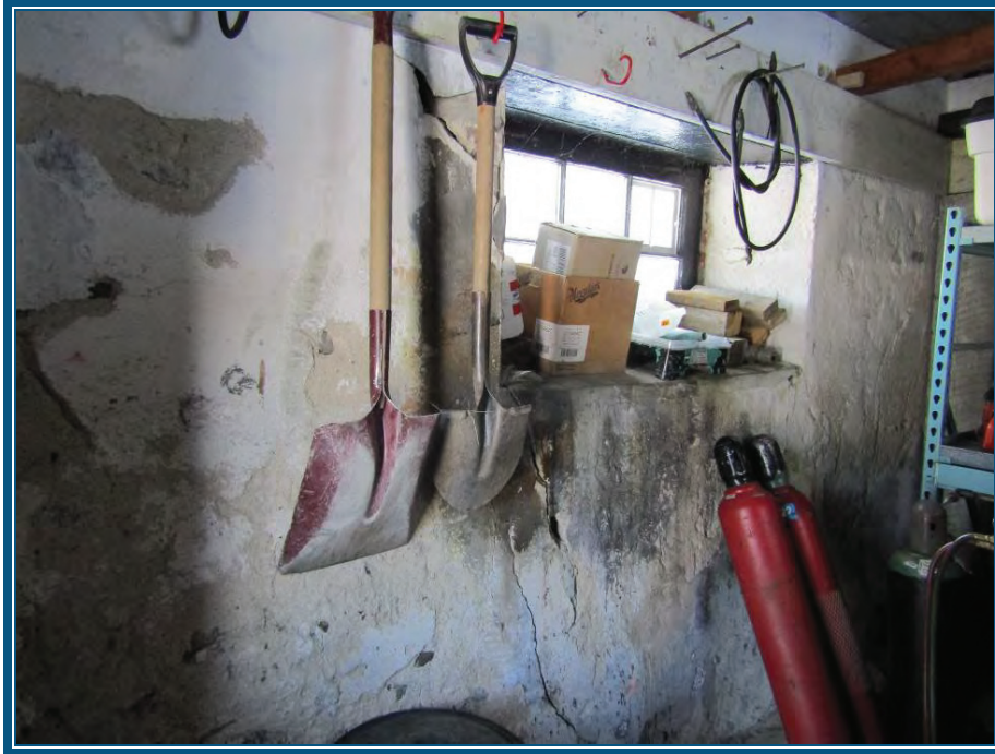
Photo 17: Mur de l'entrepôt – fissures Le plâtre-ciment des murs périphériques ne contiennent pas d'amiante
