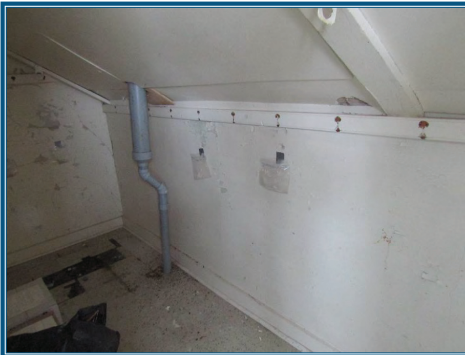
Photo 62: Plâtre-ciment sur les murs de garde-robes ne contient pas d'amiante Les tuiles de vinyle au plancher contiennent de l'amiante – dommages par endroits
