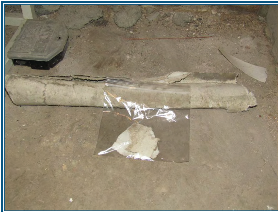
Photo 52: Débris de canevas contenant de l'amiante retrouvé au sous-sol
