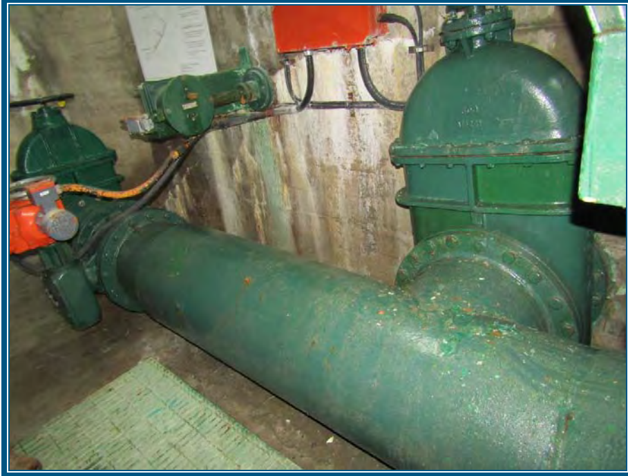
Photo 75: Tuyauterie dans le pilier 6
