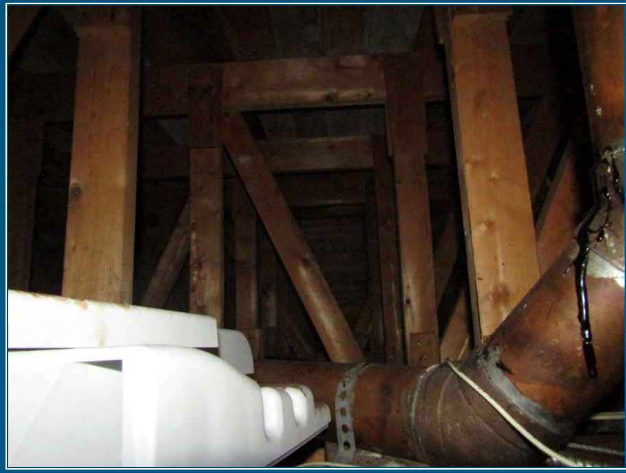
Photo 5: Vue du grenier Conduit non isolé
