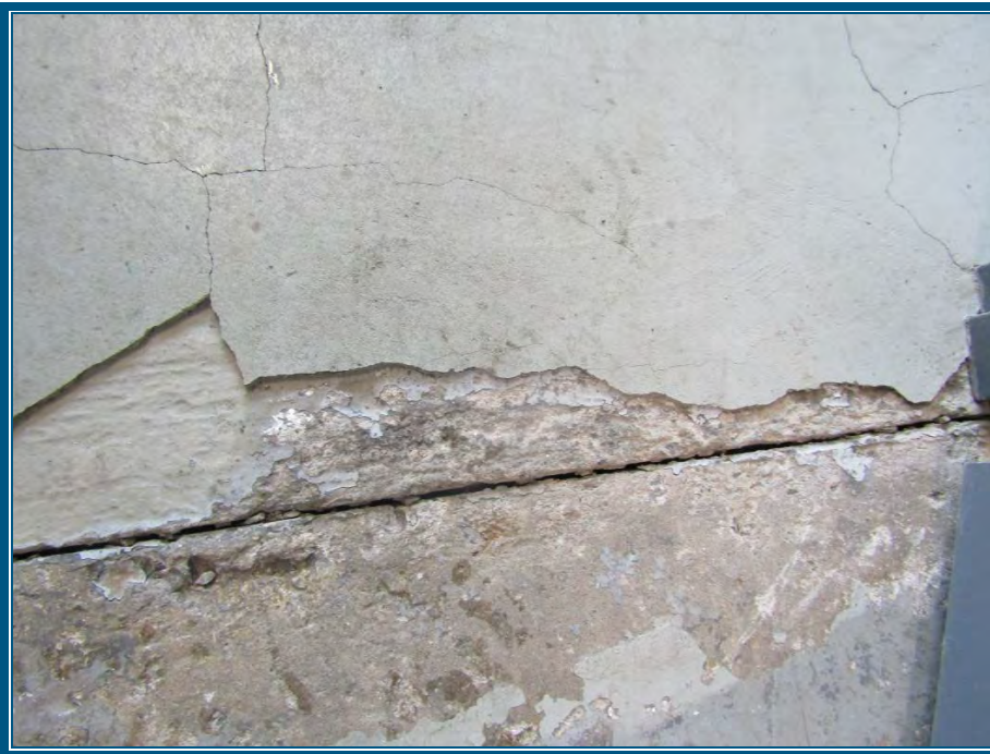
Photo 68: Ciment de recouvrement au plancher ne contient pas d'amiante
