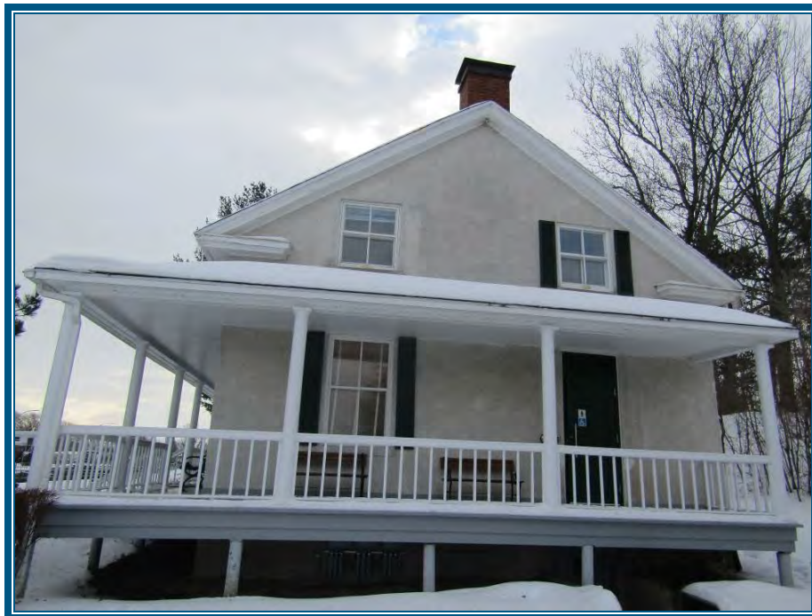
Photo 50: Vue de la façade est de la maison du maître éclusier Le crépi de ciment avec agglomérats de pierre des murs extérieurs contiennent de l'amiante (phase fini décoratif) Le crépi de ciment du mur de fondation ne contient pas d'amiante
