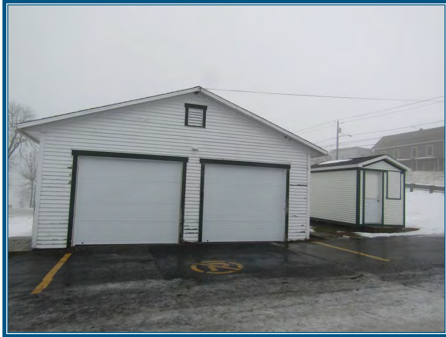
Photo 19: Vue du garage Mur extérieur en bois, peints en blanc Portes de garage peintes en blanc, cadres peints en vert
