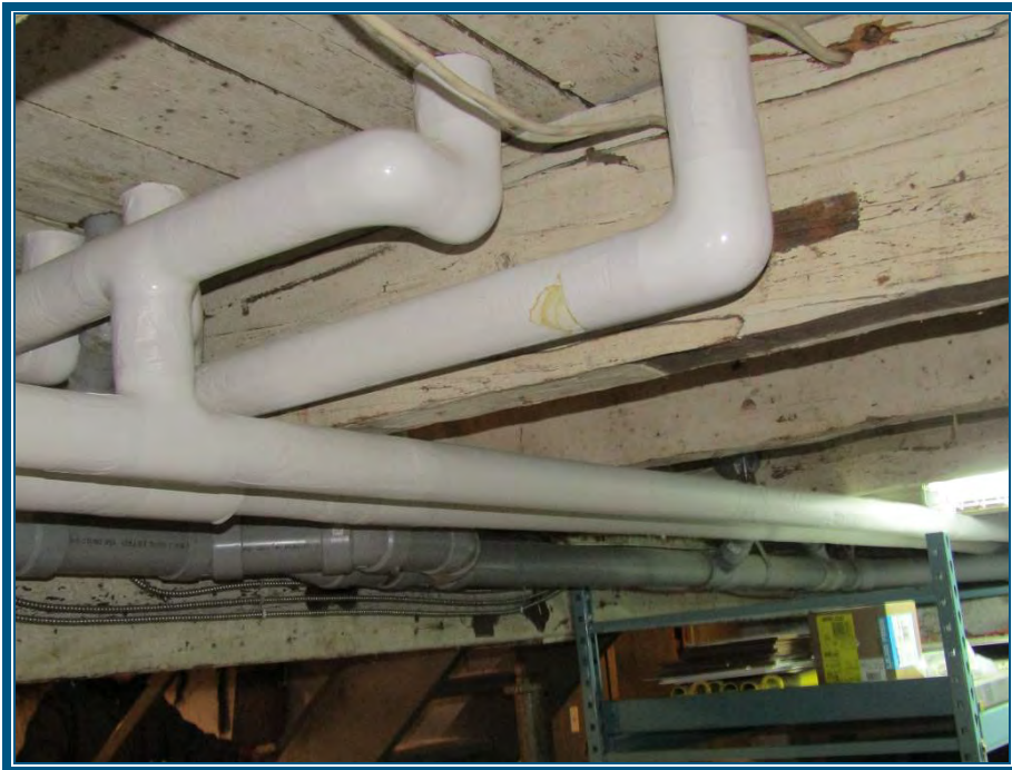
Photo 54: Tuyaux au sous-sol en PVC
