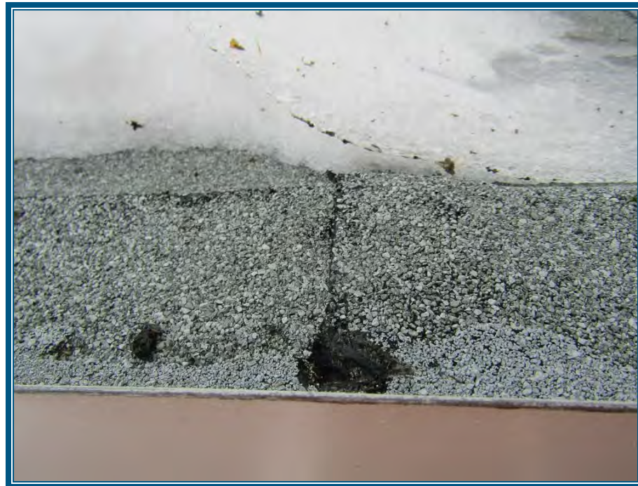
Photo 34: Les bardeaux d'asphalte de la toiture de la logette de l'éclusier ne contiennent pas d'amiante
