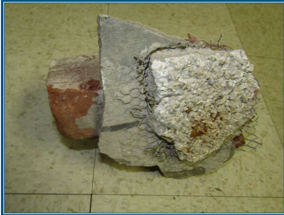
Photo 63: Matériaux fournis par Parcs Canada prélevé lors des travaux de rénovation sur les murs extérieurs. La phase « fini décoratif » de ce matériau contient de l'amiante
