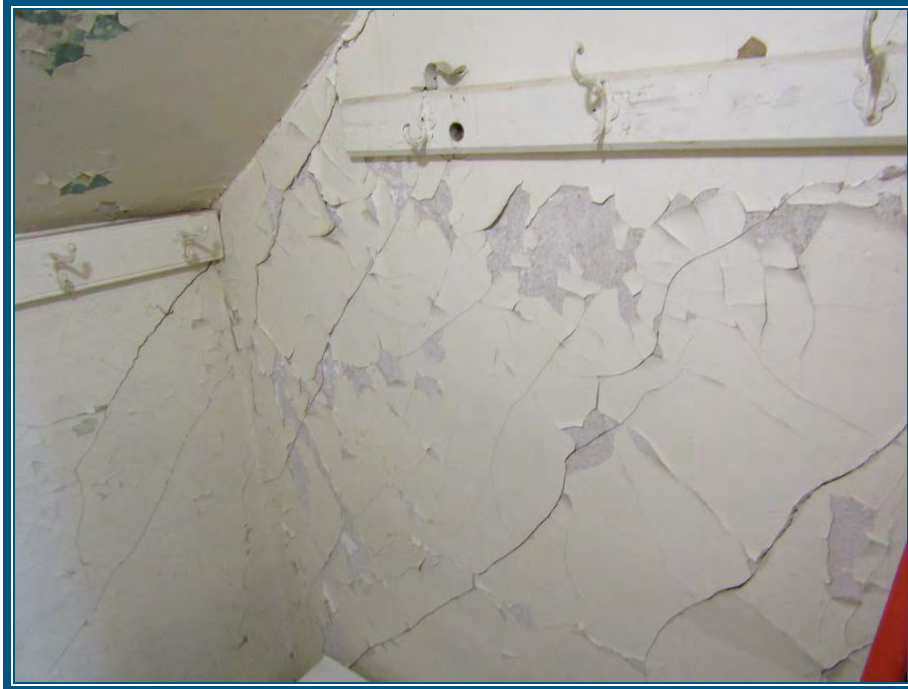
Photo 61: Plâtre-ciment au plafond dans les garde-robes à l'étage contient de l'amiante Endommagé par endroits
