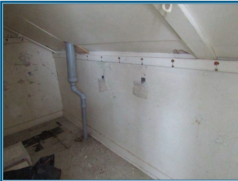
Photo 62: Plâtre-ciment sur les murs de garde-robes ne contient pas d'amiante Les tuiles de vinyle au plancher contiennent de l'amiante – dommages par endroits
