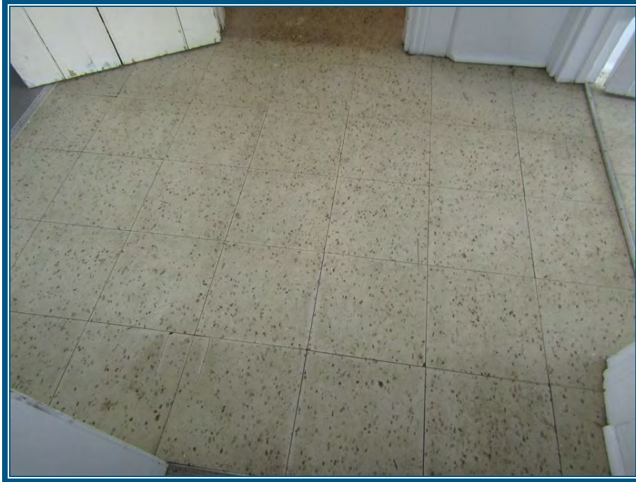
Photo 59: Tuiles de vinyle 9 pouces x 9 pouces au plancher du couloir à l'étage contiennent de l'amiante
