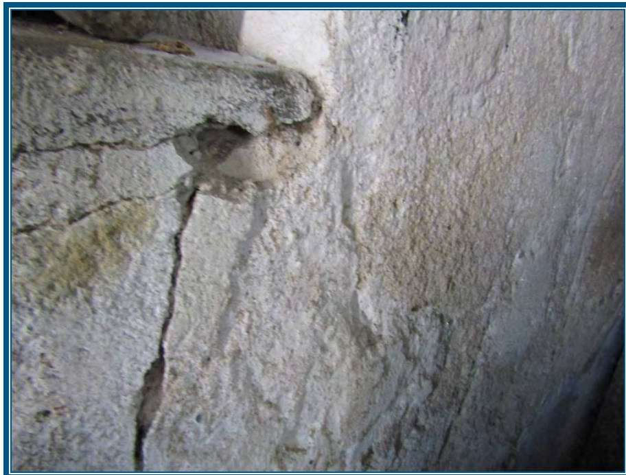
Photo 18: Mur de l'entrepôt – fissures Le plâtre-ciment des murs périphériques ne contiennent pas d'amiante
