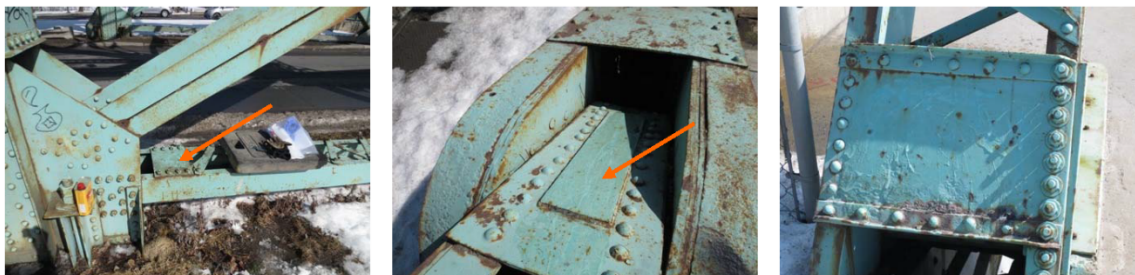
Échantillon avant prélèvement (pont ave. St-Pierre/ave. Dollard direction sud) pris depuis les plaques de renfort
