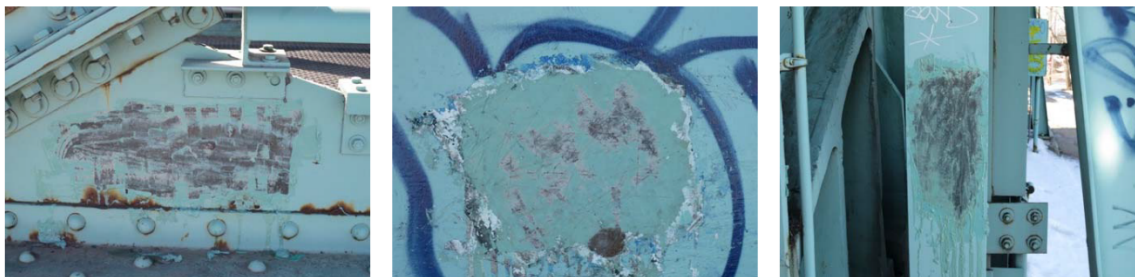
Échantillon après prélèvement (pont ave. St-Pierre/ave. Dollard direction nord) pris depuis les plaques de renfort et une poutre
