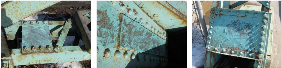
Échantillon après prélèvement (pont ave. St-Pierre/ave. Dollard direction sud) pris depuis les plaques de renfort
