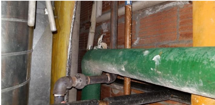
Photo 72 : Châsse 4037-4039, raccord de tuyauterie en mauvais état
