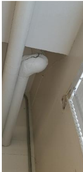
Photo 58 : Salle 3115-3117, raccord de tuyauterie et plâtre du plafond en mauvais état
