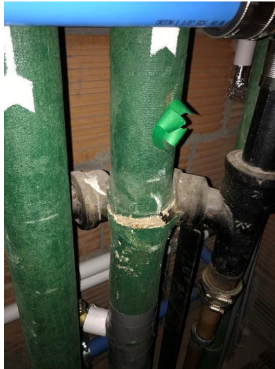
Photo 45 : Châsse 2044-2046, calorifuge de tuyauterie à alvéoles d'air en mauvais état
