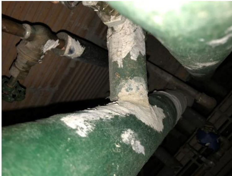
Photo 14 : Châsse 1007-1009, raccord de tuyauterie et calorifuge à alvéoles d'air en mauvais état
