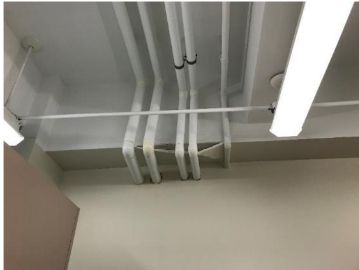
Photo 27 : Salle 1103, plâtre du plafond en mauvais état et débris de plâtre
