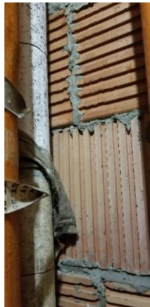
Photo 75 : Châsse 4049-cage d'escalier, calorifuge de tuyau à alvéoles d'air en mauvais état
