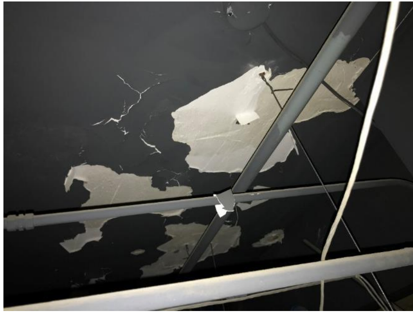
Photo 4 : Salle B58, plâtre en mauvais état au-dessus des carreaux de plafond
