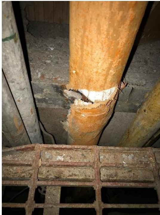
Photo 18 : Châsse 1043-1045, calorifuge à alvéoles d'air en mauvais état
