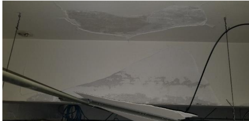
Photo 79 : Salle 4097, plâtre du plafond en mauvais état et débris de plâtre reposant sur les carreaux de plafond et au-dessus de ceux-ci
