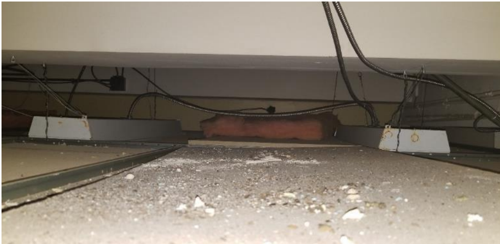
Photo 84 : Salle 4115, plâtre du plafond en mauvais état et débris de plâtre reposant sur les carreaux de plafond et les appareils d'éclairage et au-dessus de ceux-ci
