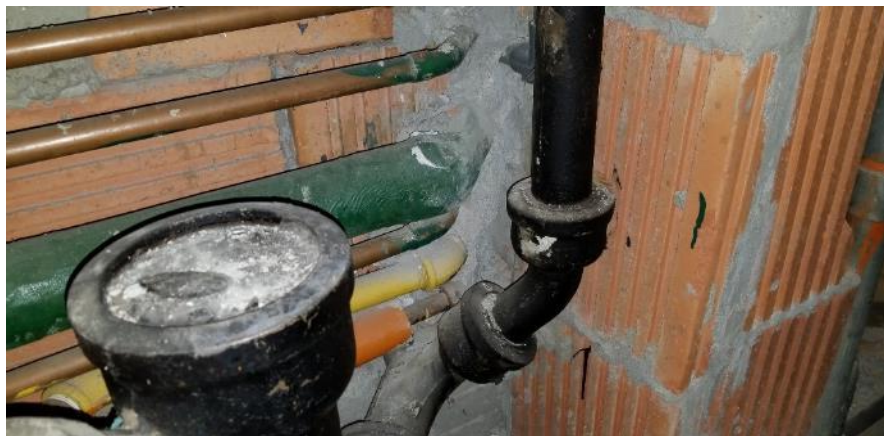
Photo 69 : Châsse 4003-4005, calorifuge de tuyau à alvéoles d'air en mauvais état et débris
