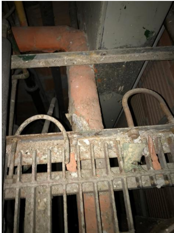
Photo 35 : Châsse 2012-2014, raccord de tuyauterie et calorifuge à alvéoles d'air en mauvais état
