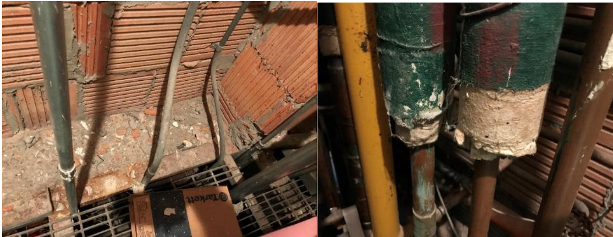
Photos 41 et 42 : Châsse 2028-2030, raccords de tuyauterie et calorifuge à alvéoles d'air en mauvais état accompagnés de débris
