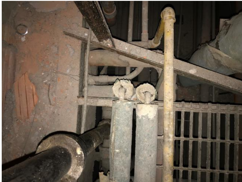
Photo 16 : Châsse 1022-1024, raccords de tuyauterie en mauvais état
