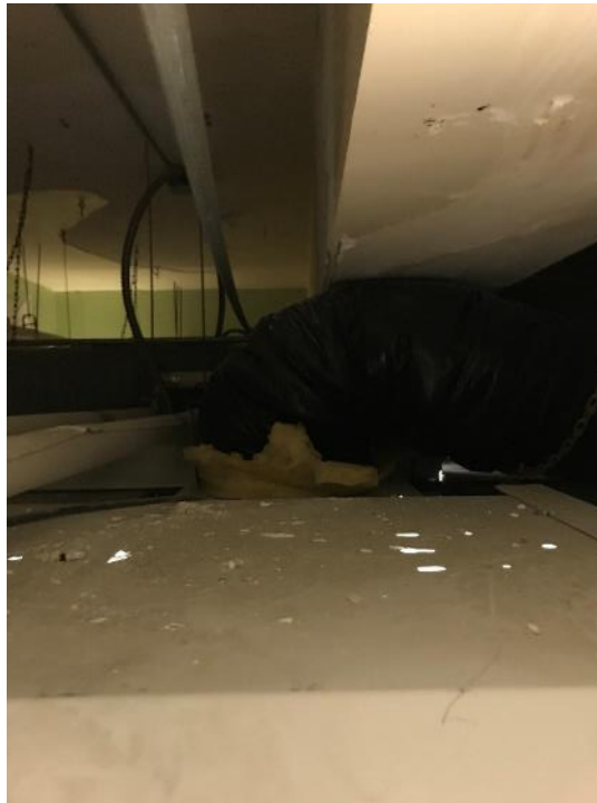
Photo 20 : Salle 1061A, plâtre du plafond en mauvais état et débris de plâtre
