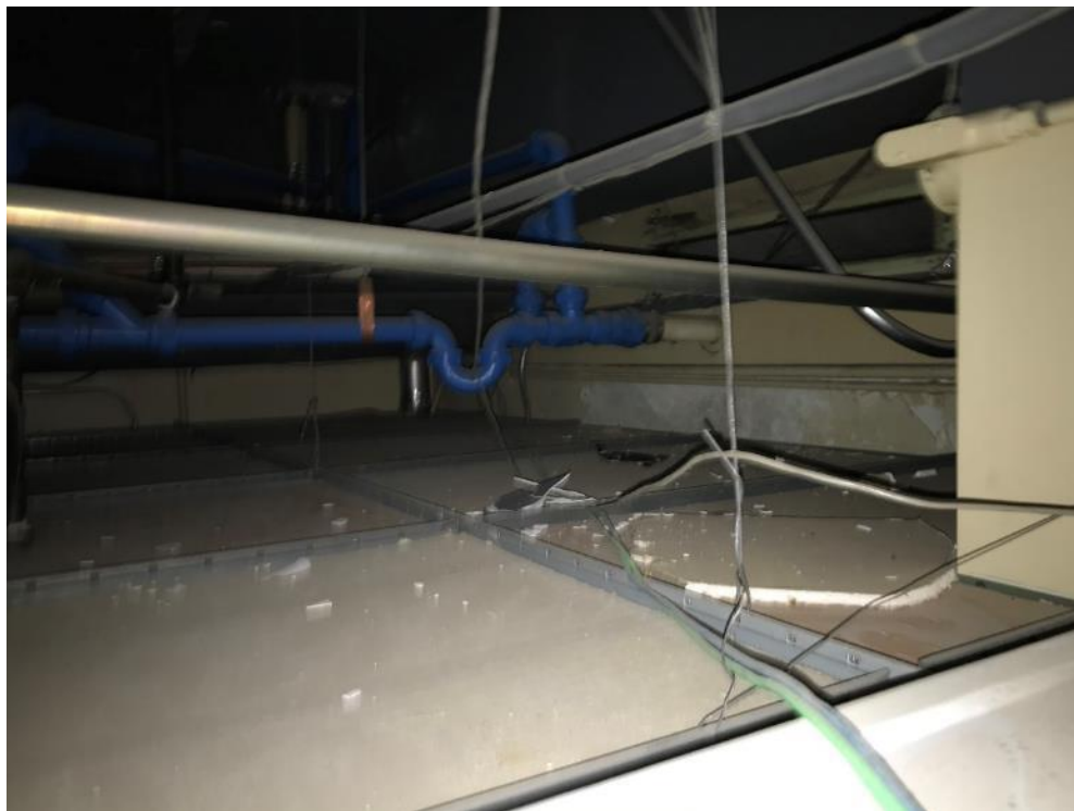
Photo 5 : Salle B58, débris de plâtre reposant sur les carreaux de plafond et les appareils d'éclairage
