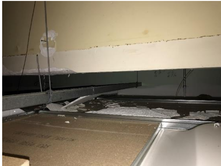
Photo 50 : Salle 2087, plâtre du plafond en mauvais état et débris de plâtre reposant sur les carreaux de plafond et au-dessus de ceux-ci
