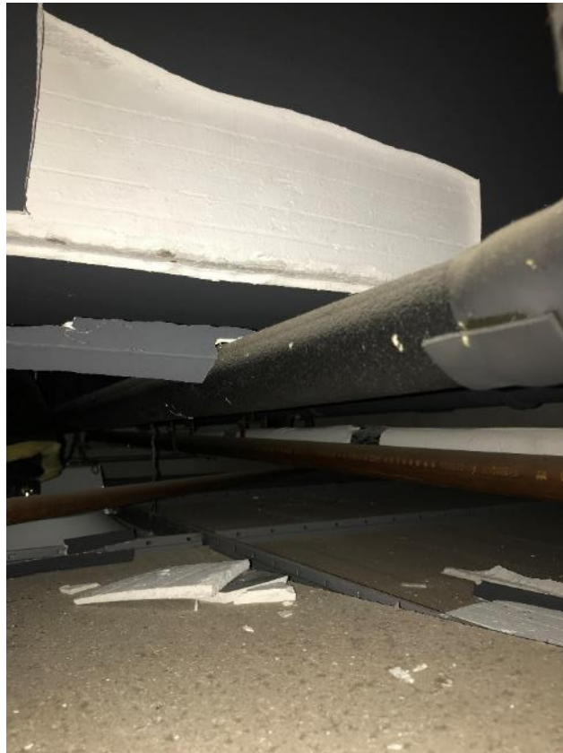
Photo 33 : Salle 1139, plâtre du plafond en mauvais état et débris de plâtre reposant sur les carreaux de plafond et les appareils d'éclairage et au-dessus de ceux-ci
