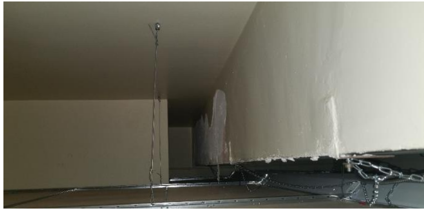
Photo 80 : Salle 4102, plâtre du plafond en mauvais état et débris de plâtre au-dessus des carreaux de plafond
