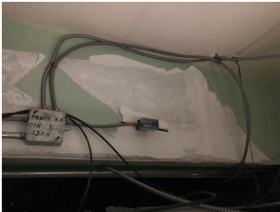
Photo 30 : Salle 1117, plâtre du plafond en mauvais état au-dessus des carreaux de plafond
