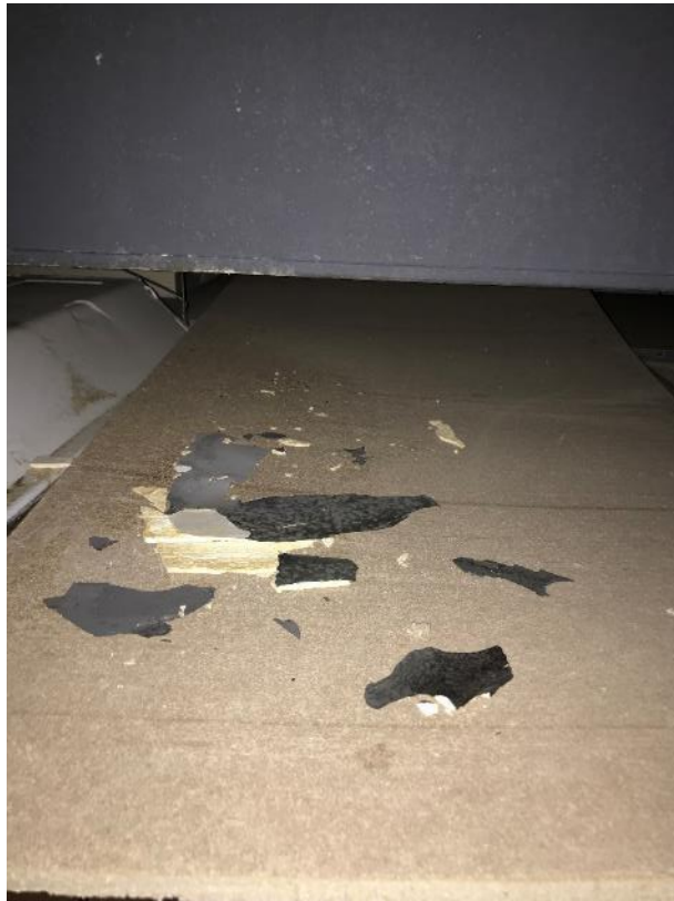
Photo 10 : Salle B85, plâtre en mauvais état et débris reposant sur les carreaux de plafond
