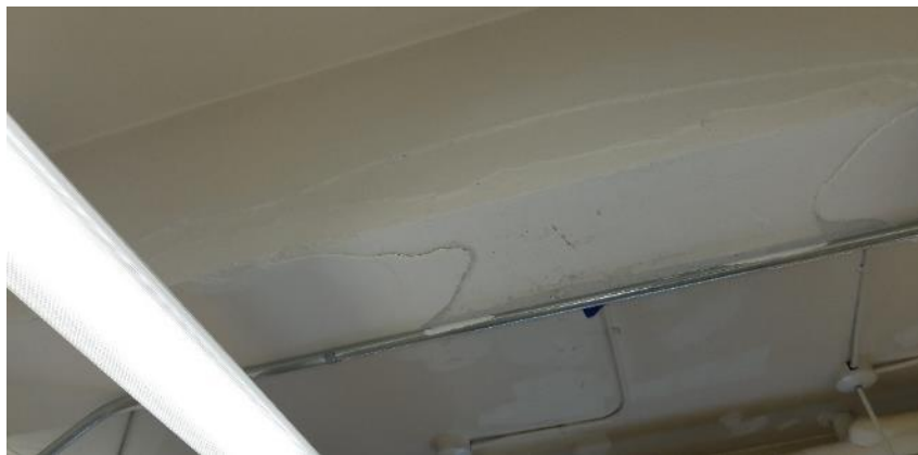
Photo 63 : Salle 3135E, plâtre du plafond en mauvais état
