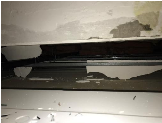
Photo 54 : Salle 2119, plâtre du plafond en mauvais état et débris de plâtre reposant sur les carreaux de plafond et les appareils d'éclairage et au-dessus de ceux-ci
