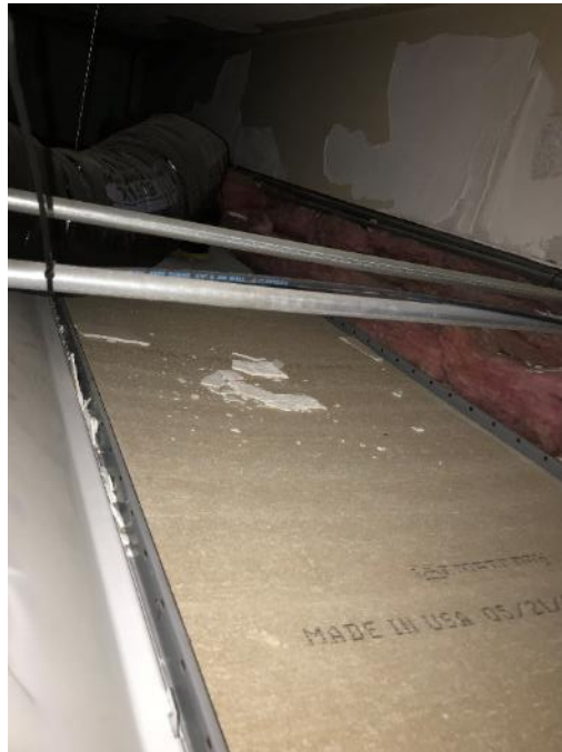
Photo 26 : Salle 1081, plâtre du plafond en mauvais état et débris de plâtre reposant sur les carreaux de plafond
