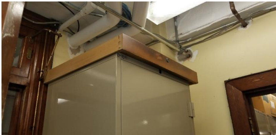
Photo 57 : Aire commune des salles 3109-3113, plâtre mural et du plafond en mauvais état
