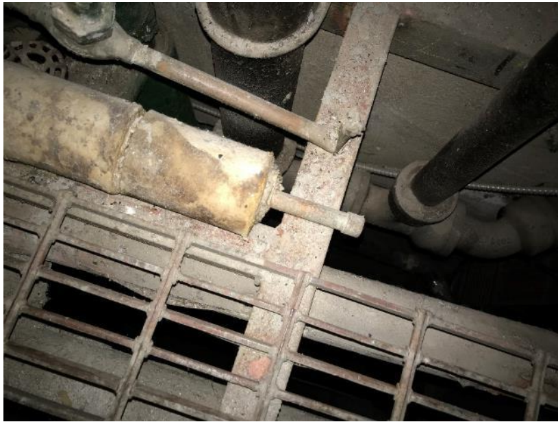
Photo 37 : Châsse 2020-2022, raccord de tuyauterie en mauvais état au niveau du caillebotis de plancher
