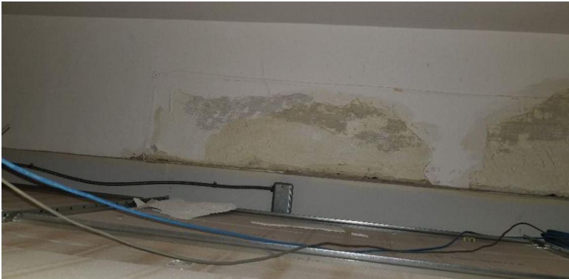
Photo 56 : Salle 3098, plâtre du plafond en mauvais état et débris de plâtre au-dessus des carreaux de plafond
