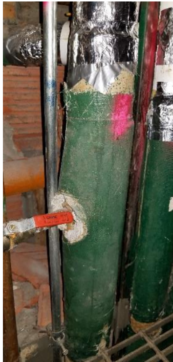
Photo 74 : Châsse 4041-4043, calorifuge de tuyau à alvéoles d'air en mauvais état
