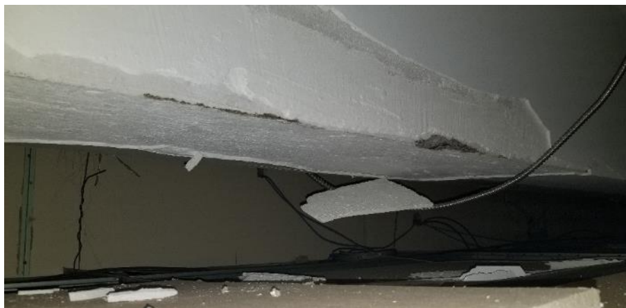
Photo 83 : Salle 4111, plâtre du plafond en mauvais état et débris de plâtre reposant sur les carreaux de plafond et les appareils d'éclairage et au-dessus de ceux-ci
