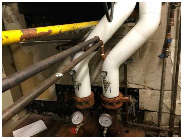
Photo 11 : Salle B86A, plâtre mural en mauvais état et débris
