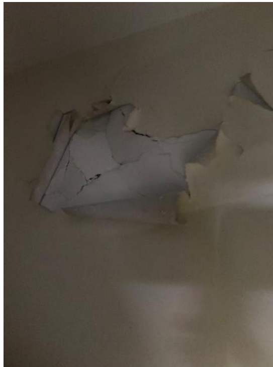
Photo 78 : Salle 4093, plâtre du plafond en mauvais état au-dessus des carreaux de plafond
