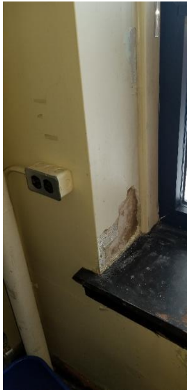
Photo 62 : Salle 3135B, plâtre mural en mauvais état et débris reposant sur l'appui de fenêtre
