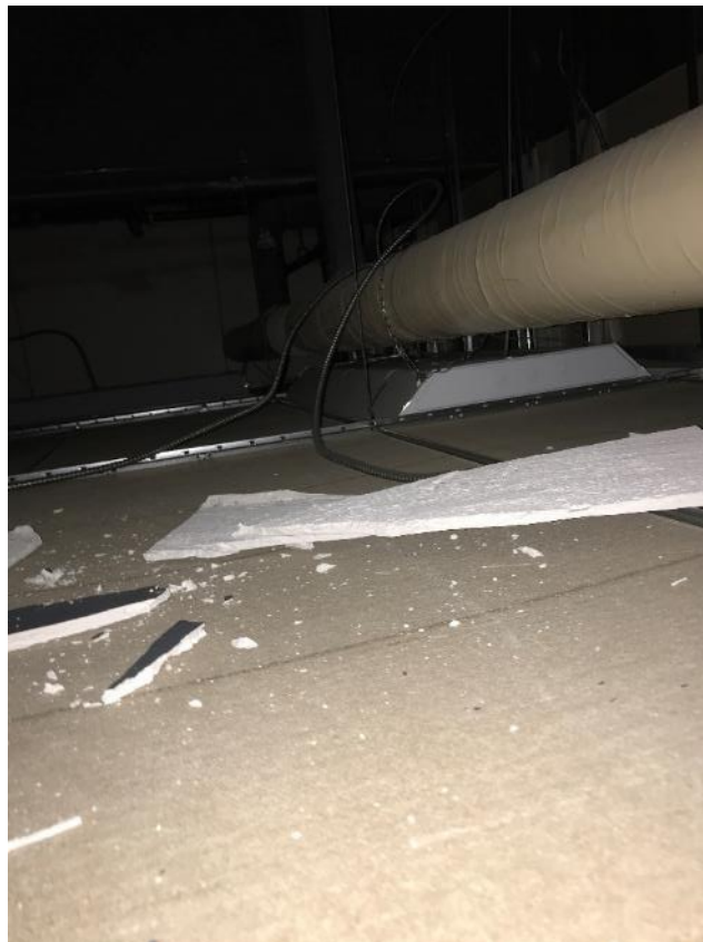
Photo 9 : Salle B84, plâtre en mauvais état et débris reposant sur les carreaux de plafond
