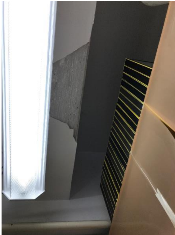
Photo 61 : Salle 3135, plâtre du plafond en mauvais état sur la poutre en I
