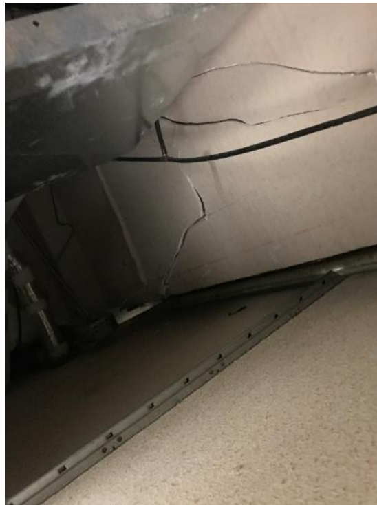
Photo 52 : Salle 2109, plâtre mural et du plafond en mauvais état au-dessus des carreaux de plafond
