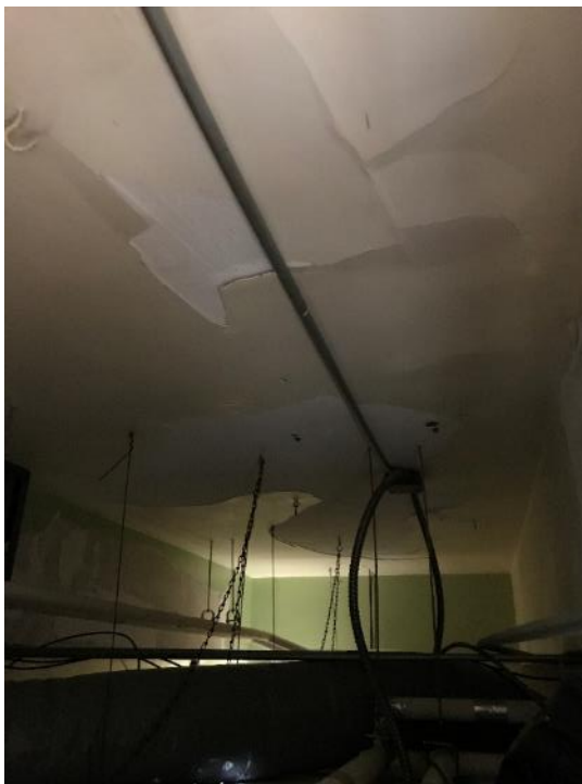
Photo 21 : Salle 1061A, plâtre du plafond en mauvais état et débris de plâtre
