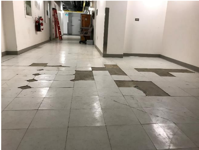
Photo 12 : Corridor B85-B90, carreaux de plancher en vinyle en mauvais état
