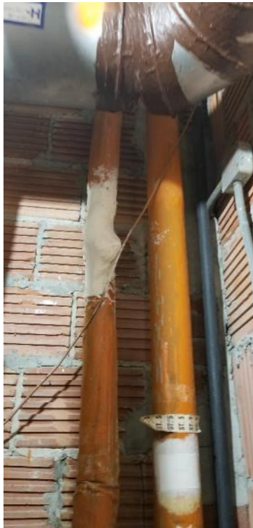
Photo 66 : Châsse 4001-cage d'escalier, calorifuge à alvéoles d'air en mauvais état
