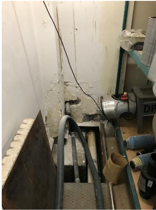
Photo 6 : Salle B61, plâtre mural en mauvais état et débris
