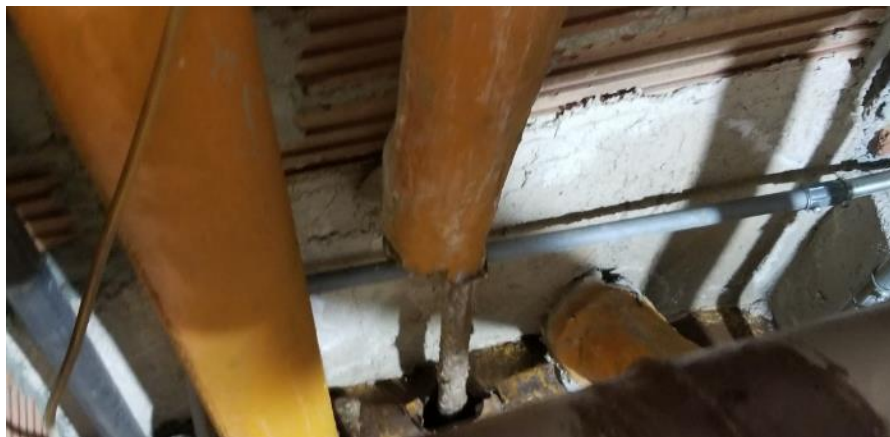
Photo 67 : Châsse 4001-4003, raccords de tuyauterie et calorifuge à alvéoles d'air en mauvais état
