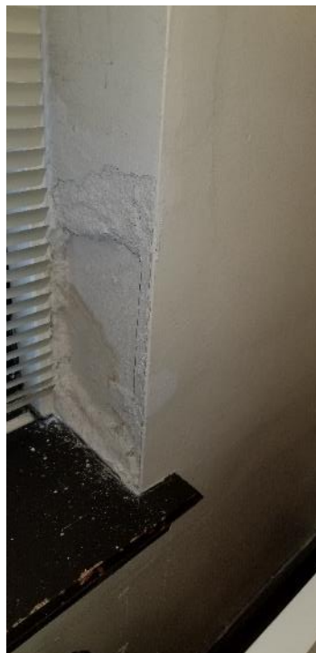
Photo 59 : Salle 3119, plâtre mural en mauvais état et débris reposant sur l'appui de fenêtre
