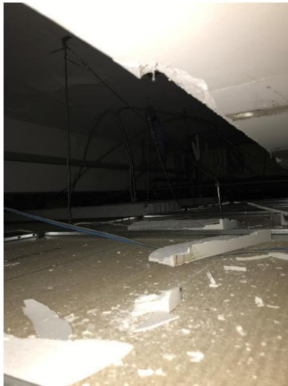
Photo 47 : Salle 2057, plâtre du plafond en mauvais état et débris de plâtre reposant sur les carreaux de plafond et au-dessus de ceux-ci
