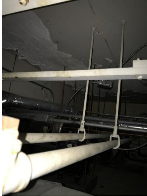
Photo 1 : Salle B-48, plâtre en mauvais état et débris au-dessus des carreaux de plafond
