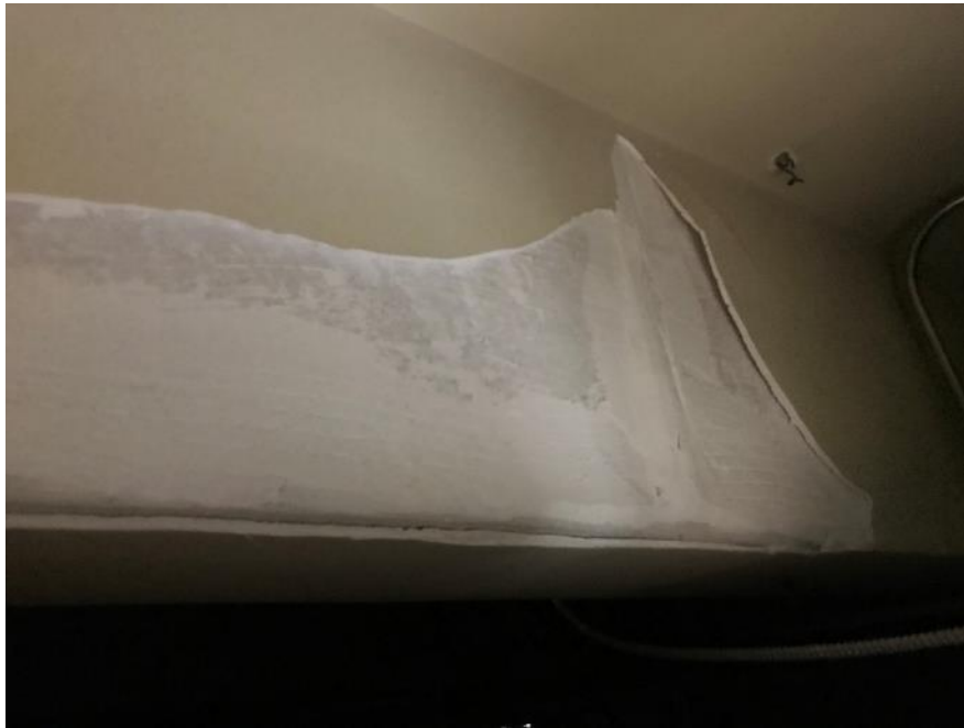
Photo 31 : Salle 1120, plâtre du plafond en mauvais état au-dessus du plâtre du plafond
