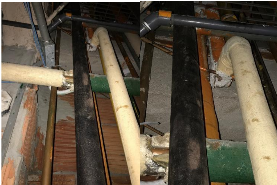
Photos 43 et 44 : Châsse 2043-2045, raccords de tuyauterie et calorifuge à alvéoles d'air en mauvais état
