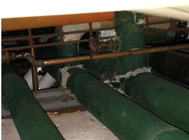
Photo 36 : Châsse 2018-2020, raccords de tuyauterie en mauvais état
