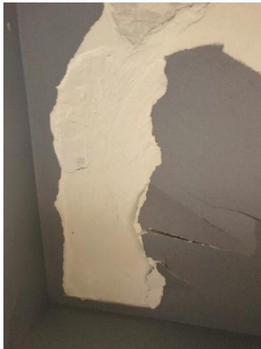
Photo 48 : Salle 2067, plâtre du plafond en mauvais état et débris de plâtre reposant sur les carreaux de plafond et au-dessus de ceux-ci
