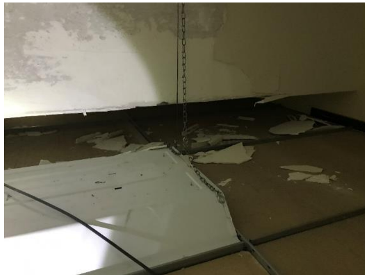
Photo 77 : Salle 4091, plâtre du plafond en mauvais état et débris de plâtre reposant sur les carreaux de plafond et les appareils d'éclairage et au-dessus de ceux-ci
