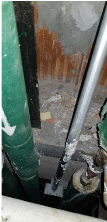
Photo 68 : Châsse 4002-4004, calorifuge de tuyau à alvéoles d'air en mauvais état et débris
