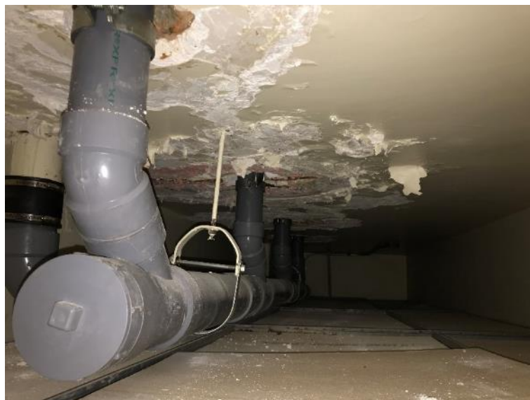
Photo 51 : Salle 2090, plâtre du plafond en mauvais état et débris de plâtre reposant sur les carreaux de plafond et au-dessus de ceux-ci
