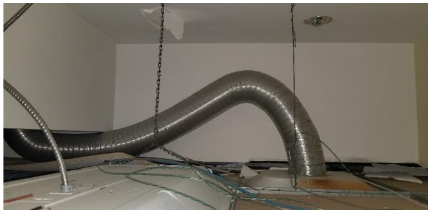
Photo 81 : Salle 4107, plâtre du plafond en mauvais état et débris de plâtre reposant sur les carreaux de plafond et au-dessus de ceux-ci
