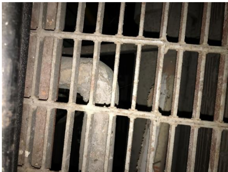
Photo 34 : Châsse 2001-cage d'escalier, raccords de tuyauterie en mauvais état sous le caillebotis de plancher
