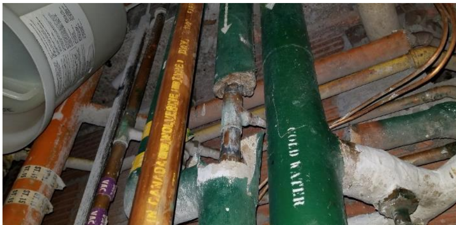
Photo 73 : Châsse 4037-4039, raccord de tuyauterie et calorifuge à alvéoles d'air en mauvais état
