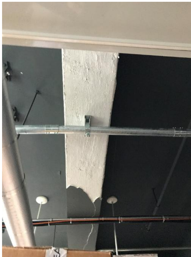
Photo 13 : Salle B87, plâtre du plafond en mauvais état
