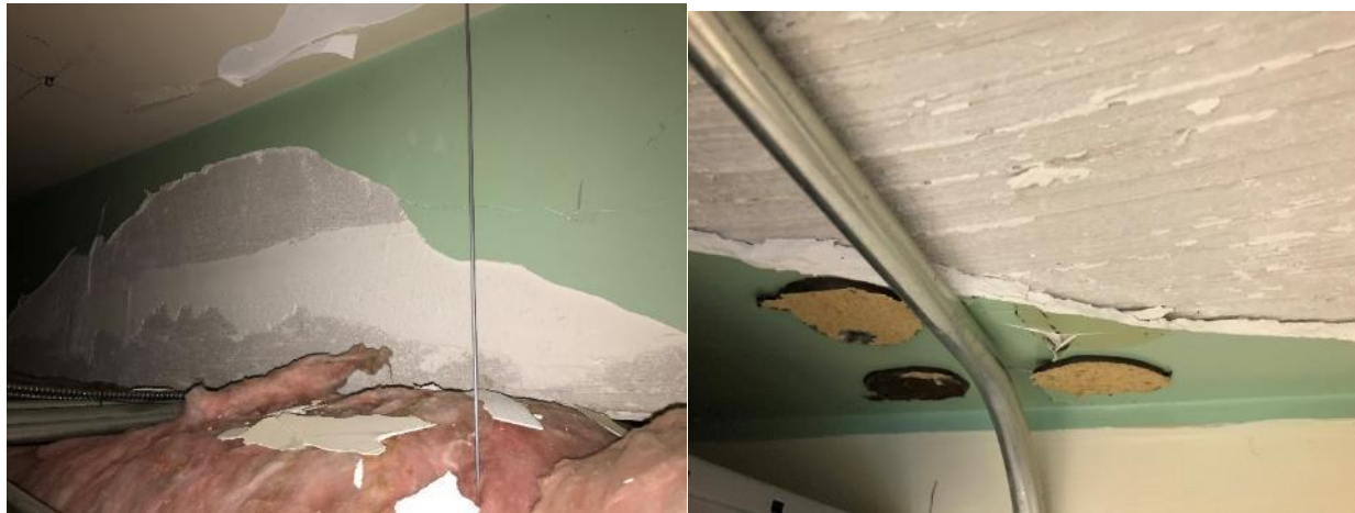
Photos 24 et 25 : Salle 1079, plâtre du plafond en mauvais état et débris de plâtre
