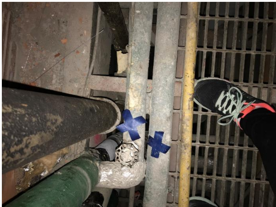
Photo 17 : Châsse 1022-1024, raccords de tuyauterie et calorifuge à alvéoles d'air en mauvais état
