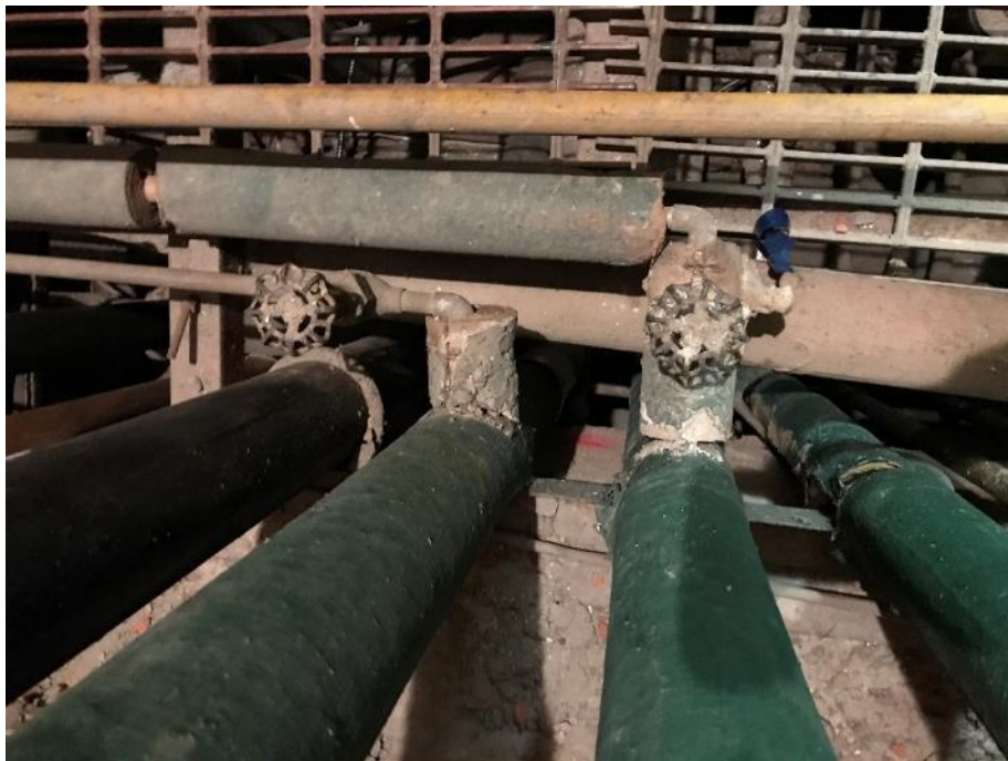
Photo 15 : Châsse 1020-1022, raccords de tuyauterie en mauvais état et débris
