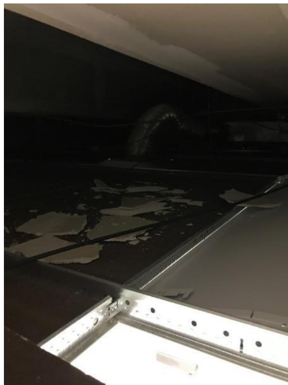
Photo 55 : Salle 2130, plâtre du plafond en mauvais état et débris de plâtre reposant sur les carreaux de plafond et au-dessus de ceux-ci
