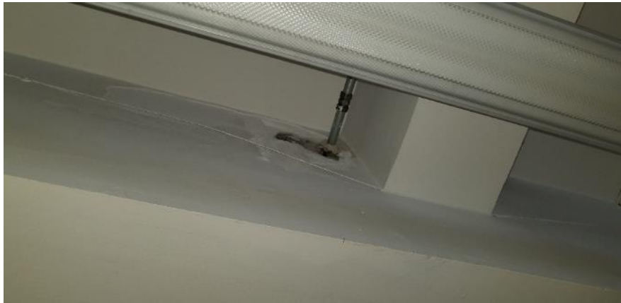
Photo 60 : Salle 3121-311A, plâtre mural en mauvais état au niveau du plafond
