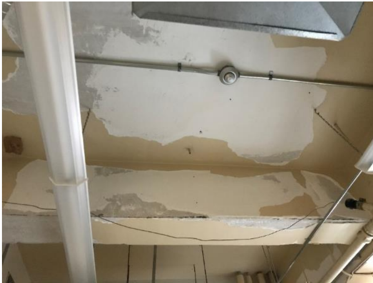
Photo 22 : Salle 1065A, plâtre du plafond en mauvais état
