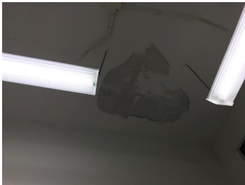
Photo 23 : Salle 1065B, plâtre du plafond en mauvais état
