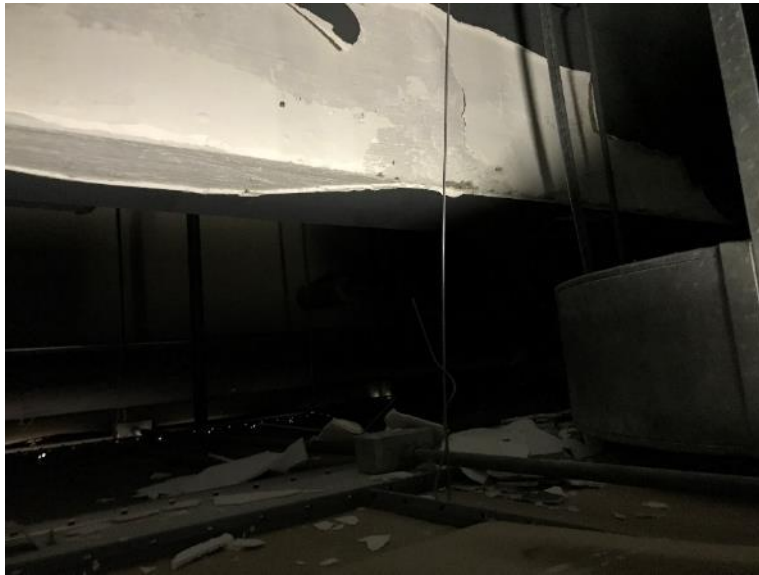
Photo 8 : Salles B71 et B71A, plâtre en mauvais état et débris reposant sur les carreaux de plafond et au-dessus de ceux-ci
